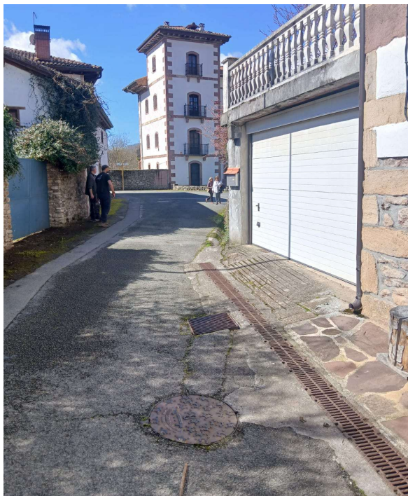
Punto de vertido de aguas pluviales a aguas fecales.
