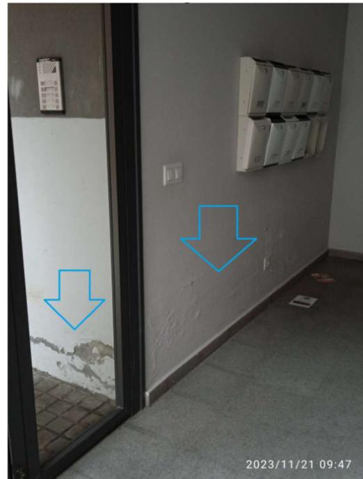
Daños en interior portal 24
