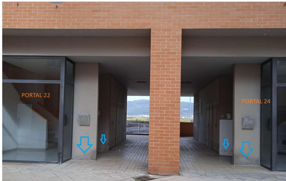
Foto: Daños en accesos portales 22 y 24 desde porche
