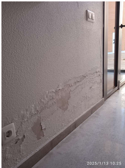
Daños en interior portal 22
