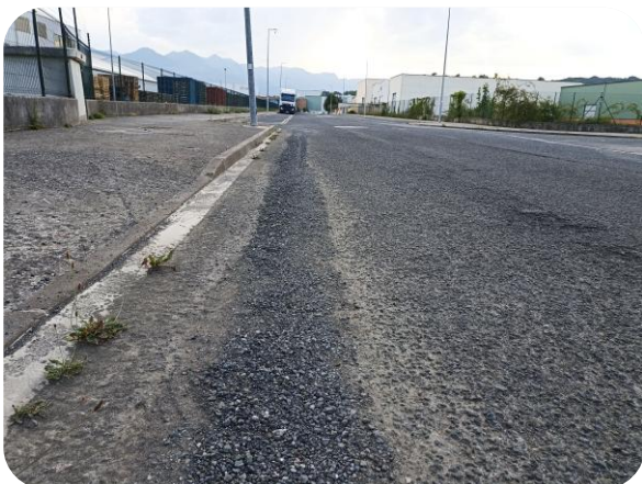
F6 Disgregación y gravilla: acumulación borde calzada
