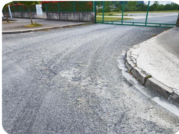
F13 Pérdida rodadura y disgregación acceso parcela
