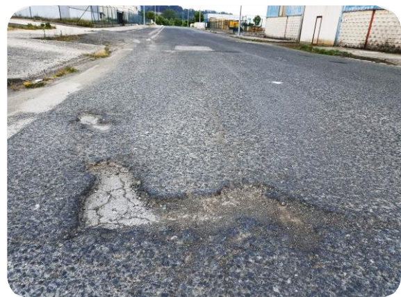
F5 Pérdida rodadura y base en las zonas más afectadas
