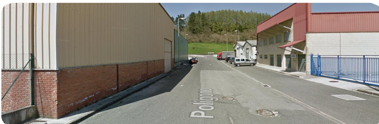
Ejemplos de sección tipo de calzada central y aparcamientos en línea o batería laterales, y problemáticas actuales del pavimento.
