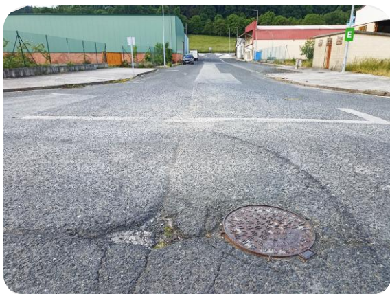
F4 Pérdida rodadura y fisuración
