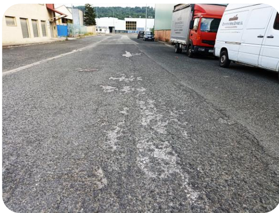
F2 Pérdida rodadura asfáltica
