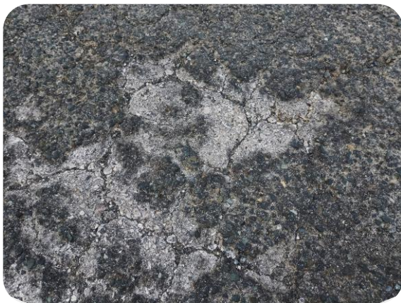
F4 Pérdida rodadura asfáltica
