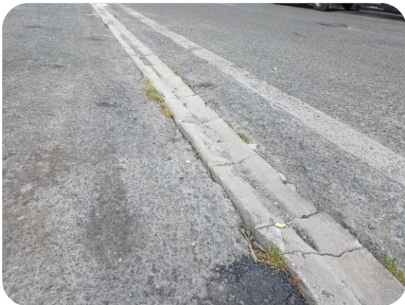
F10 Descalce de zona de caz por Pérdidas asfalto.
