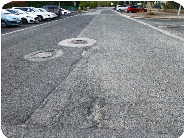
F12 Pérdida rodadura asfáltica
