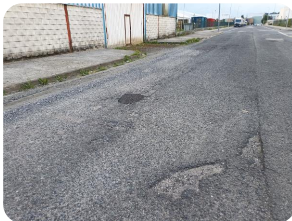
F7 Pérdida rodadura y base en las zonas más afectadas
