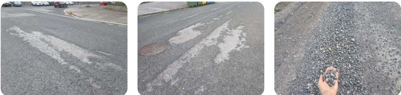
F1 Ejemplos de patologías del firme de aglomerado asfáltico con 20 años antigüedad de la Fase 1 y Fase 2 del P.I. de Lekunberri
