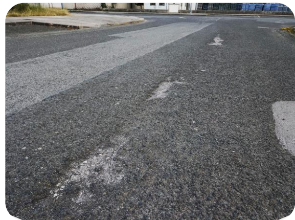
F4 Pérdida rodadura a lo largo eje pisada
