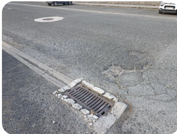
F11 Afección tipo de sumidero por vehículos/antigüedad
