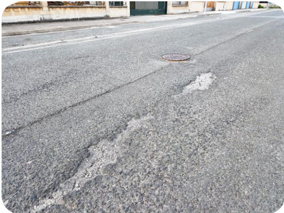
F8 Pérdida rodadura asfáltica
