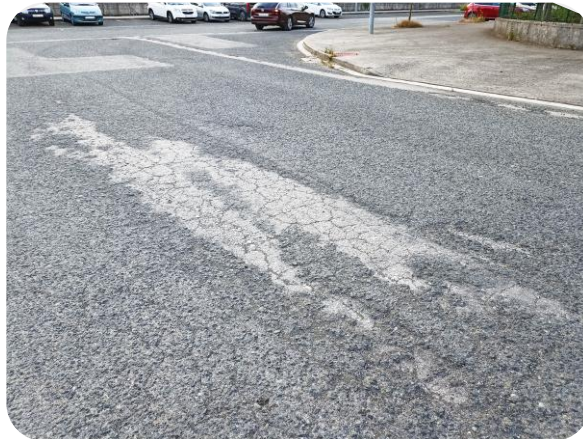
F9 Pérdida rodadura y fisuración base asfáltica
