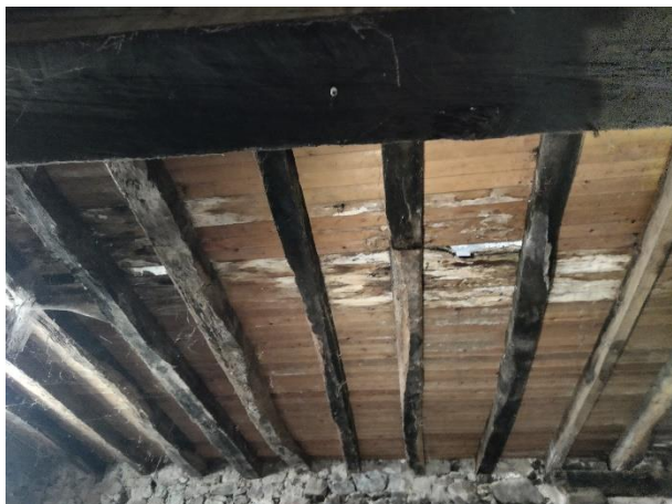
Fig 2.9 Estado de uno de los forjados
