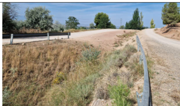
Imagen 3_Vista aguas arriba desde el puente, se aprecia cierto estrechamiento de la sección.
