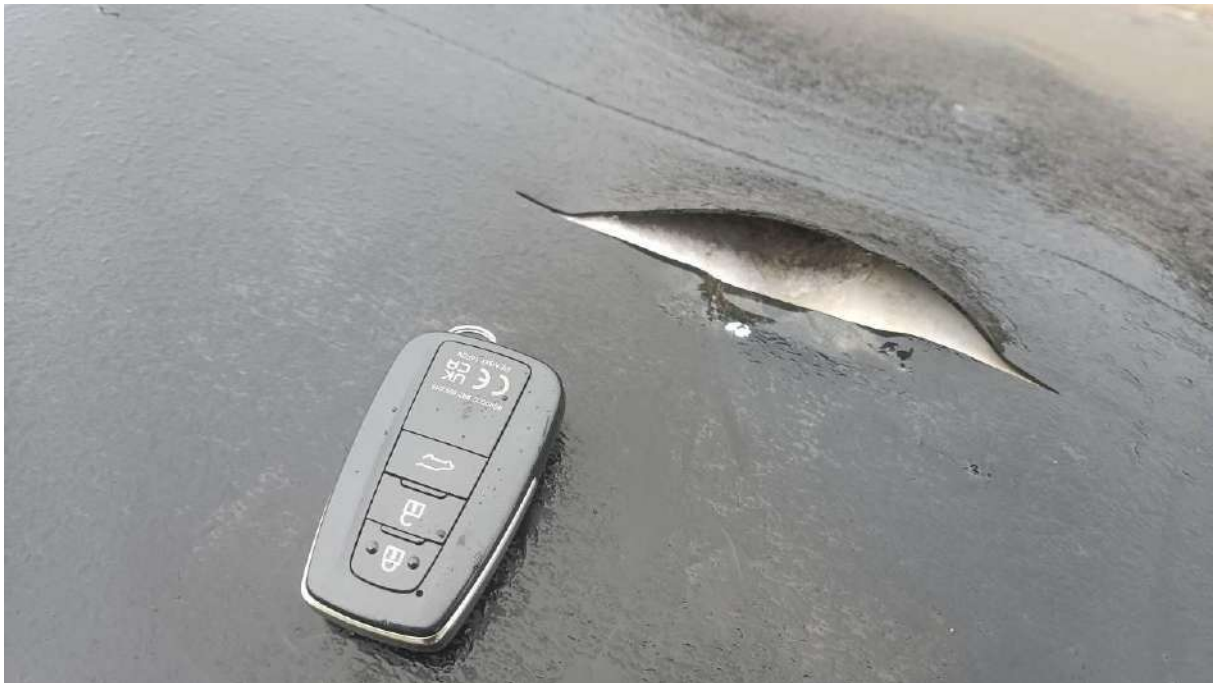
Foto 5: Roturas en material actual en otoño 2025, TPO
