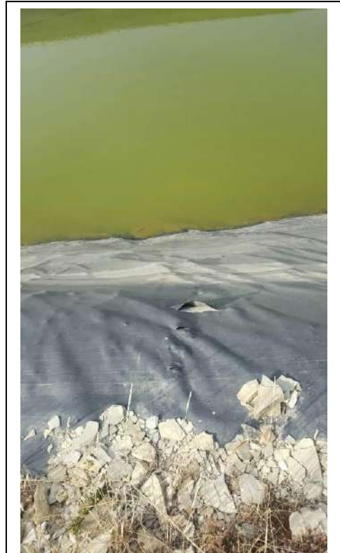
Foto 5: Daños en balsa del año 2016, reparadas por REVIMPE. Foto cedida
