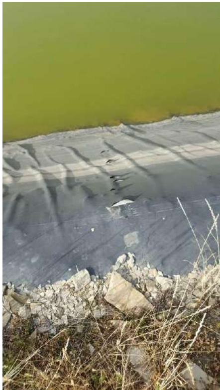
Foto 5: Daños en balsa del año 2016, reparadas por REVIMPE. Foto cedida
