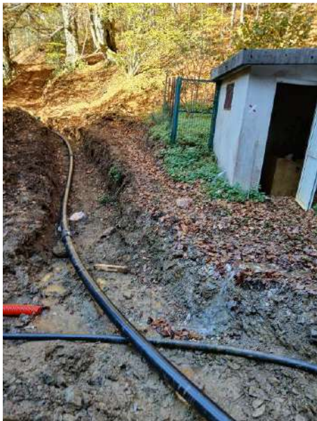
Figura 4: Tubería desde Fuente Fría
