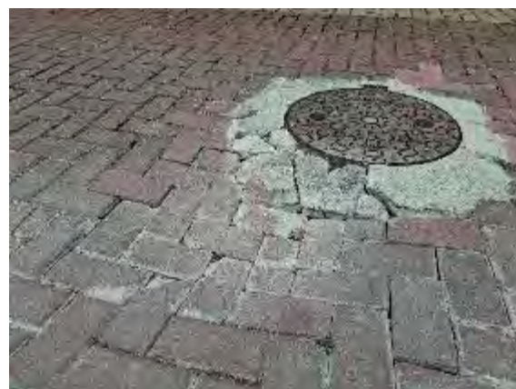
Recercos de hormigón fracturados.
