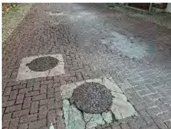
Recercos de hormigón fracturados.
