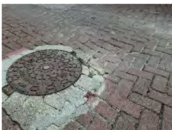
Recercos de hormigón fracturados.
