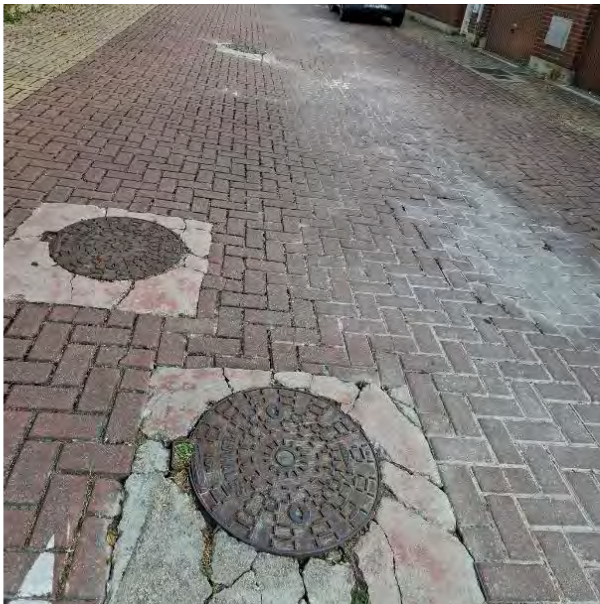
Recercos de hormigón fracturados, pavimentos hundidos, adoquines rotos...
