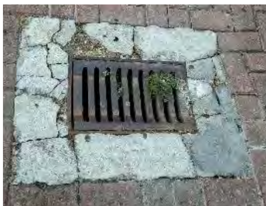
Recercos de hormigón fracturados.
