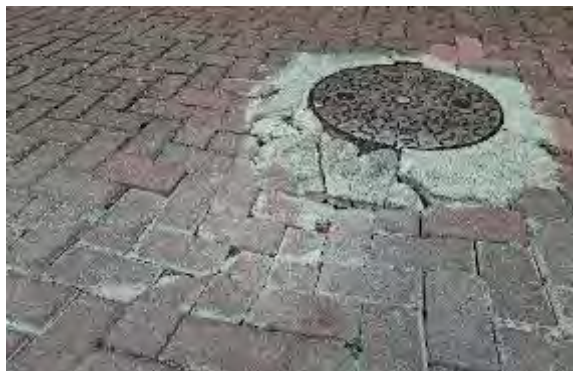
Encintados de hormigón fracturados y hundidos.
