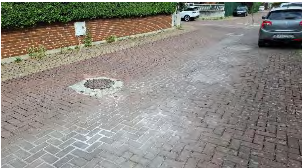
Tramo central: se observan hundimientos de pavimento y roturas de los encintados de hormigón.
