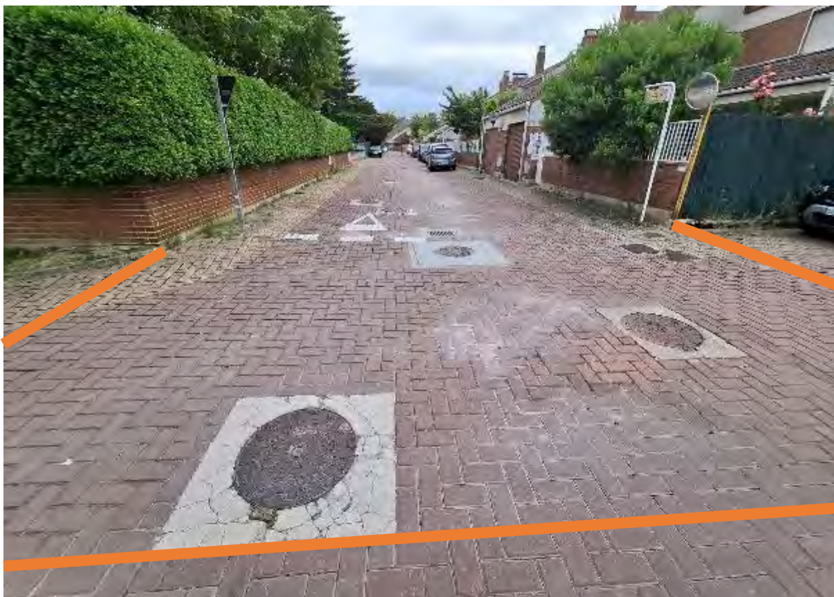
Inicio de la calle en su enlace con el camino Alchuchate. La actuación se extiende hasta el eje del citado camino, para corregir los hundimientos en el pavimento y los encintados de las tapas fragmentados.
