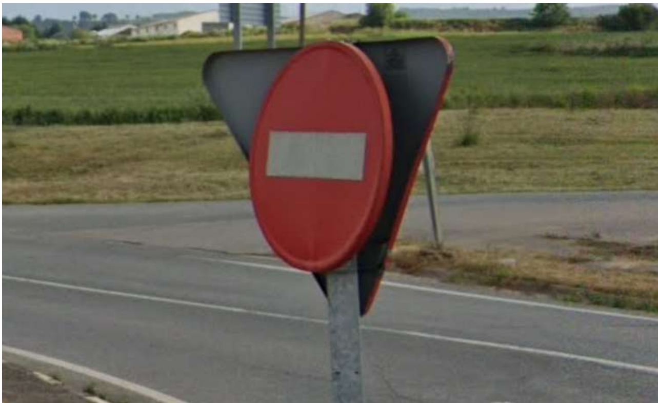
- señal de dirección prohibida, desgastada y encorvada -
