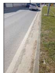
franja hidráulica de drenaje que desemboca en cuneta
