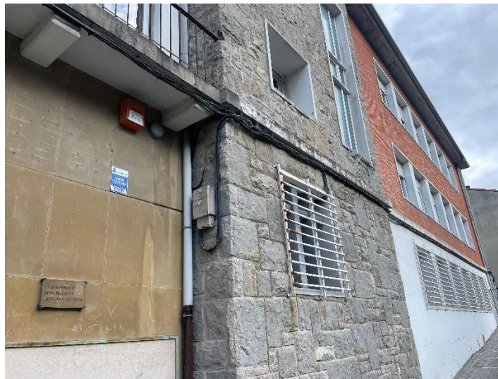
Caja general de protección
