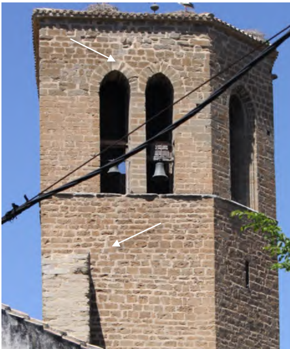
Grieta reparada en la hoja exterior del cerramiento sur de la torre.
