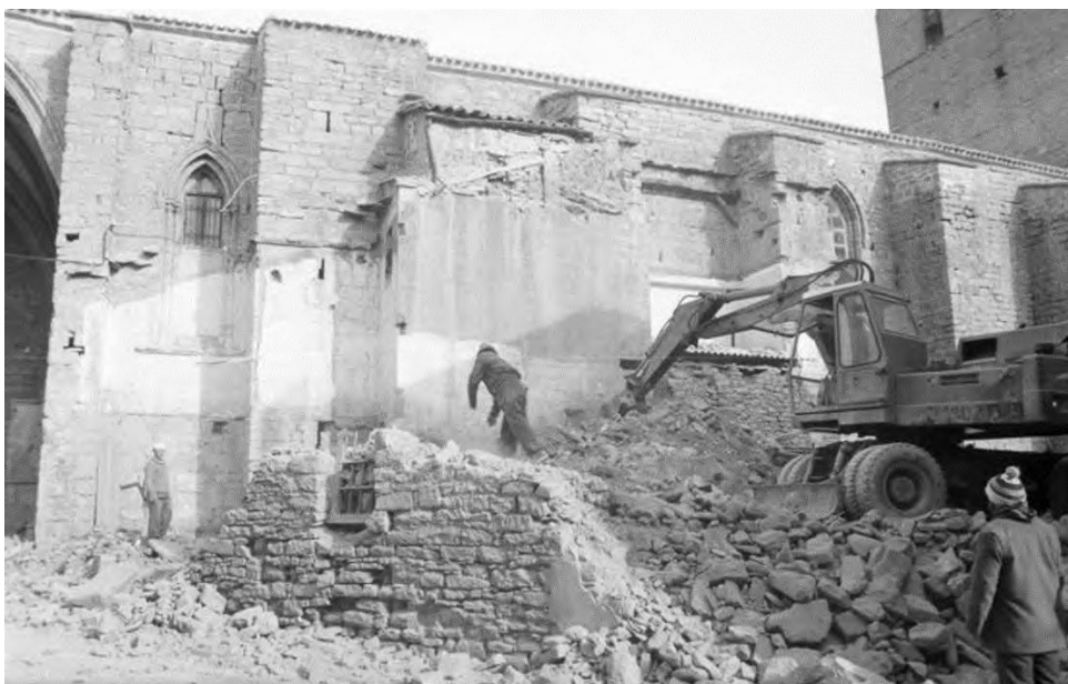
Fotografía tomada durante la demolición de las viviendas particulares adosadas al muro sur de la nave
