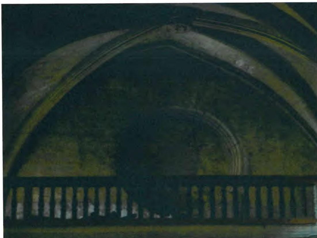
Figura 12: La deformación de la fachada oeste vista desde el interior del templo. La asimetría de esfuerzos es clave para entender las deformaciones.
