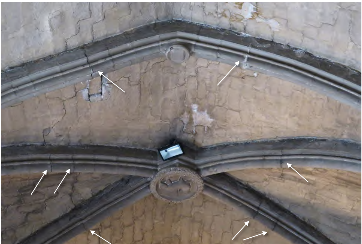
Fisuras generalizadas en el intradós de las bóvedas, con desprendimientos puntuales de revestimiento y material de las juntas, y rótulas en los nervios, próximas a las claves.
