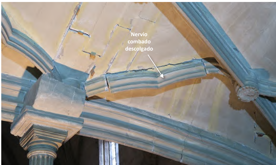
Lesiones en la zona de la bóveda próxima al puntal colocado en la clave de la bóveda
