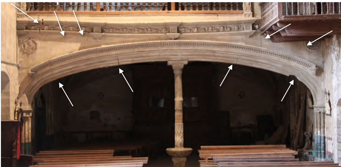
Lesiones en el arco carpanel que da a la nave
