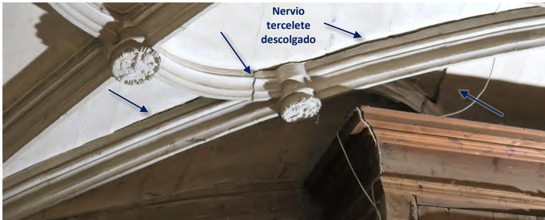
Lesiones en la zona de la bóveda próxima al hastial oeste
