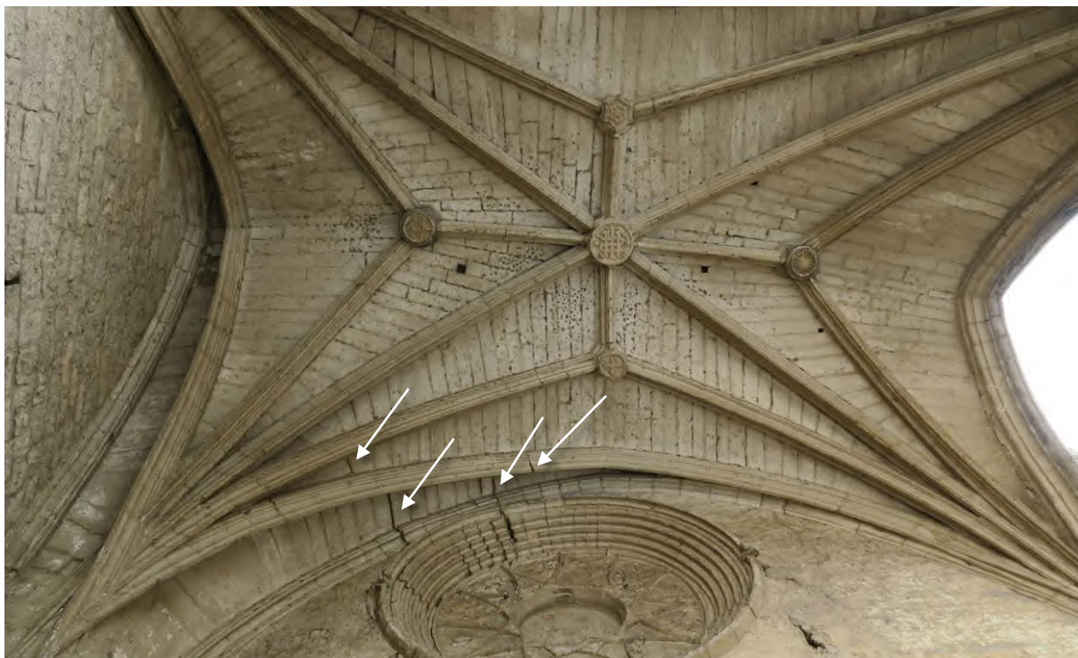
Estado actual de la bóveda del atrio
