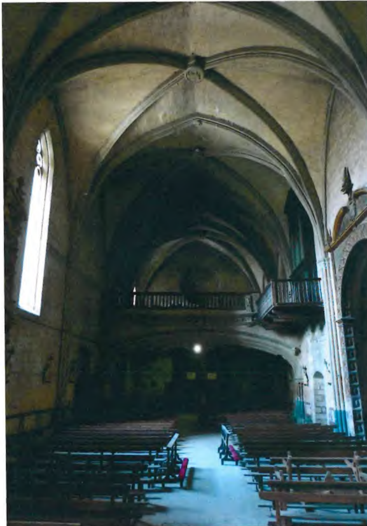
Figura 13: En la iglesia de El Salvador se pueden ver en el interior varias actuaciones con diferentes materiales de otras tantas épocas. Así, se aconsejan otros tipos de investigación más específicos como los referentes a cada problema estructural determinado, o a cada material constructivo en particular.
