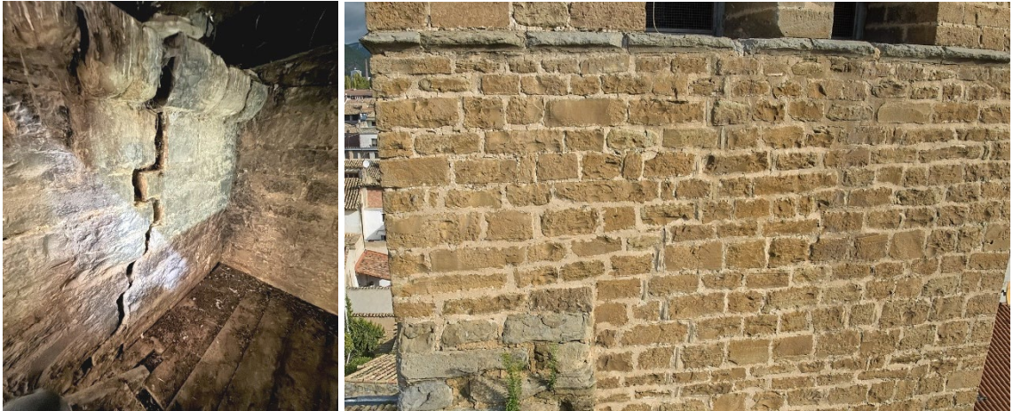
Grieta en el interior. En el exterior se percibe el retacado y rejuntado de los 90
