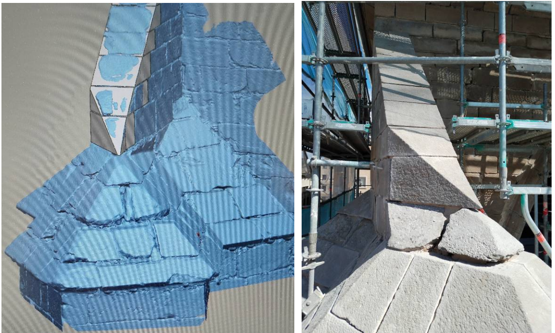
Escaneado y modelado para la reposición del remate de la parte superior del estribo exento del atrio
