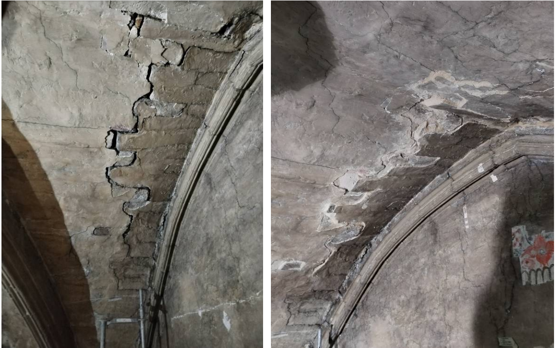
Relleno y sellado de la grieta abierta en la plementería de la bóveda del tramo de los pies, antes y después
