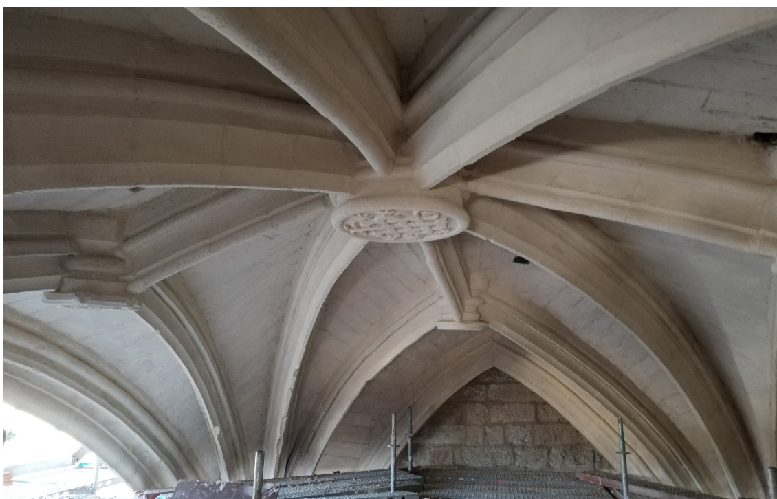
Arriba a la izquierda, detalle del estado en el que se encontraba la bóveda. En uno de los sillares de uno de los nervios se puede apreciar una de las primeras pruebas de veladura realizada durante las obras. Arriba a la derecha, muestra de las mallas antiaves colocadas. Abajo, vista de la bóveda una vez aplicado el nuevo revestimiento
