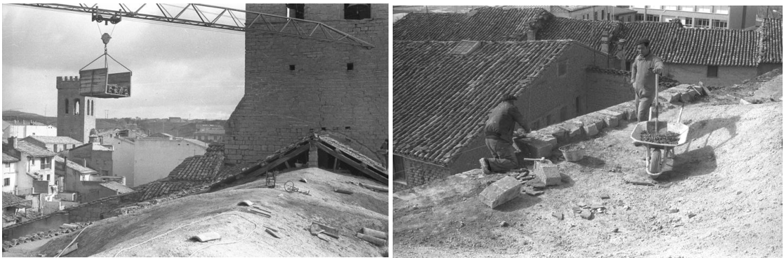
Año 1978. Obras de rehabilitación de la cubierta. Realizada parcialmente la losa de h.a. sobre las bóvedas. Comienza la instalación de la cornisa de piedra
