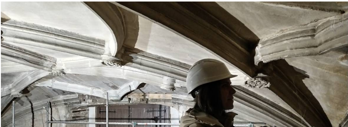
Arriba, ejemplo de nervio combado descolgado y de grietas en los nervios y en la plementería. En el medio, apeos empleados durante el proceso de consolidación. Abajo, detalle de la bóveda una vez consolidada
