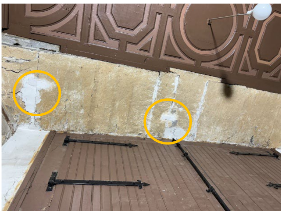
28 de octubre de 2024. Testigos de yeso Puerta oeste
