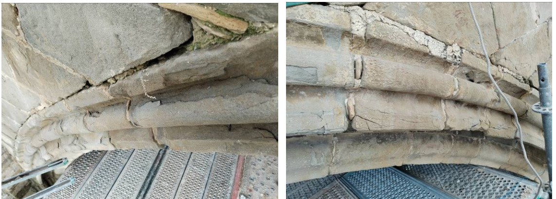
Detalle de fisuras y deplacaciones en los sillares moldurados que conforman el arco occidental del atrio
