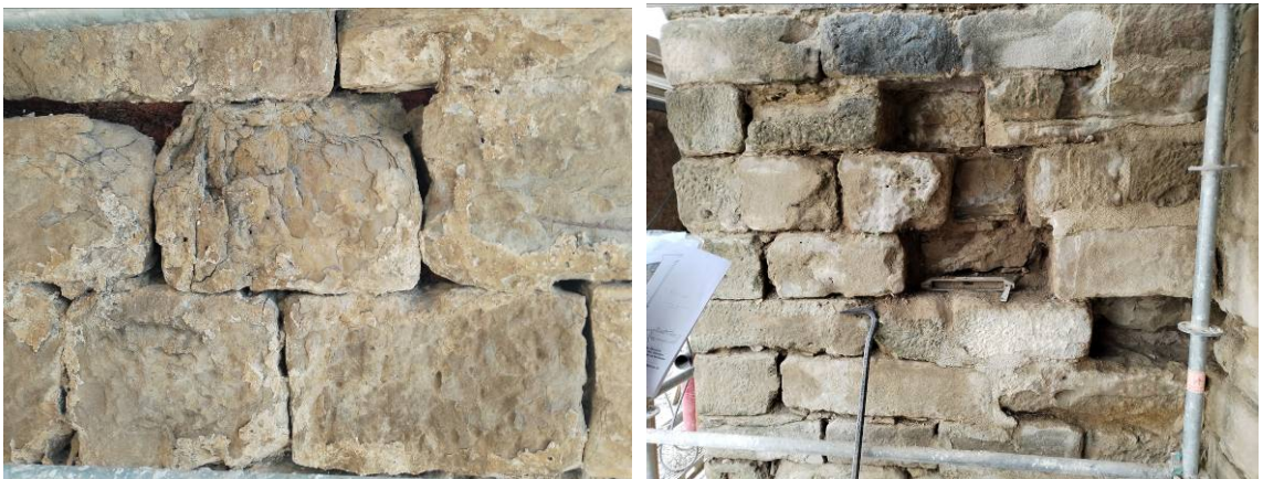
Ejemplos de sillares con una pérdida acusada de material y cajeos puntuales en los muros y contrafuertes para su reposición
