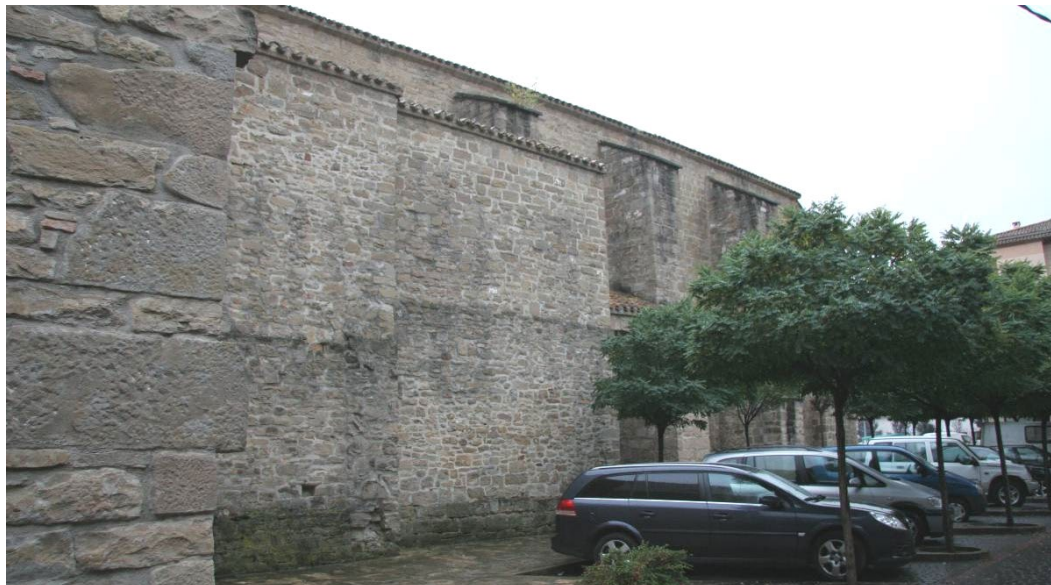
Fachada norte del edificio, en la que se distinguen los muros septentrionales de las capillas
