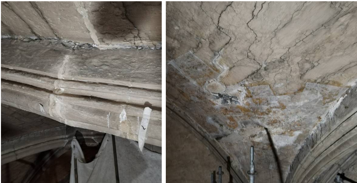
Izquierda, ejemplo de acuñado y sellado de grieta en nervio. Derecha, fijación de emergencia del revestimiento pictórico en parte de la plementería sur de la bóveda de los pies de la nave para evitar su desprendimiento
