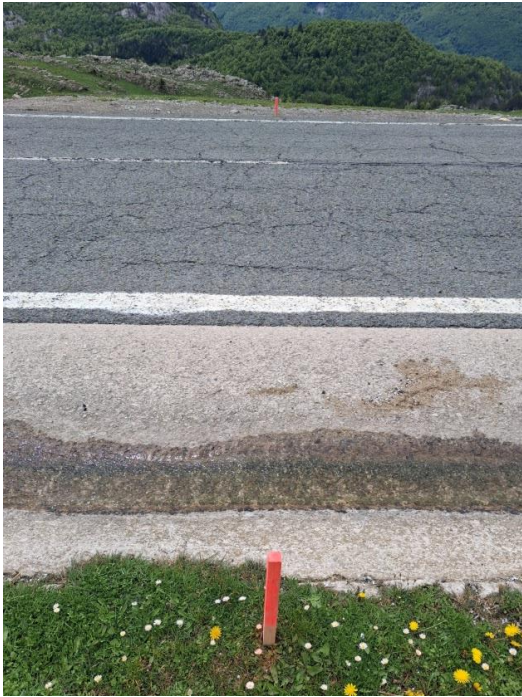
Localización prevista zanja por la que discurre la tubería para atravesar la carretera.
