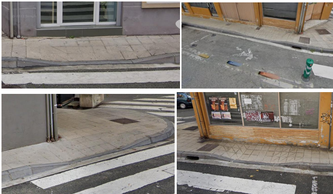
Figura 8. Rampas de accesibilidad ESTADO ACTUAL.
