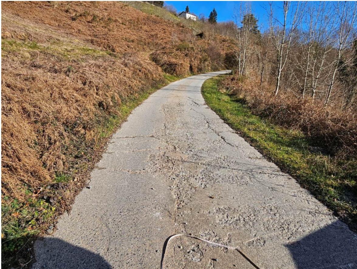
Fotografía donde se aprecia el mal estado del pavimento a acondicionar en Urrutiña5
