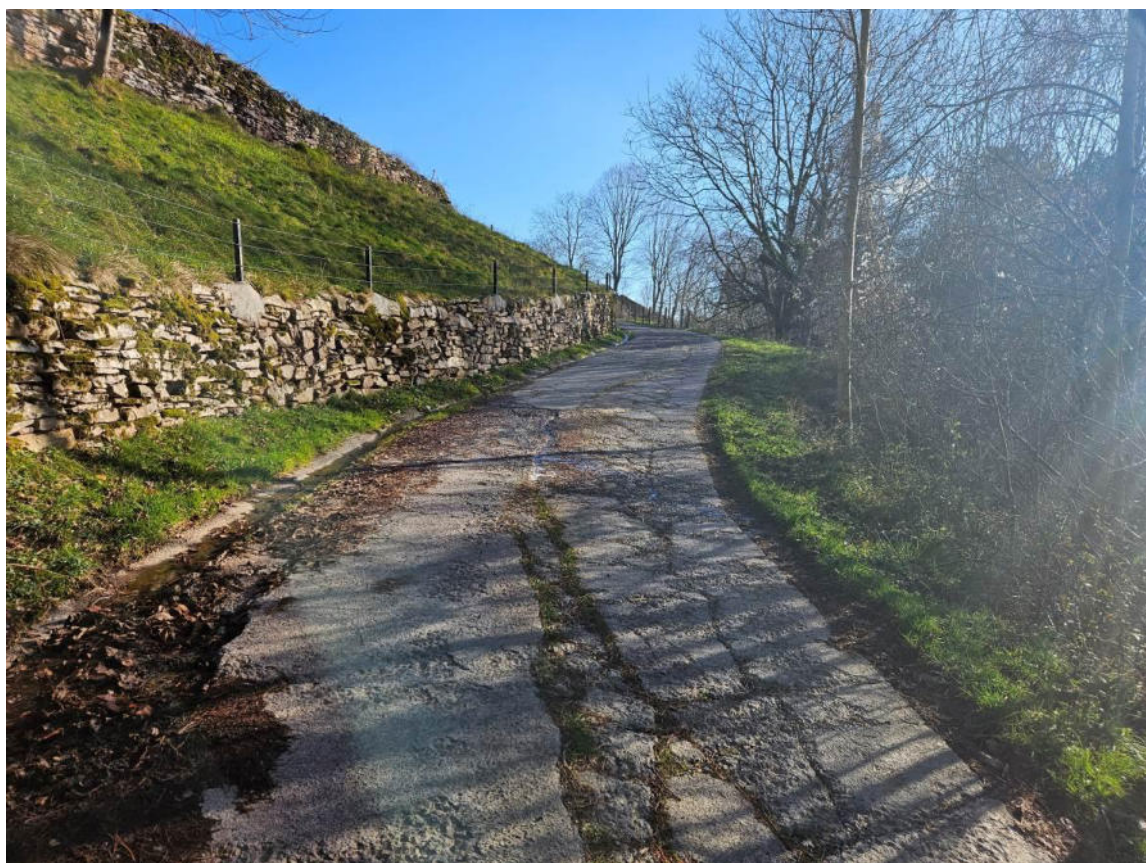
Fotografía donde se aprecia el mal estado del pavimento a acondicionar en Urrutiña2
