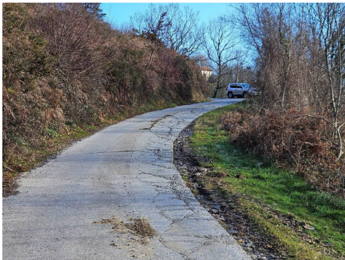
Fotografía donde se aprecia el mal estado del pavimento a acondicionar en Urrutiña4
