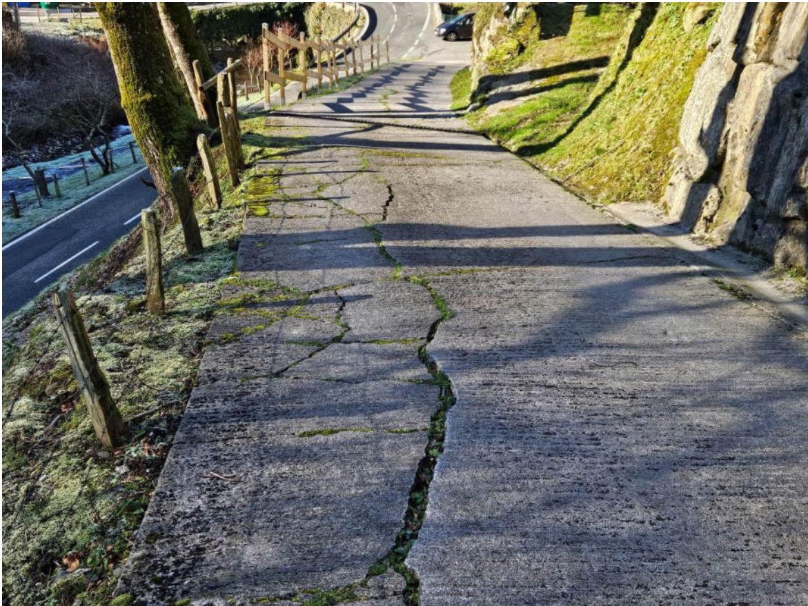
Fotografía donde se aprecia el mal estado del pavimento a acondicionar en Urrutiña9
