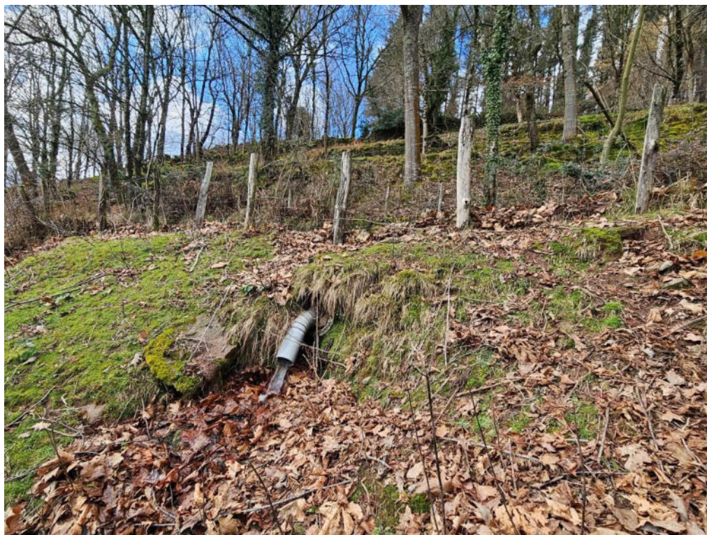
Fotografía del caño roto a sustituir en Urrutiña8
