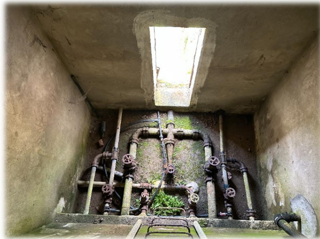
Fotografía 4 – Vista desde arriba de la valvulería a renovar.
