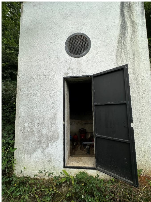
Fotografía 1 – Vista exterior de la cámara de llaves.
