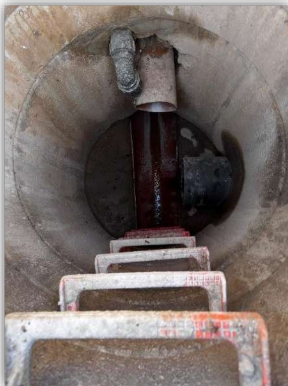
Fotografía 16 – Pozo de existente
