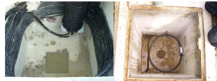
Detalle de arqueta de registro con reserva de cable
