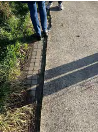
FOTO 2: Desnivel entre el pavimento continuo de hormigón y el pavimento adoquinado
