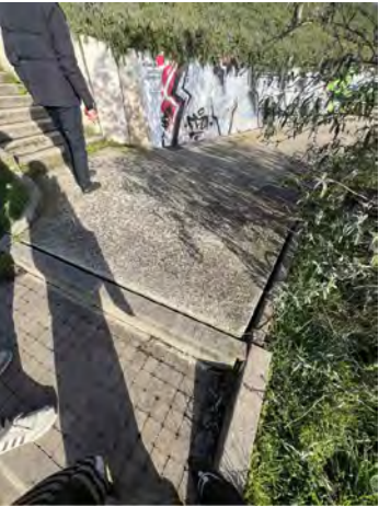
FOTO 16: Desplome de los bordillos entre pavimentos y jardín.
