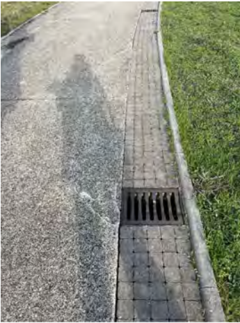
FOTO 13: Rotura del pavimento en el encuentro con las rejillas de sumideros
