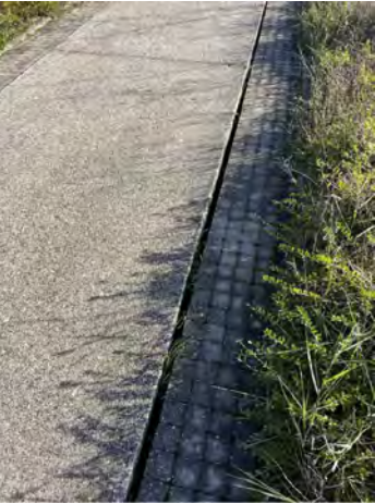
FOTO 20: Detalle del desnivel entre el pavimento continuo de hormigón y el pavimento adoquinado
