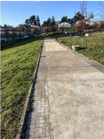
FOTO 5: Existencia de rebabas en zona recientemente reparada
