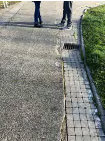
FOTO 8: Rotura del pavimento continuo en los extremos por el desnivel existente
