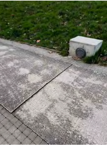
FOTO 12: Presencia de ceja en losa de hormigón.
