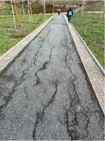
FOTO 24: Aparición de fisuras y grietas en pavimento asfaltado
