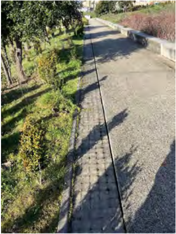
FOTO 19: Detalle del desnivel entre el pavimento continuo de hormigón y el pavimento adoquinado
