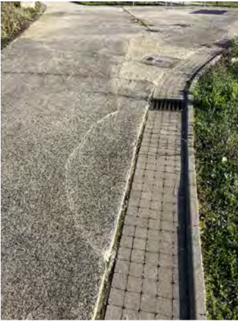
FOTO 10: Detalle del desnivel entre el pavimento continuo de hormigón y el pavimento adoquinado
