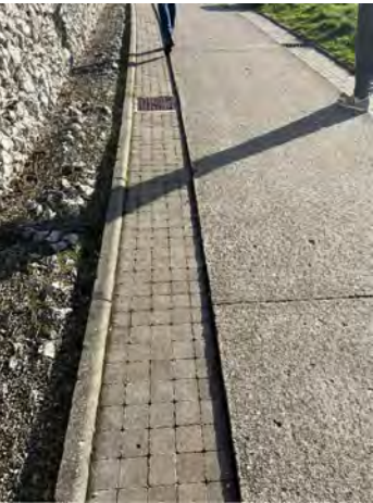
FOTO 7: Detalle de las rebabas entre el pavimento continuo y el adoquinado de los bordes
