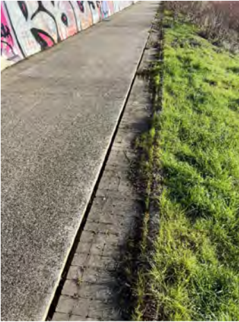
FOTO 18: Detalle del desnivel entre el pavimento continuo de hormigón y el pavimento adoquinado
