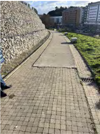
FOTO 6: Existencia de rebabas en zona recientemente reparada
