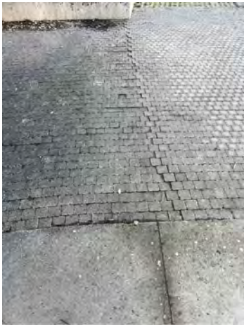
FOTO 1: Asiento diferencial del pavimento adoquinado produciendo una apertura lineal en el rejuntado
