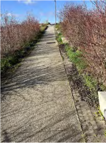
FOTO 21: Hundimiento de la losa en tramo peatonal
