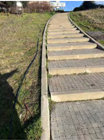
FOTO 4: Desplome de bordillos respecto a su posición original
