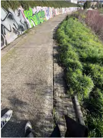
FOTO 17: Abertura de la junta entre pavimento continuo de hormigón y el pavimento adoquinado
