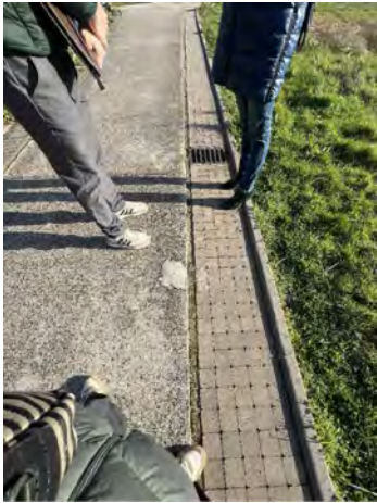
FOTO 9: Detalle del desnivel entre el pavimento continuo de hormigón y el pavimento adoquinado
