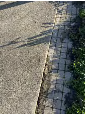
FOTO 3: Desnivel entre el pavimento continuo de hormigón y el pavimento adoquinado
