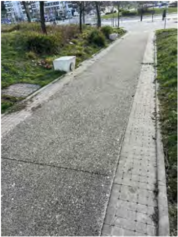
FOTO 11: Rebabas y roturas parciales en pavimento continuo
