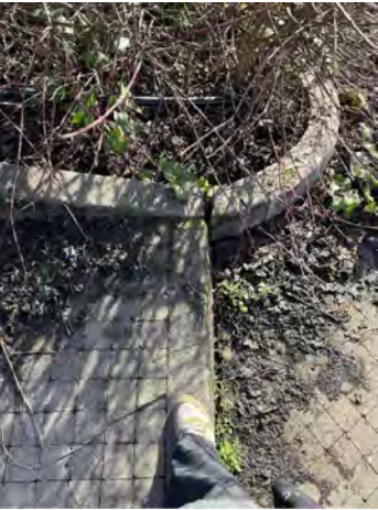
FOTO 15: Desplome / rotura de los bordillos
