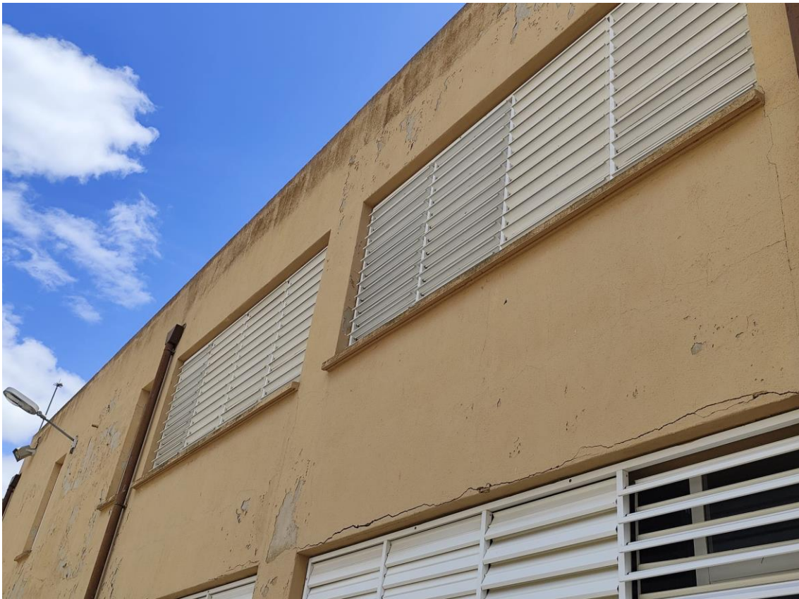
Desconches en pintura y grietas en dinteles
