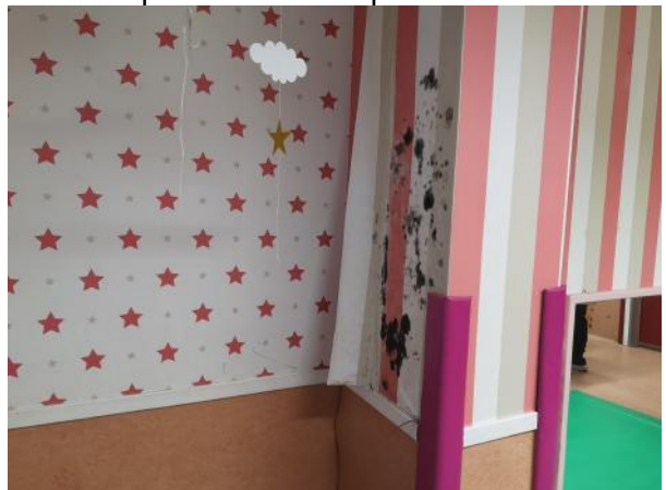
Desperfectos en fachada sur
