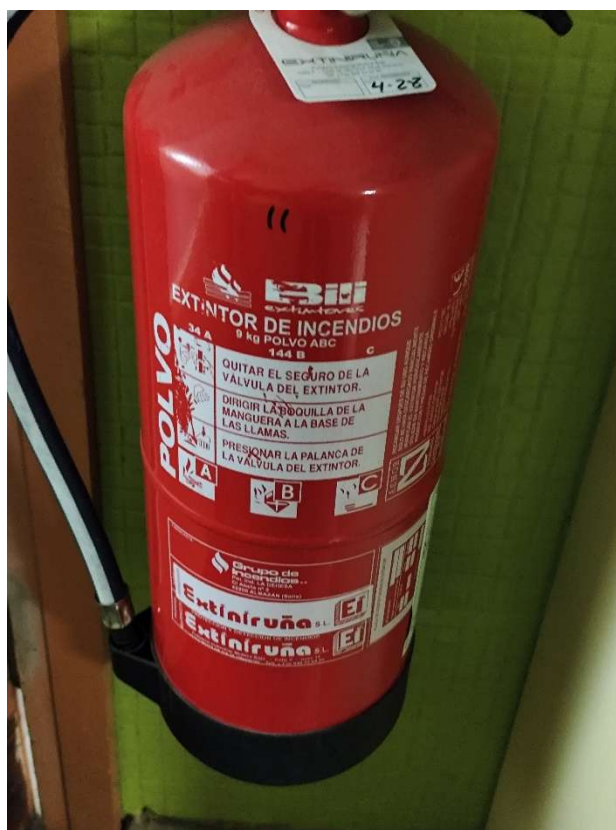
FOTO 53 – Extintores de incendios insuficientes.
