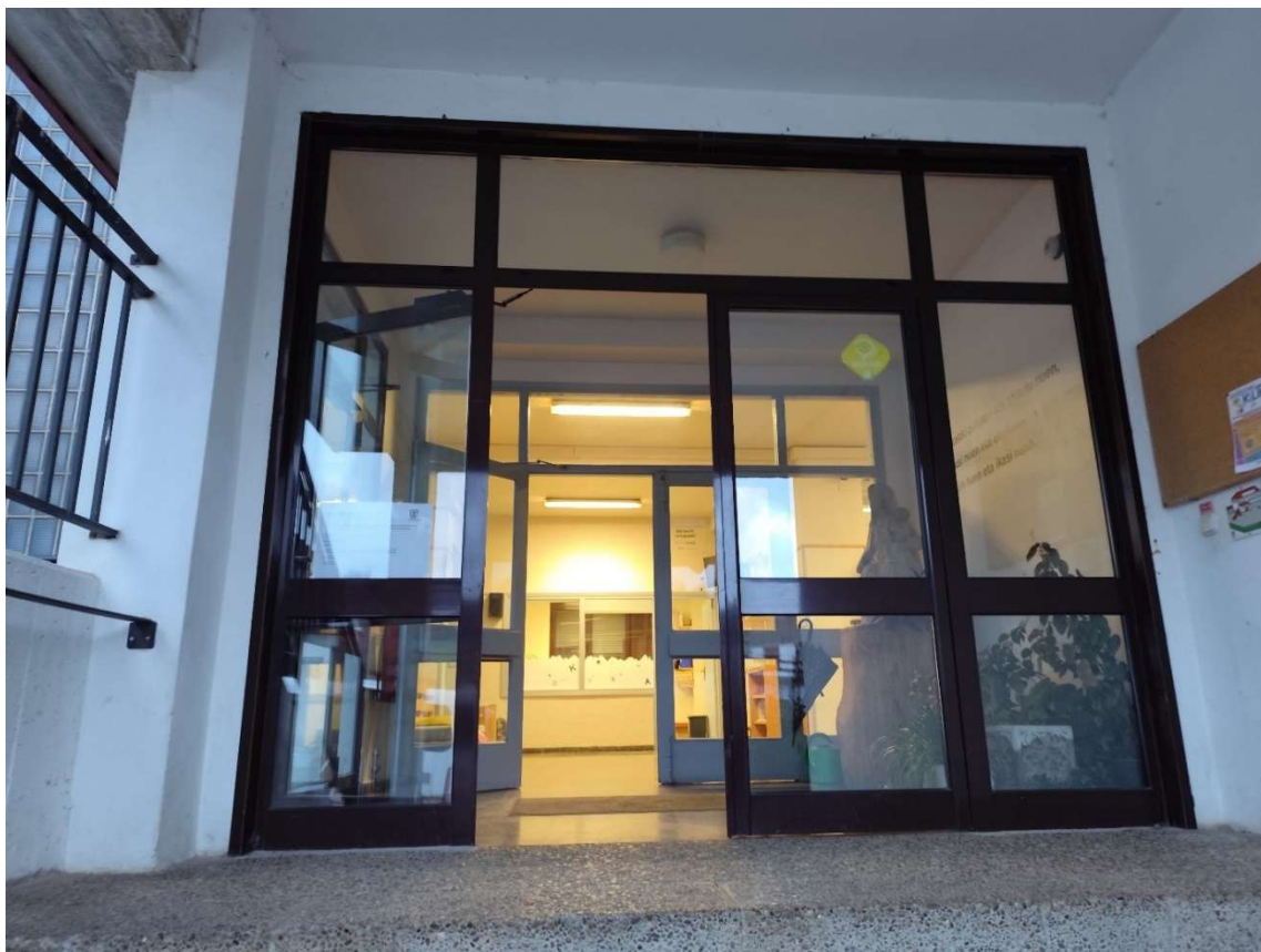
FOTOS 59 – Detalle Carpinterías Actuales en aluminio.
