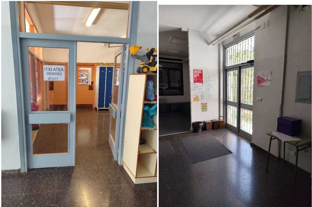
FOTO 47 y 48 – Apertura de puertas en recorridos de evacuación, situación de luminarias de emergencia a cambiar.
