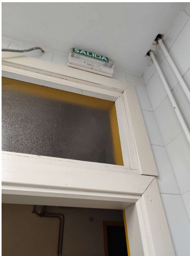
FOTO 52 – Luminarias de emergencia colocadas muy altas, algunas incluso con cableado inservible.
