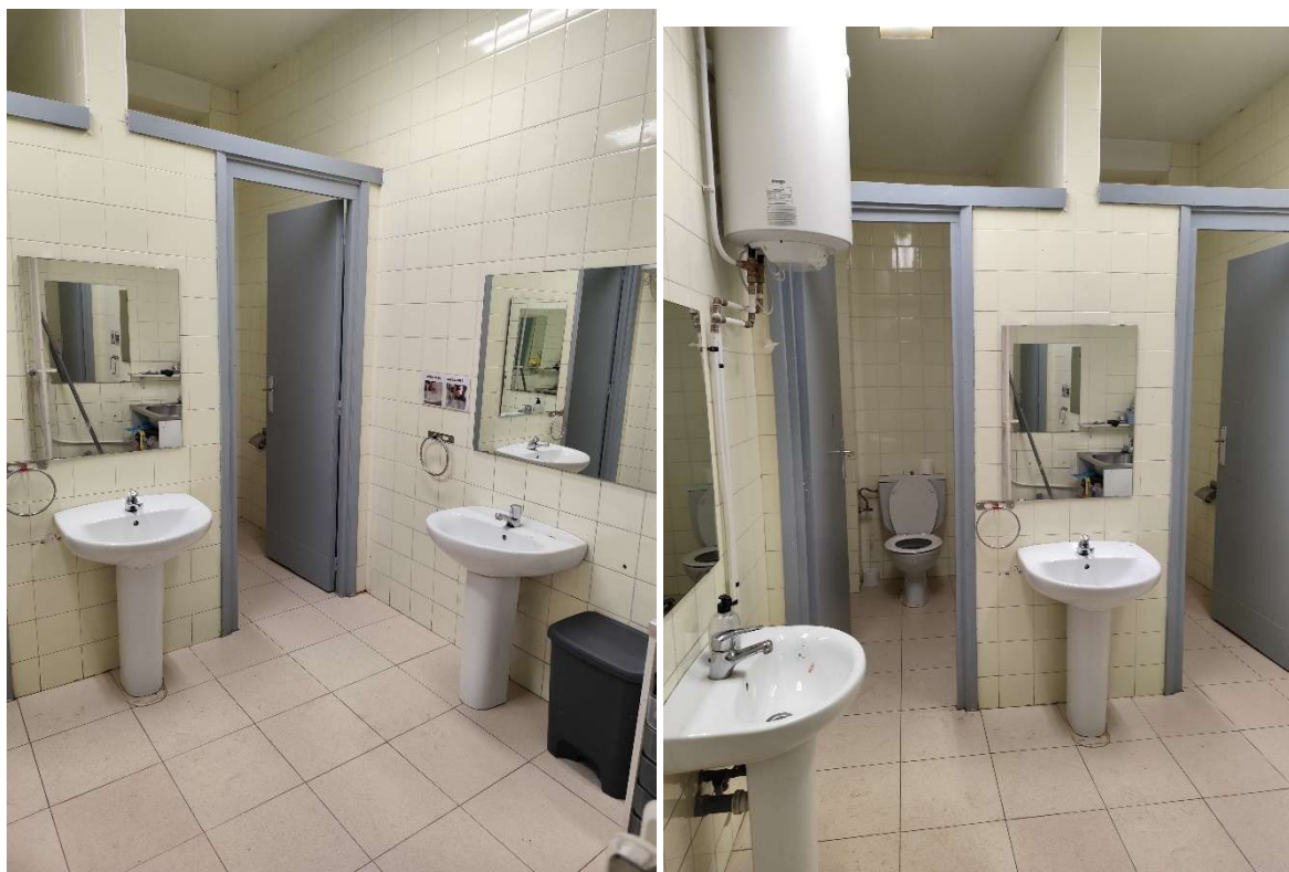
FOTO 14 y 15- Pavimentos a sustituir por un suelo antideslizante.
