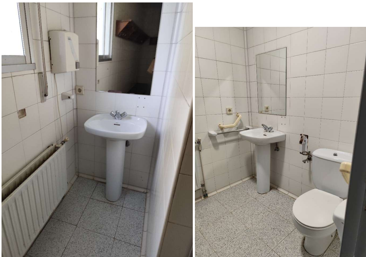
FOTO 08 y 09- Pavimentos a sustituir por un suelo antideslizante.
