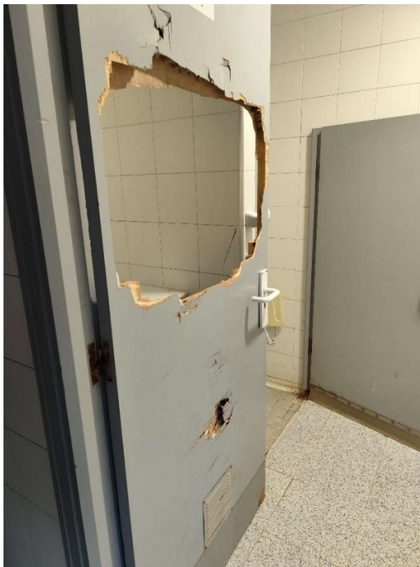
FOTO 11- Carpinterías en habitaciones y duchas a Sustituir.
