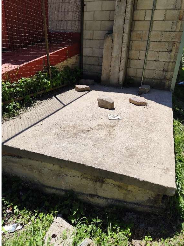
FOTO 39 – Solera de hormigón, techo de sala de calderas, sin impermeabilización.
