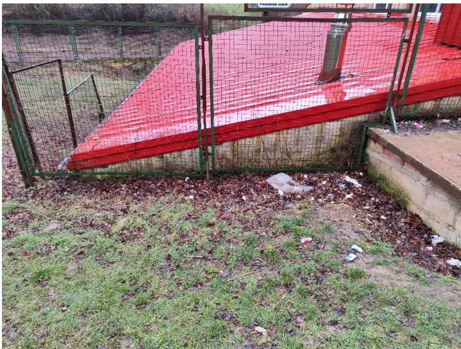
FOTO 44 – Desperfectos Techo Sala de Calderas y vestuarios.
