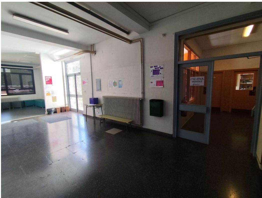
FOTO 49 – Apertura de puertas en recorridos de evacuación, situación de luminarias de emergencia a cambiar.
