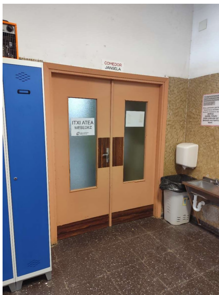
FOTO 54 – Puerta acceso a comedor, sentido de apertura a modificar.
