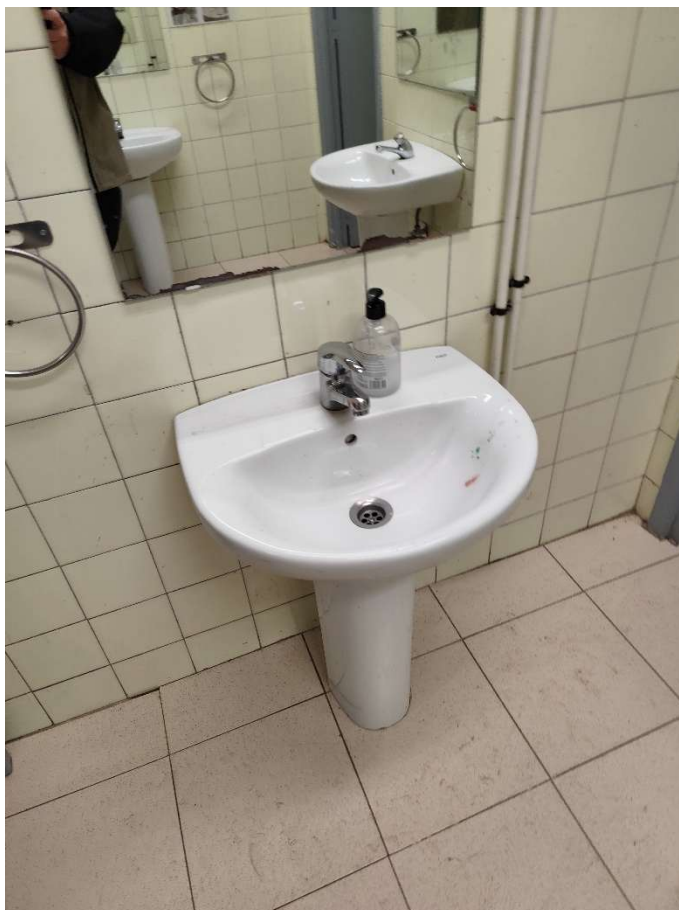
FOTO 17- Lavabos que no funcionan, espejos rotos y cortantes
