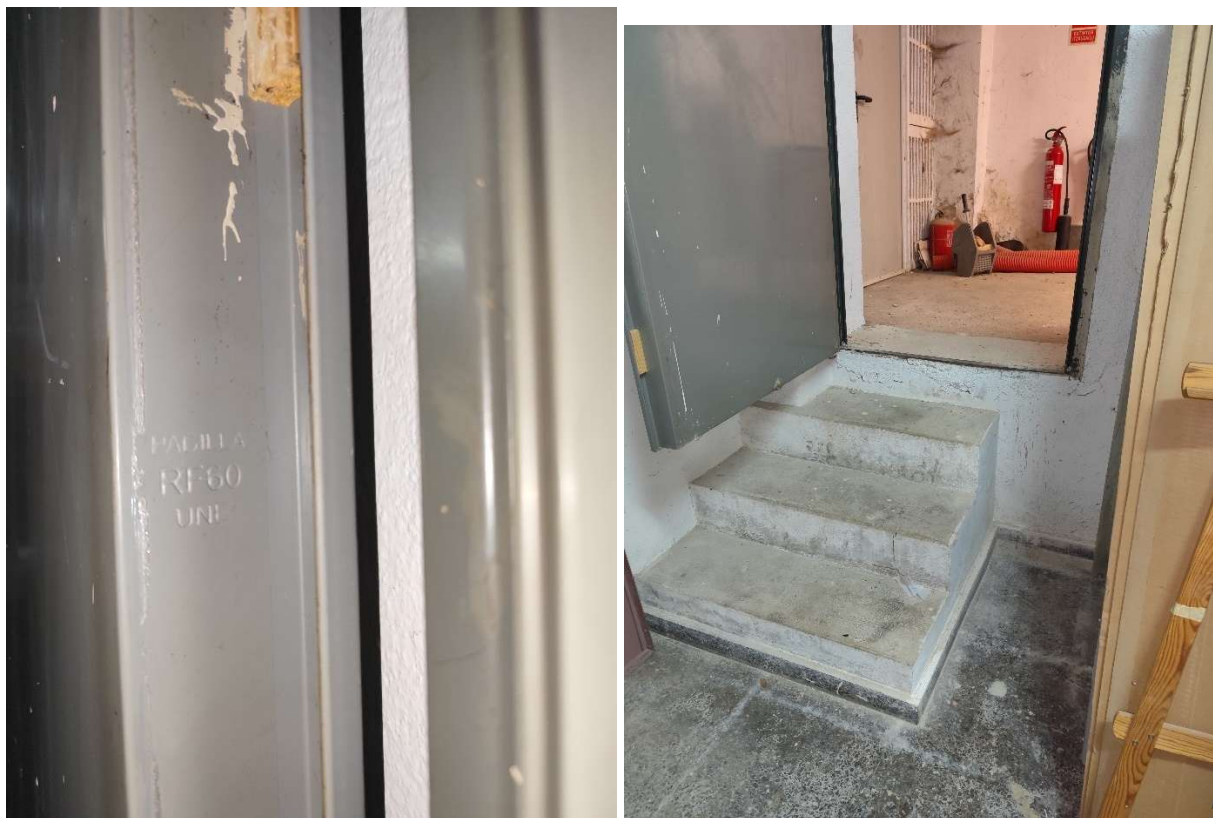
FOTOS 55 y 56 – Puerta SALA DE CALDERAS, homologación. Escaleras acceso a Sala de Calderas, reforma de anchura.
