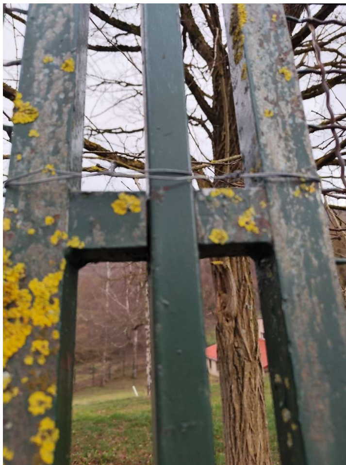
FOTOS 68 – Anclajes vallado perimetral A REPARAR O SUSTITUIR.
