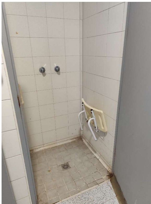
FOTO 10- Pavimentos en duchas a sustituir por un suelo antideslizante.
