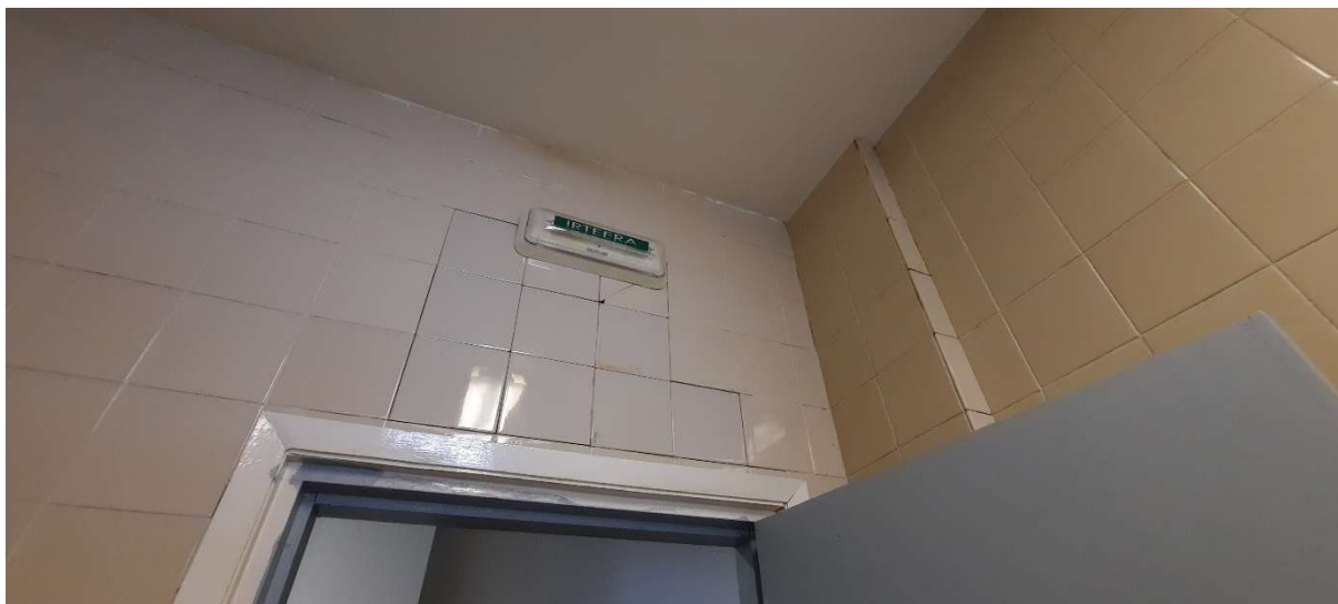
FOTO 06- Desperfectos Alicatados y Paredes.
