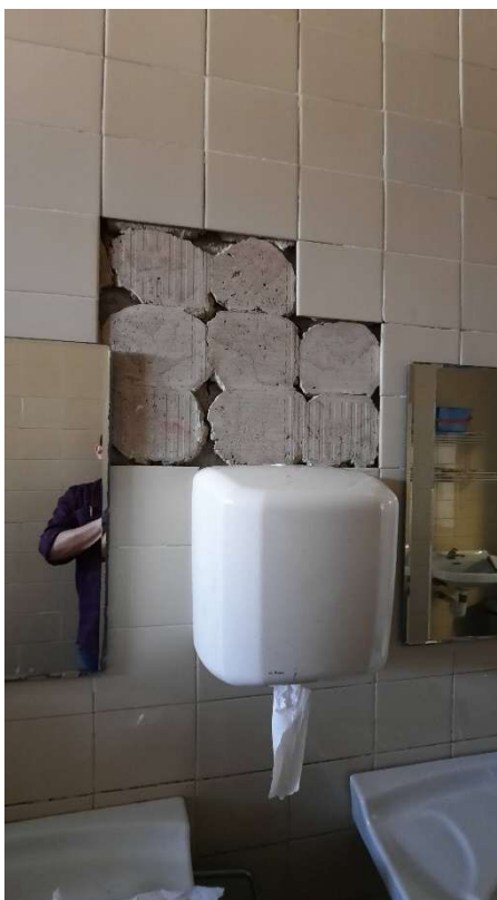
FOTO 07- Desperfectos Alicatados y Paredes.
