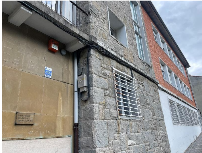
Caja general de protección
