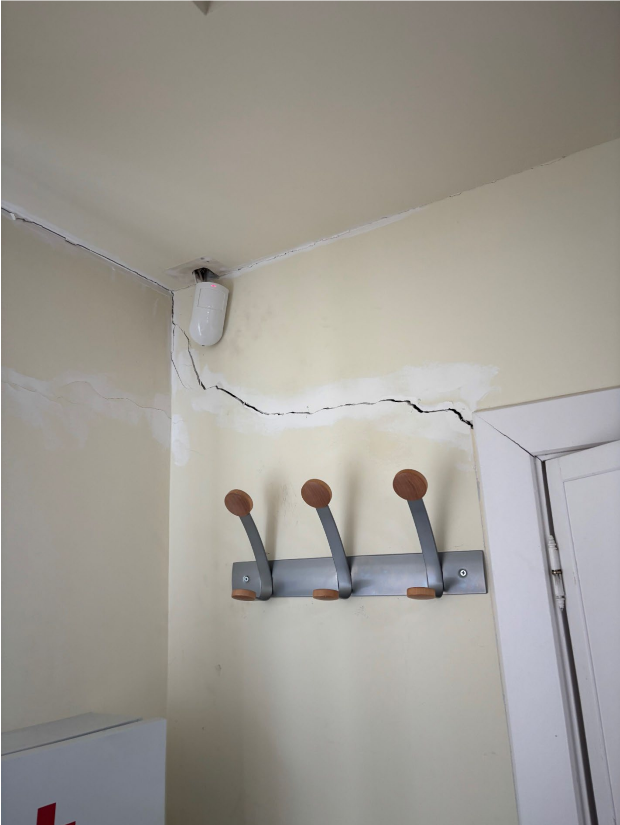
PLANTA BAJA FISURAS EN PARED SUR EN DESPACHO (3)
