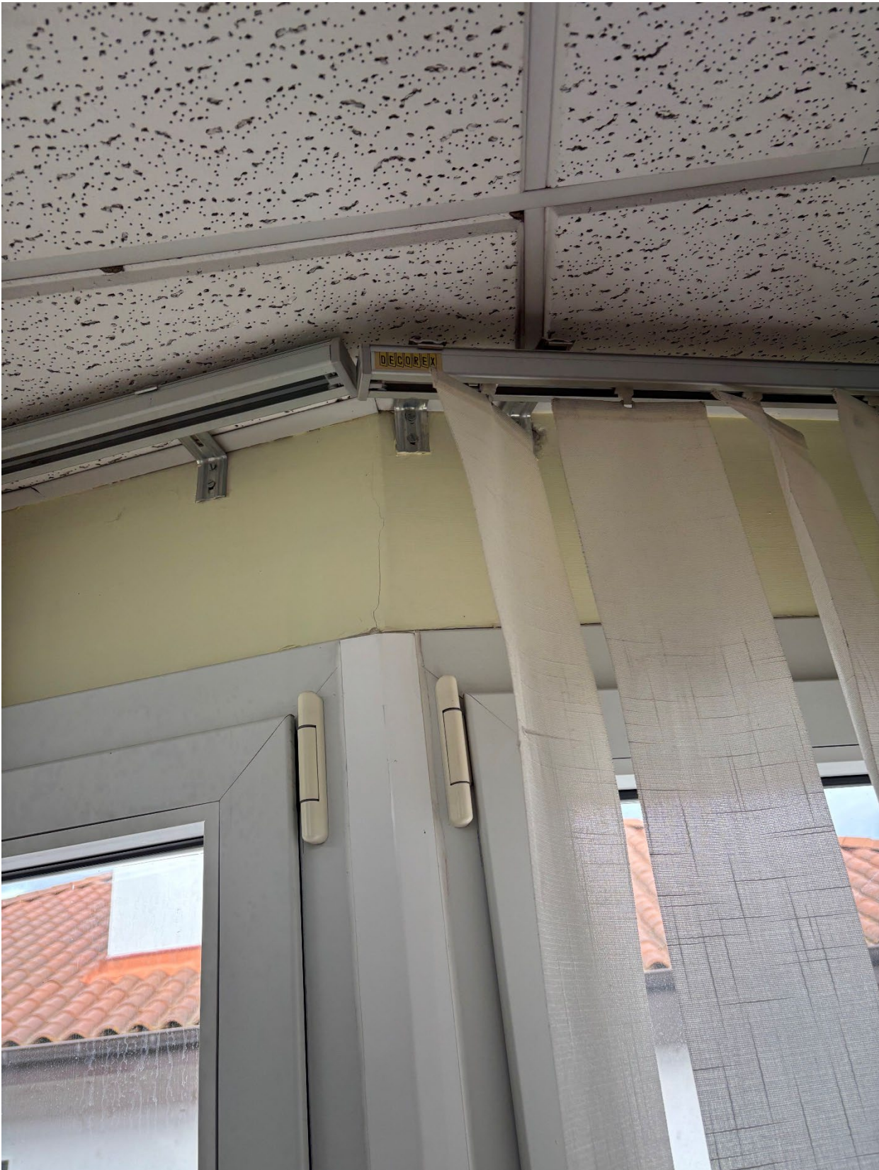
PLANTA PRIMERA FISURAS EN PARED NORTE SOBRE CARPINTERÍA EXTERIOR (10)
