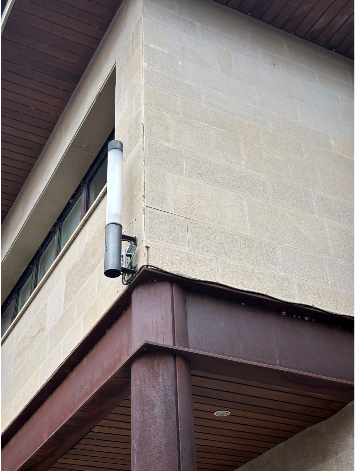
FISURAS EN INTERESECCIÓN DE FACHADAS SUR Y ESTE
