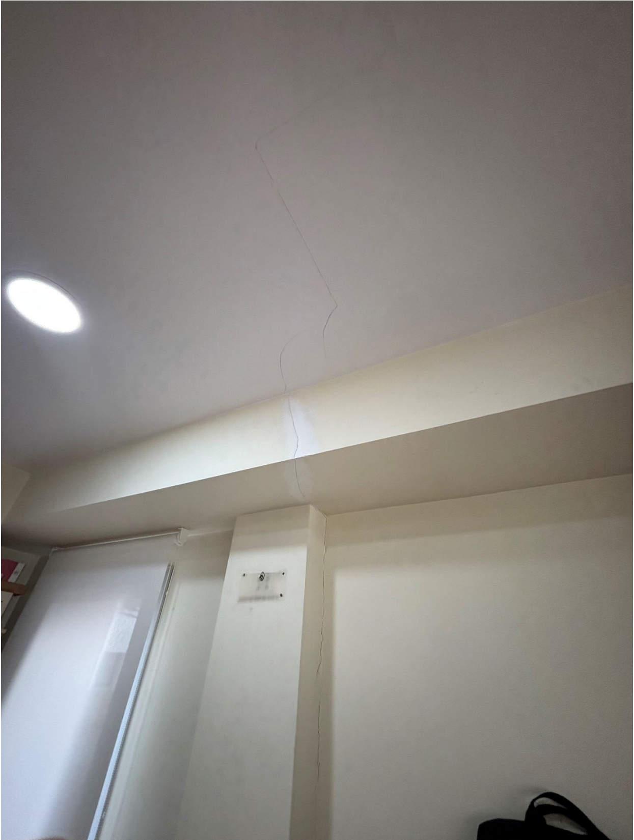
PLANTA BAJA FISURAS EN PARED ESTE JUNTO A PILAR 10 (5)
