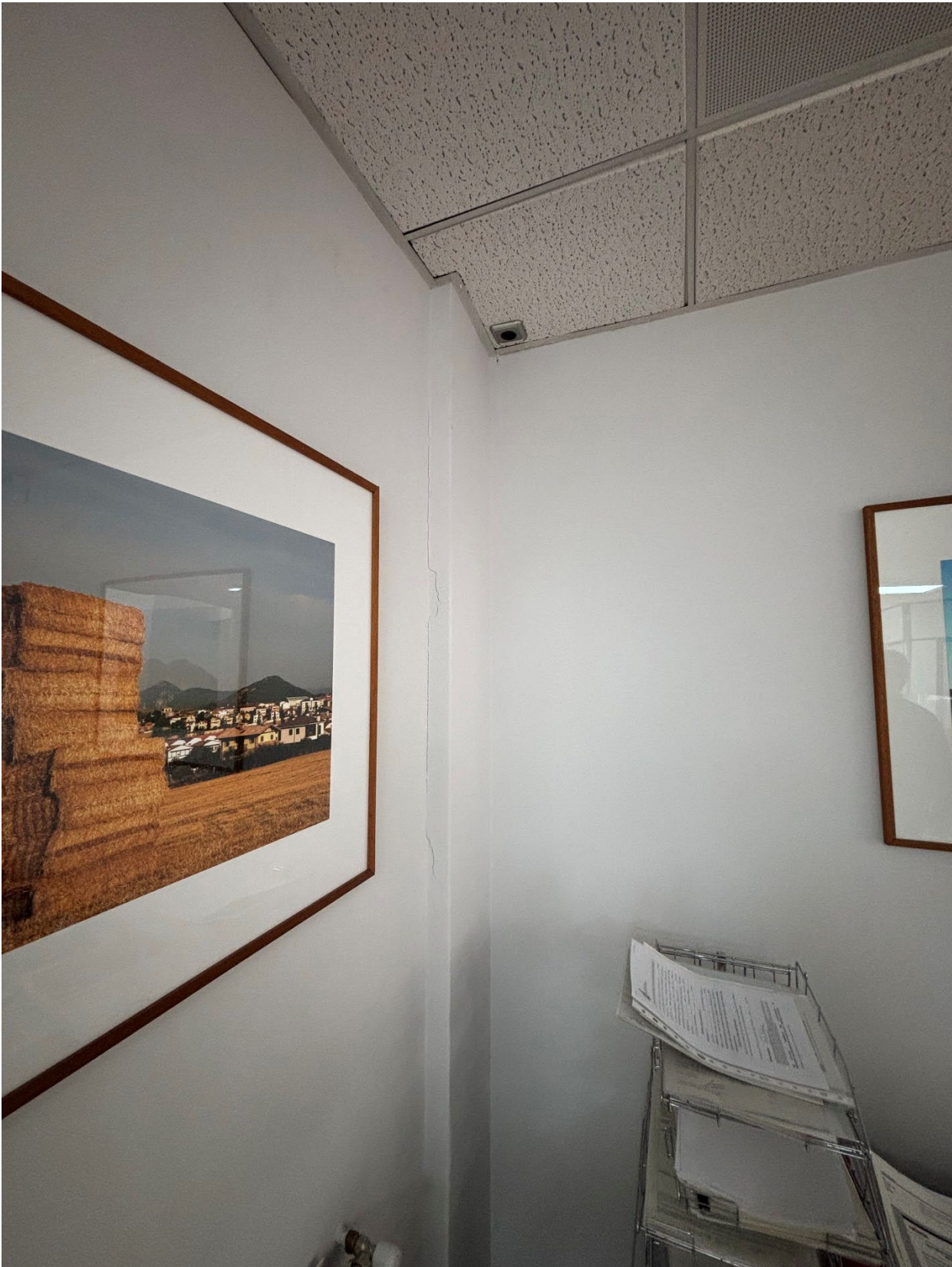
PLANTA PRIMERA, DESPACHO DEL SECRETARIO FISURAS EN ESCUADRA ENTRE PAREDES SUR Y OESTE, MARCANDO EL PILAR 3 (16)
