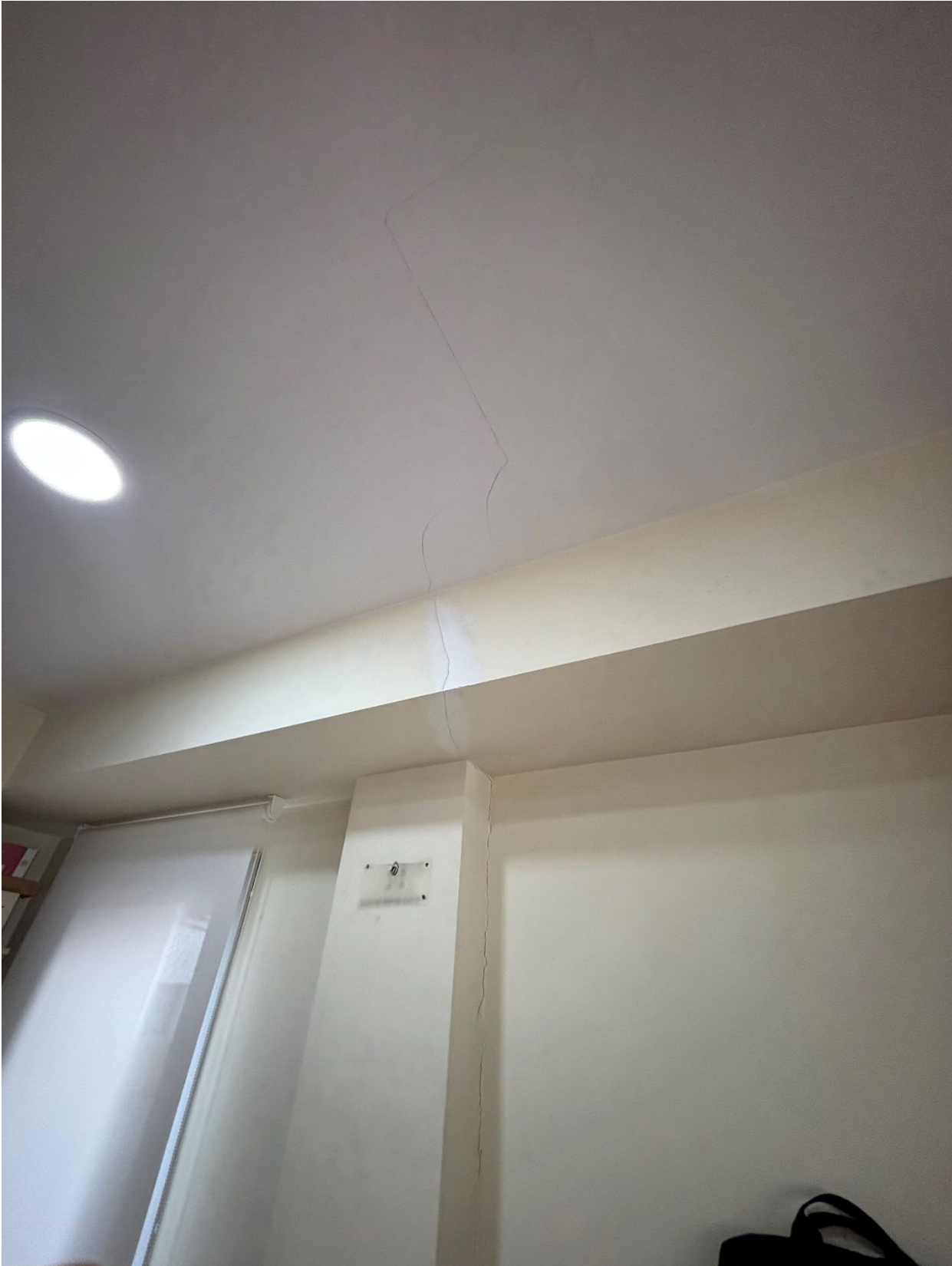
PLANTA PRIMERA, FISURAS EN PARED OESTE, MARCANDO PILAR 7 Y EN FALSO TECHO (17)
