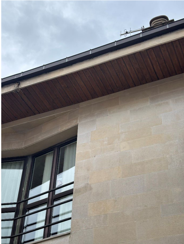
FISURAS EXTERIORES EN FACHADA NORTE
