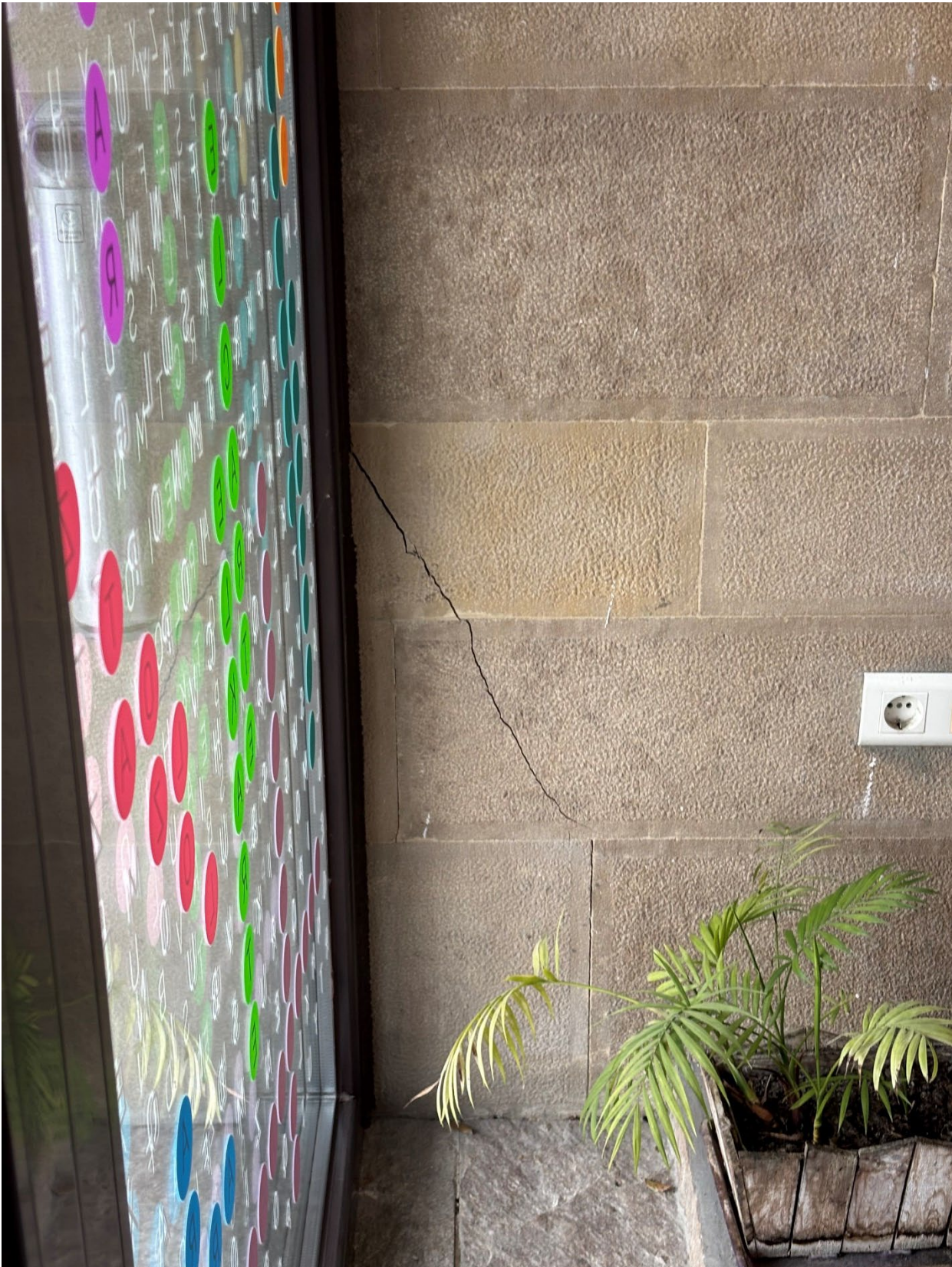
PLANTA BAJA FISURAS EN PARED SUR EN ZONA CORTAVIENTOS (2)
