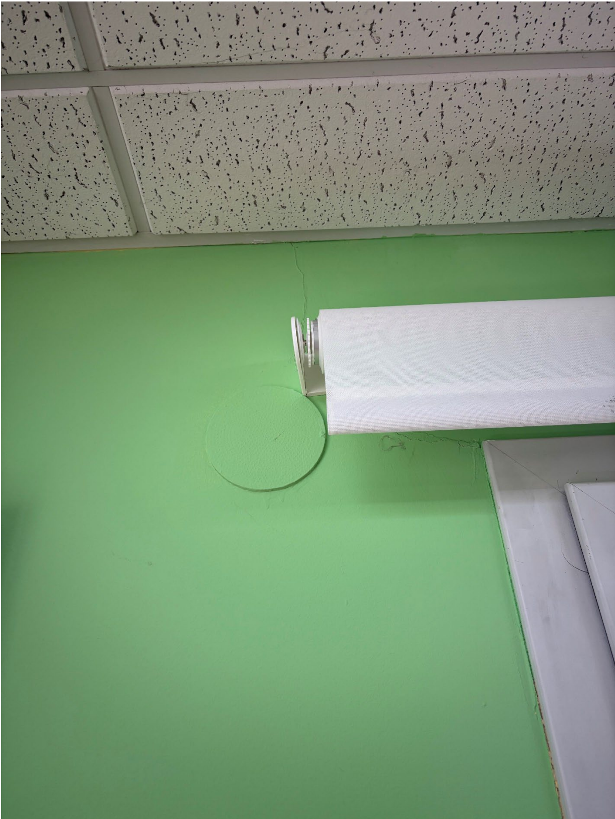
PLANTA PRIMERA FISURAS EN PARED ESTE, DESDE ESCUADARA DEL HUECO DE CARPINTERÍA (13)
