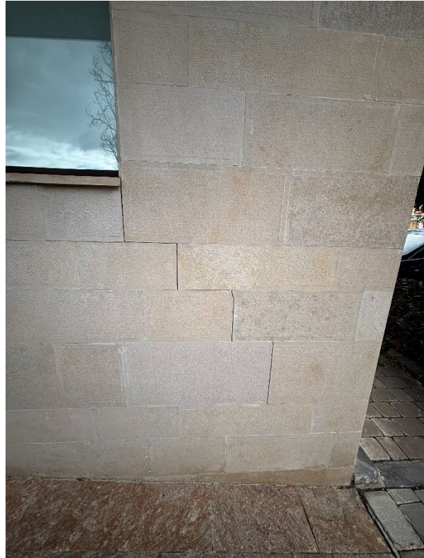
FISURA EN FACHADA SUR JUNTO A RAMPA
