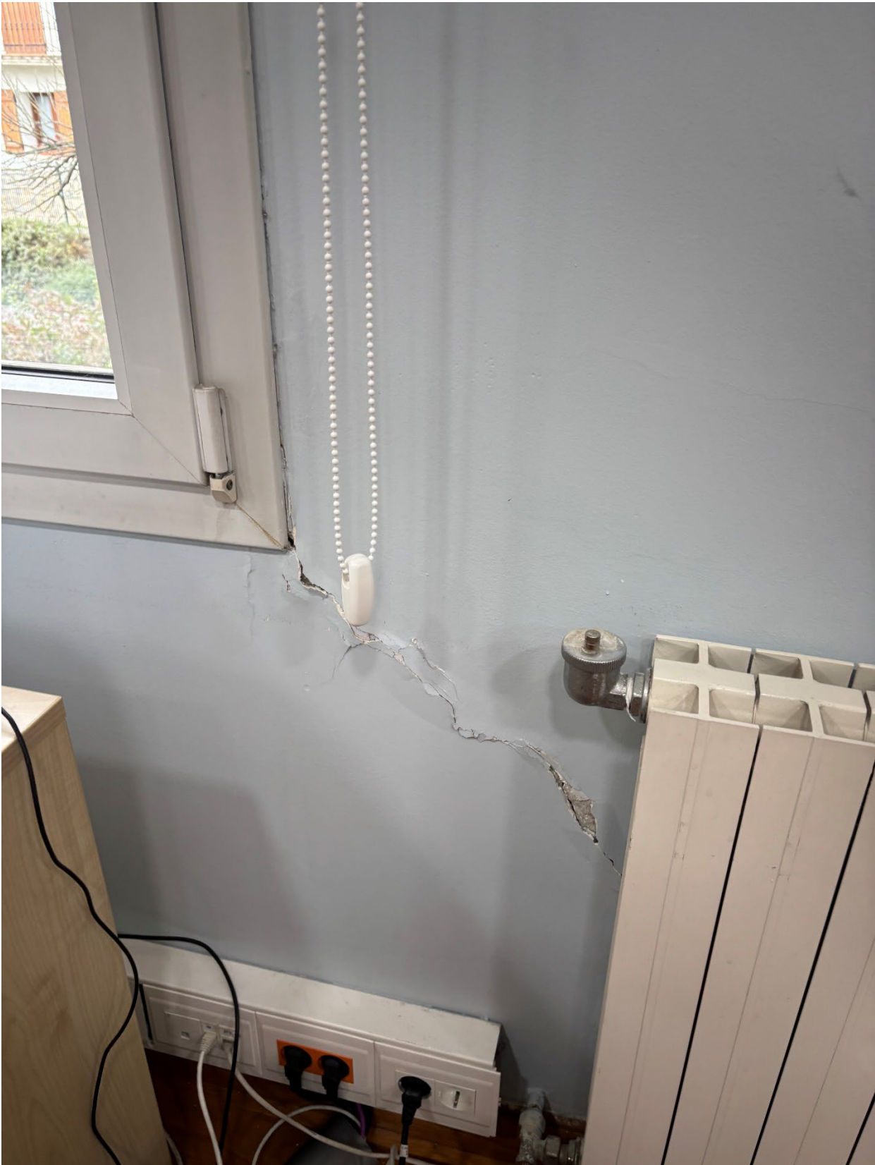
PLANTA BAJA FISURAS EN PARED OESTE (1)
