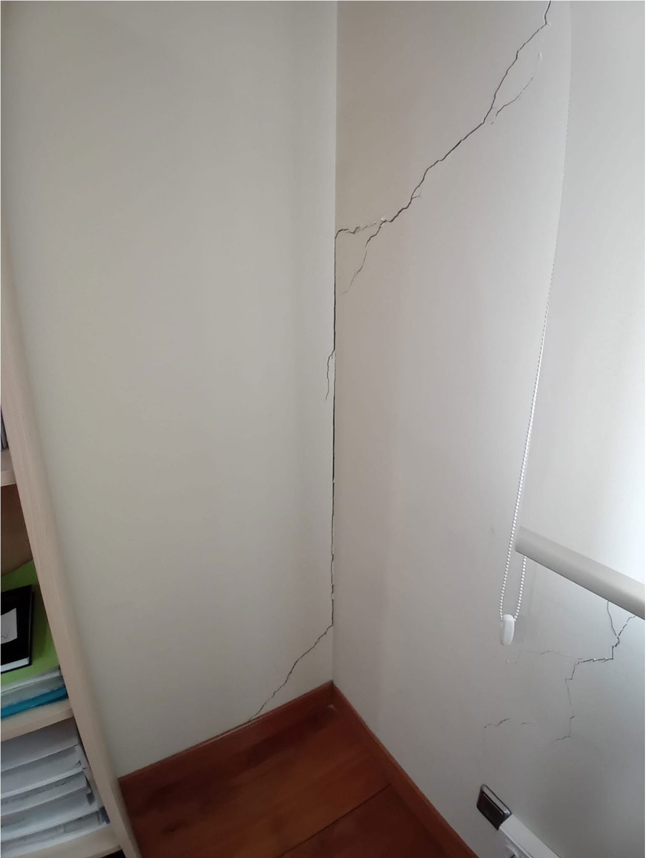
PLANTA BAJA FISURAS EN PARED ZONA ADMINISTRATIVA (9)
