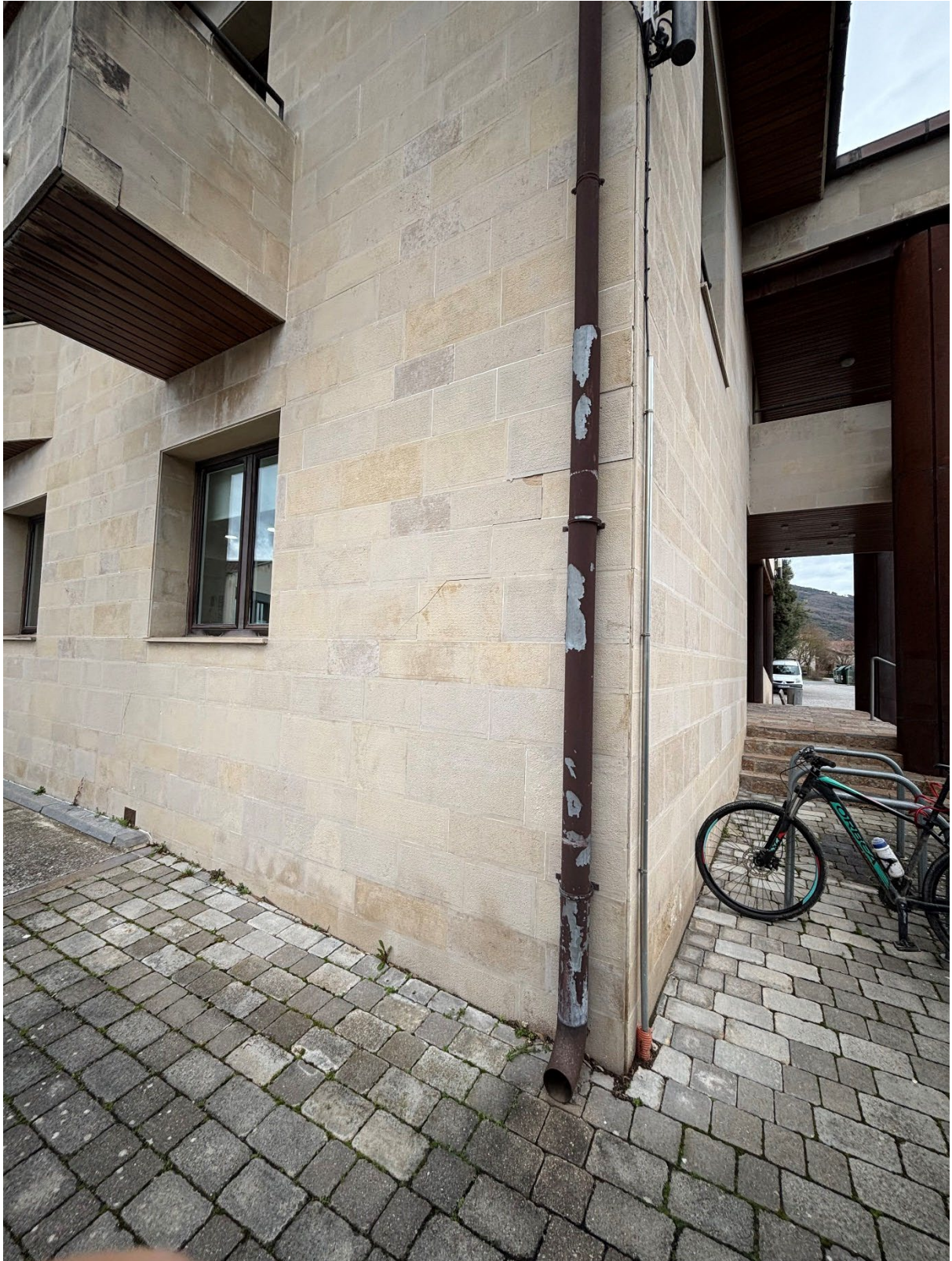
DESPEGUE DE LOSETA DE BALCÓN DE PLANTA PRIMERA EN FACHADA ESTE Y FISURAS EN ESQUINA
