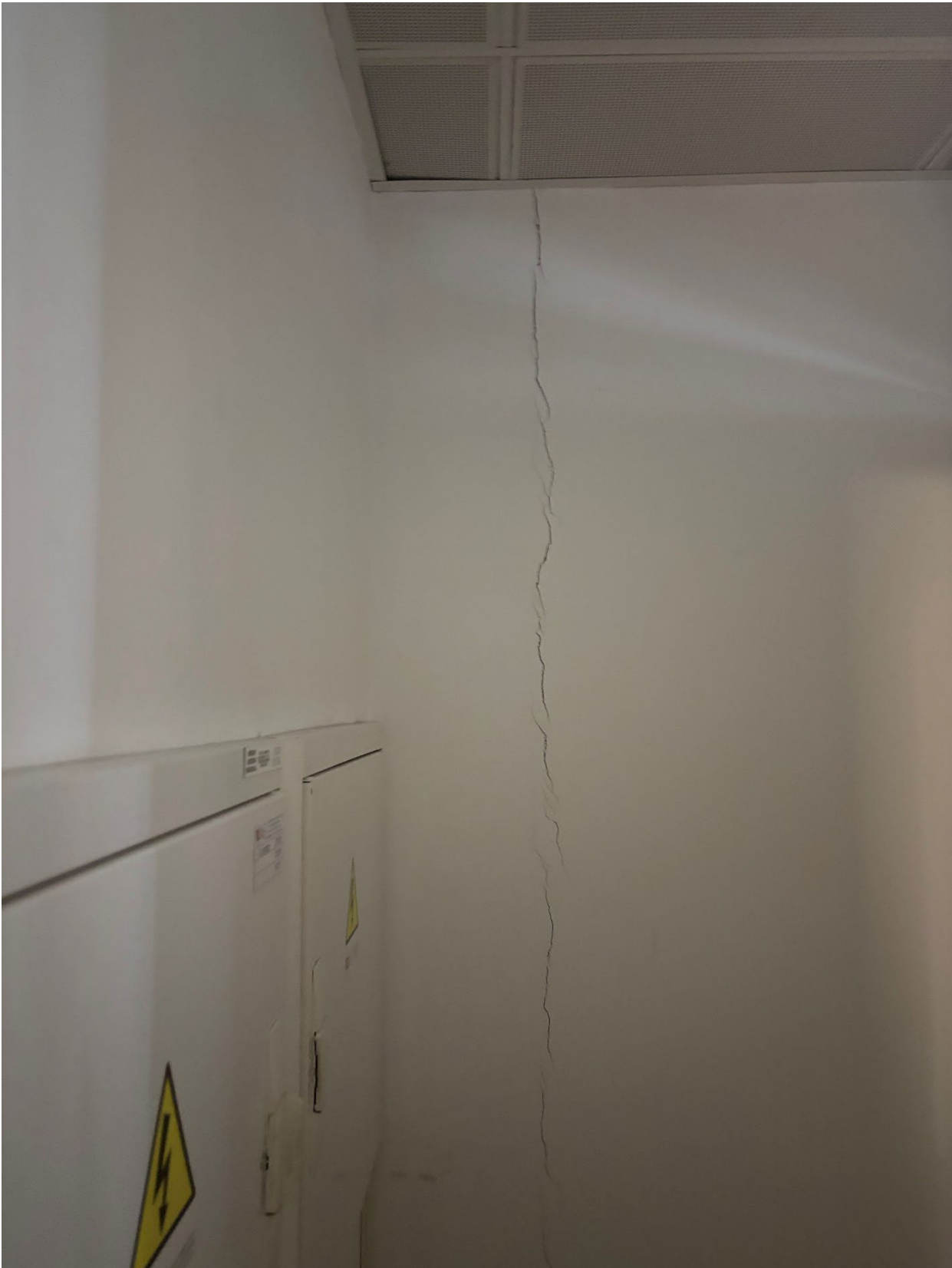
PLANTA BAJA FISURAS INTERIORES EN ACCESO A CUARTO DE INSTALACIONES, MARCANDO EL PILAR (6)
