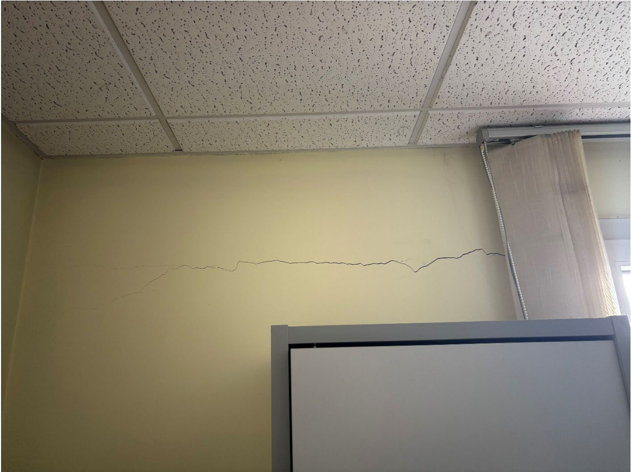
PLANTA PRIMERA FISURA ENTRE PILAR Y HUECO DE CARPINTERÍA EN ESCUADRE NOR-ESTE (12)
