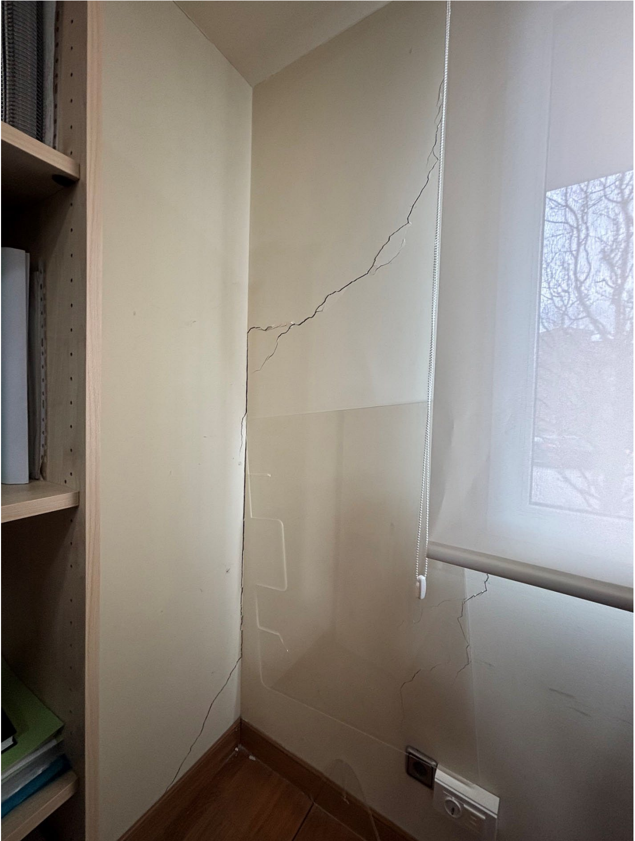
PLANTA BAJA FISURAS EN PAREDES ESTE-SUR EN DESPACHO (4)
