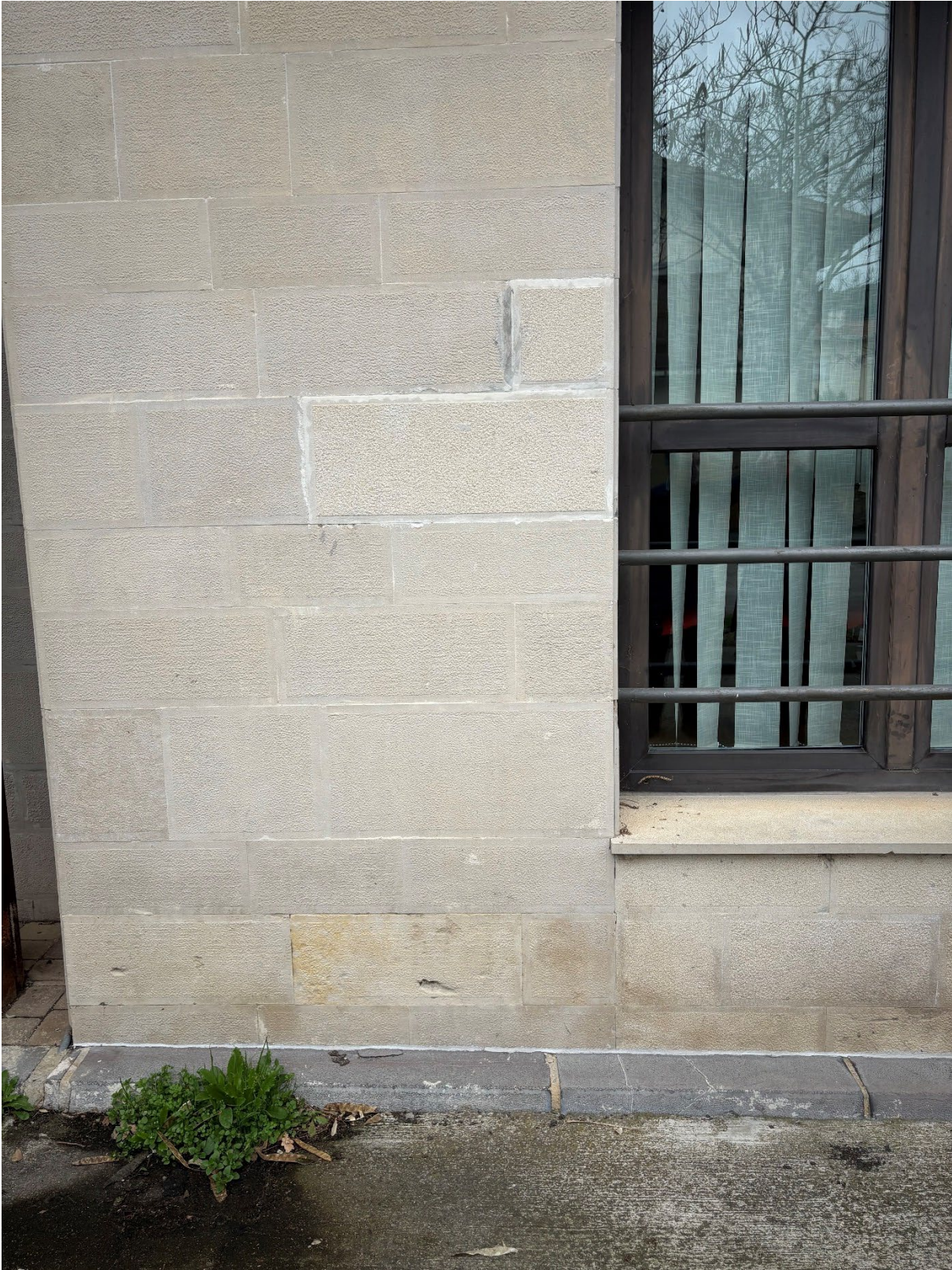
FISURA EN APLACADO EN EXTERIOR DE VENTANAL EN FACHADA ESTE DE SALÓN DE PLENOS
