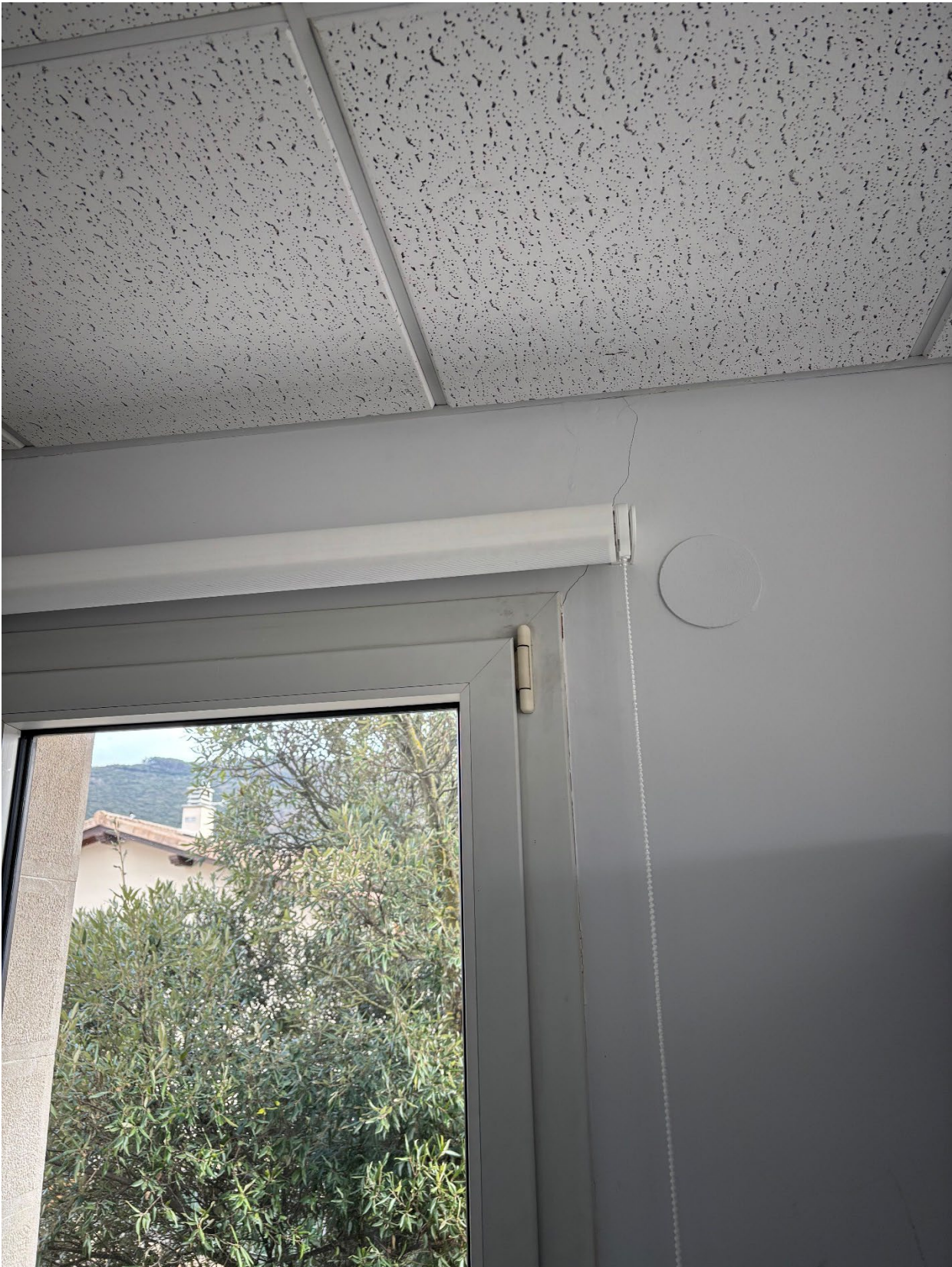
PLANTA PRIMERA FISURAS EN PARED ESTE, SOBRE DINTEL DE CARPINTERÍA DE ACCESO AL BALCÓN (14)
