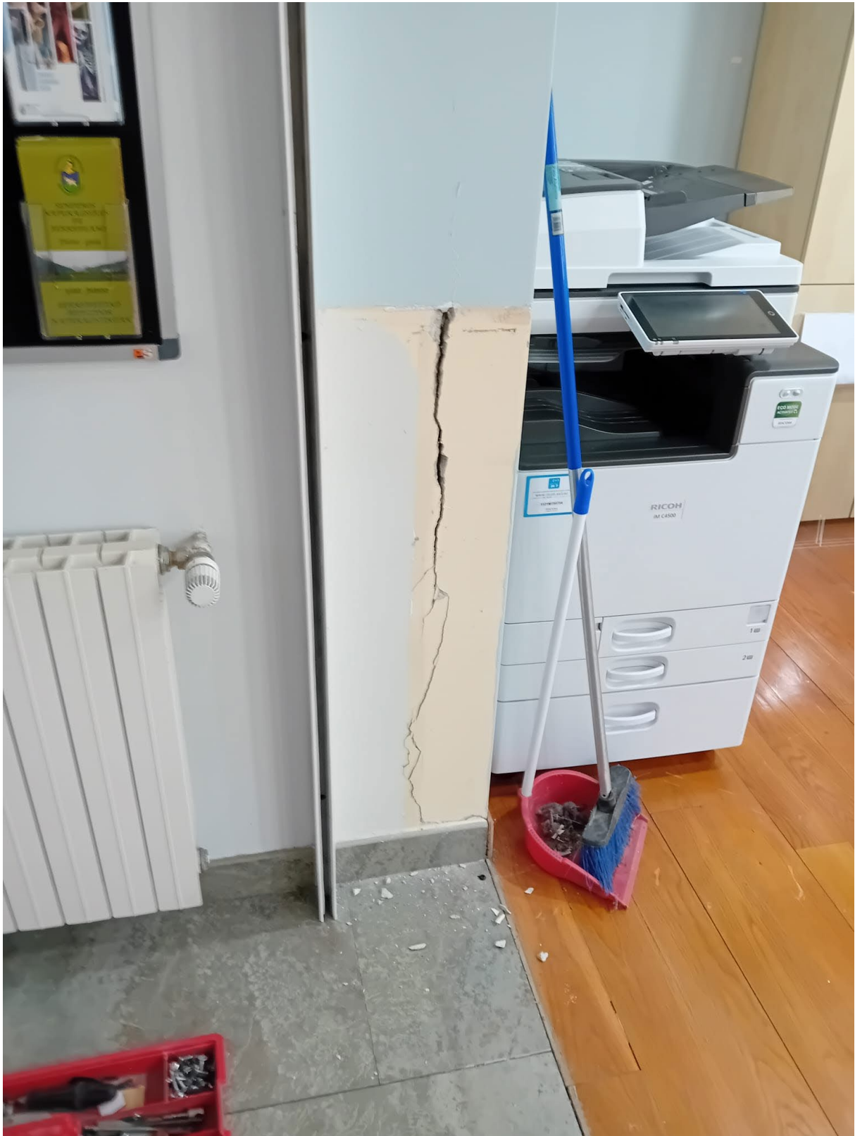
PLANTA BAJA FISURAS EN PARED SUR (2)
