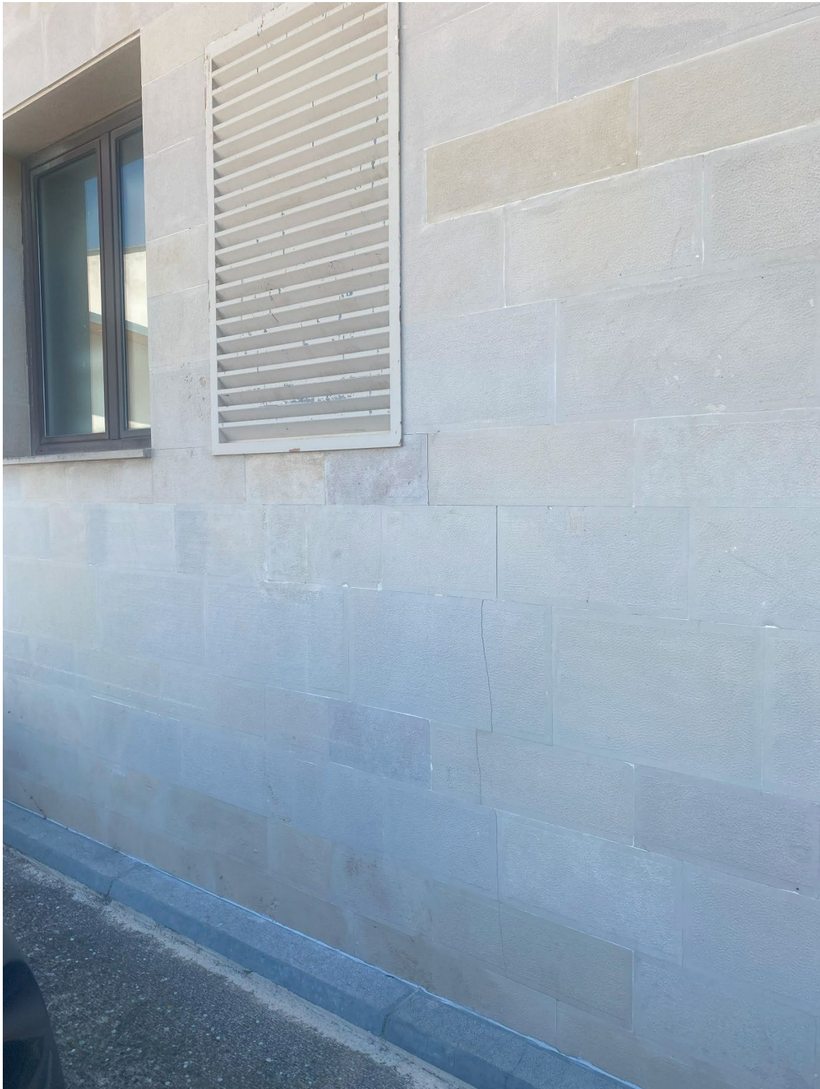
FISURAS EN APLACADO EN EXTERIOR DE FACHADA OESTE
