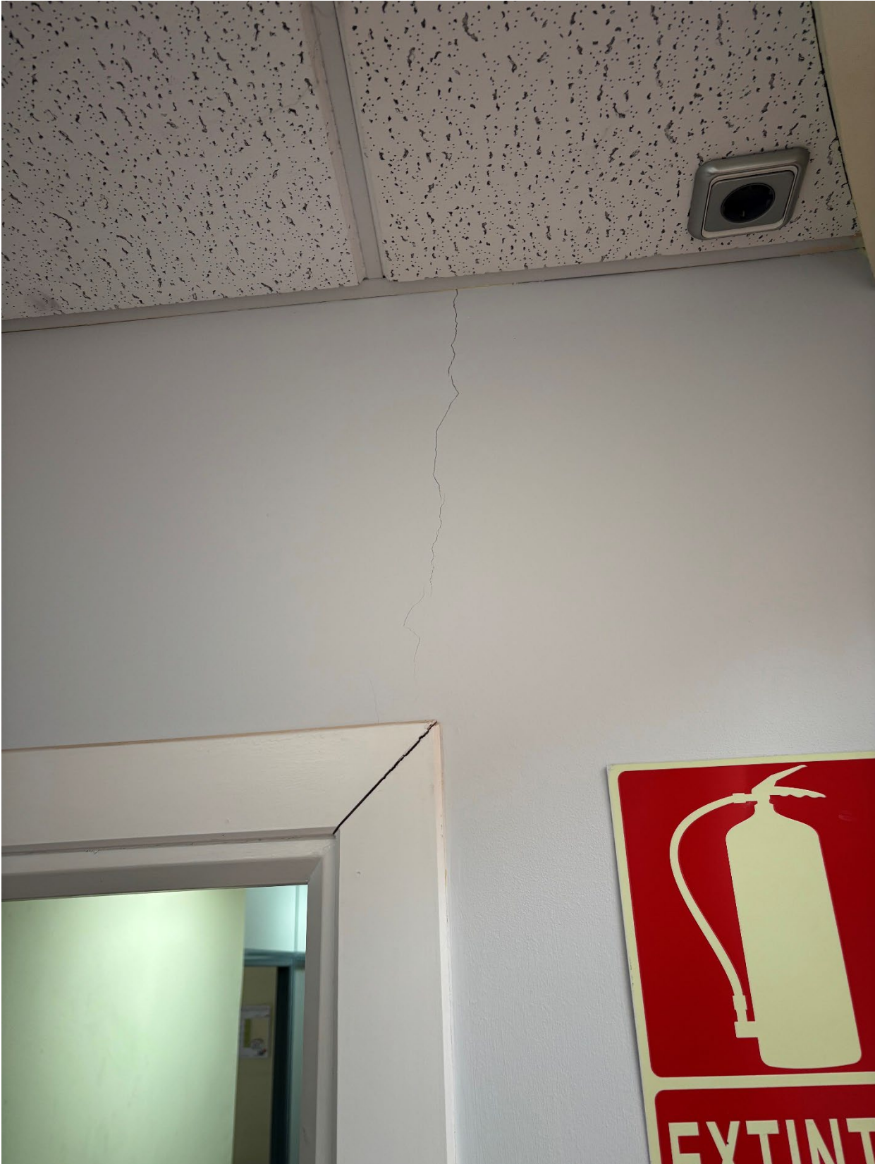
PLANTA PRIMERA FISURA INTERIOR EN JAMBA Y TABIQUERÍA EN PASO DE ZONA COMÚN A ARCHIVO (11)
