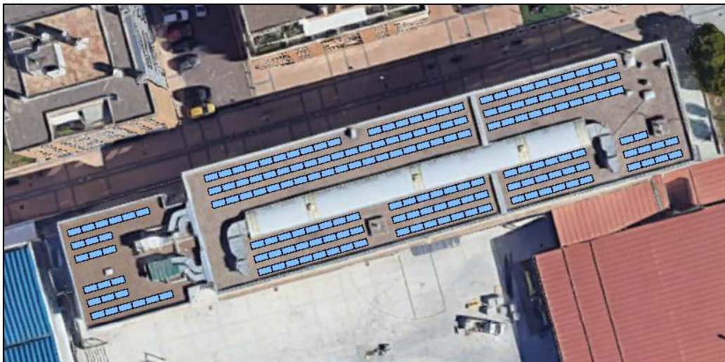
Imagen. Distribución paneles en cubierta.
