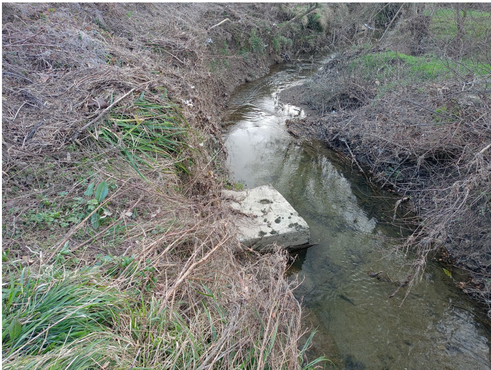
Salida aliviadero con clapeta a regata.
