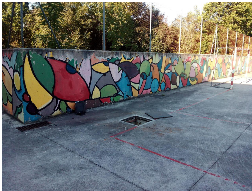
Tapa arqueta de bombeo en patio.
