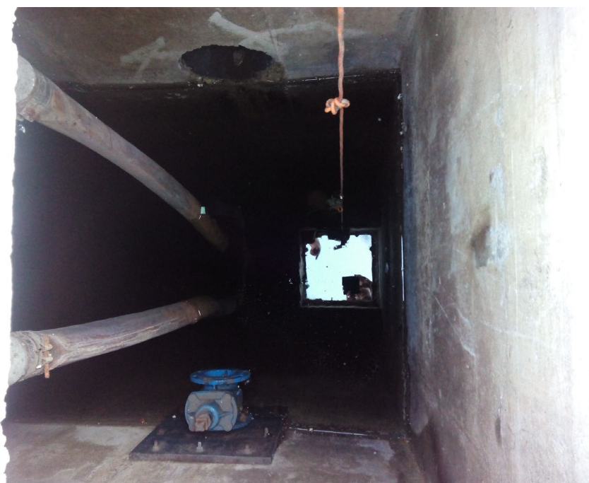
Pozo de bombeo.
