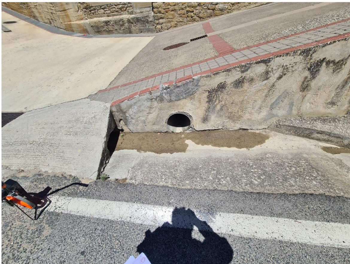
FOTOGRAFÍA 8: Salida pluviales en superficie tras pozo de registro. Discontinuidad de acera.
