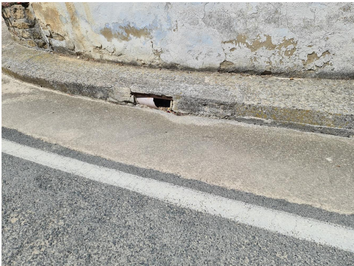
FOTOGRAFÍA 10: Aceras de dimensiones reducidas y con colector de pluviales vertiendo a la vía.
