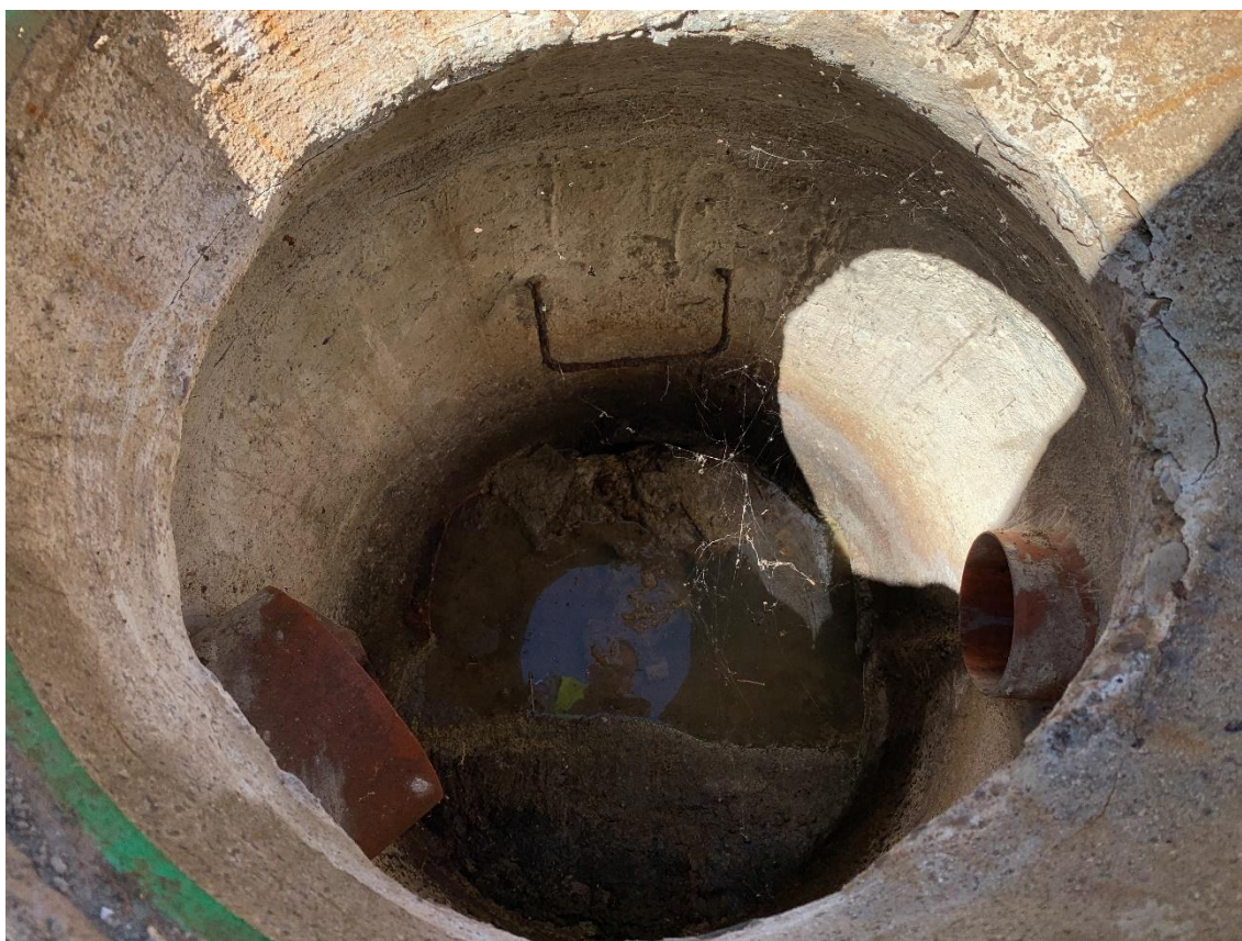
FOTOGRAFÍA 2: Interior de pozo de registro sin cuna, y atasco de fecales.
