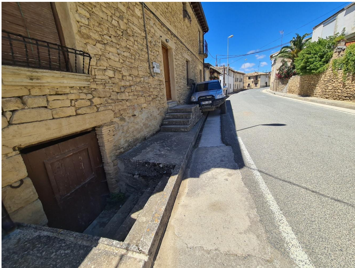
FOTOGRAFÍA 7: Desniveles en acera frente a portal 30
