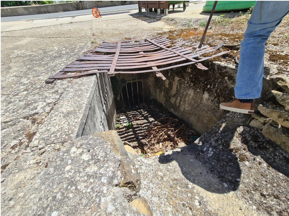
FOTOGRAFÍA 12: Colector de pluviales donde conectaremos la red del pueblo, vierte en el campo aledaño cruzando bajo la vía.
