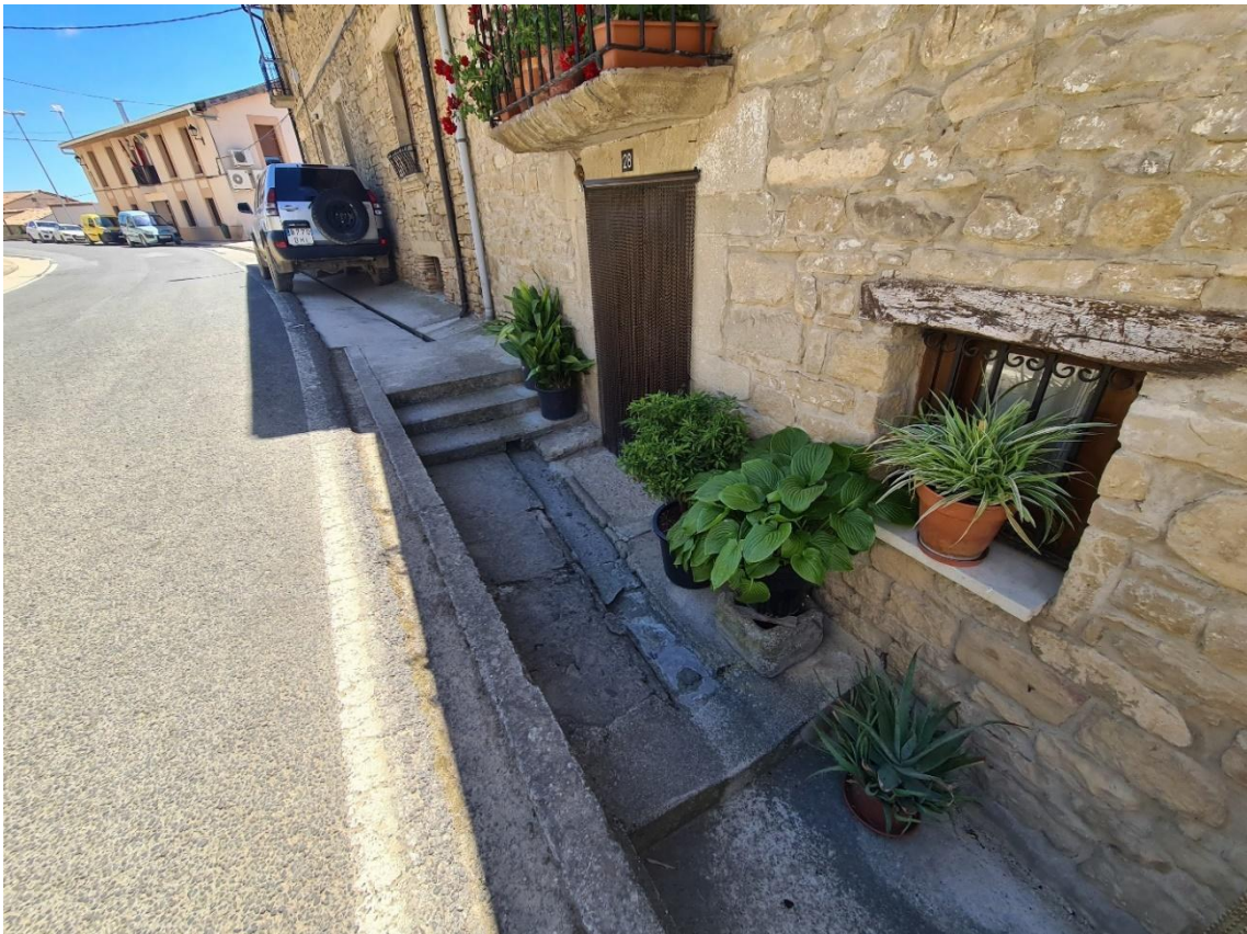
FOTOGRAFÍA 6: Desnivel en acera frente a portales 28 y 26. Y muro de contención de la calzada que puede verse afectado por las obras.
