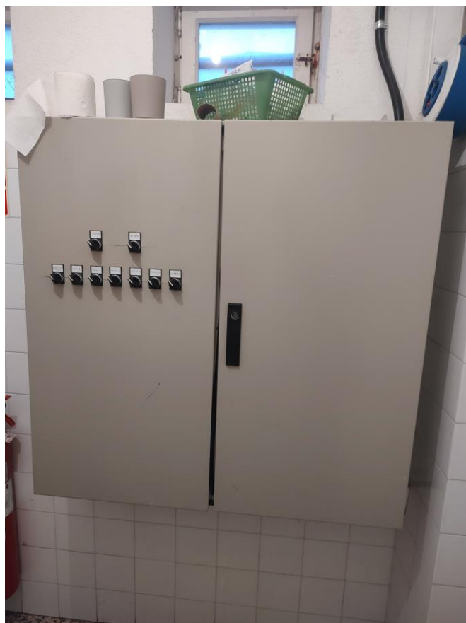
Imagen 6: Cuadro general de protecciones del frontón.
