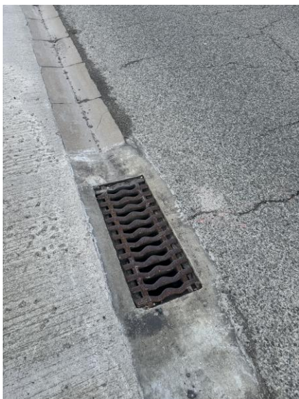
FOTO 16. Sumidero delante de Caravanas Itsaso
