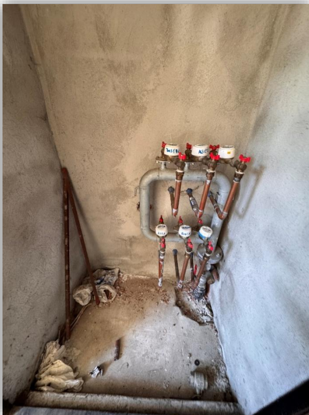
Fotografía 15 – Conexión a armario de contadores en portal 14.
