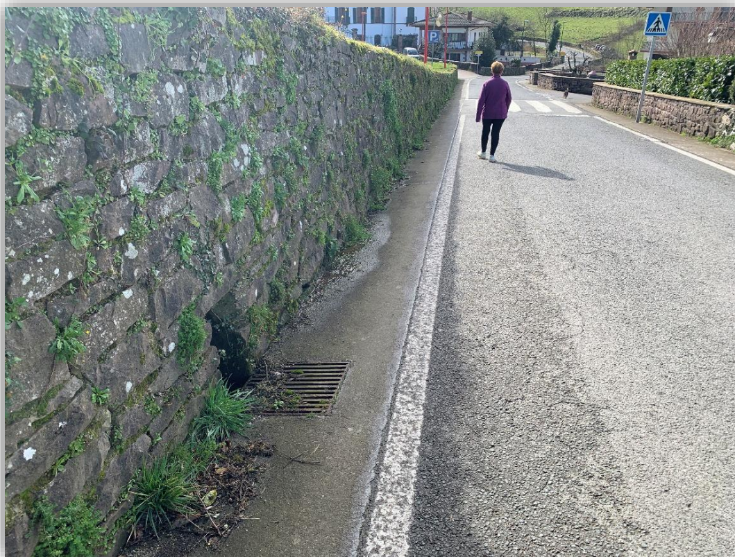
Fotografía 6 – Acometidas en pared, red de pluviales en la cuneta.
