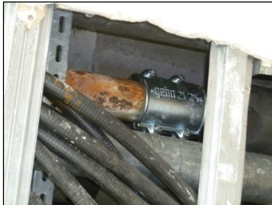
Estado de tubería - racor
