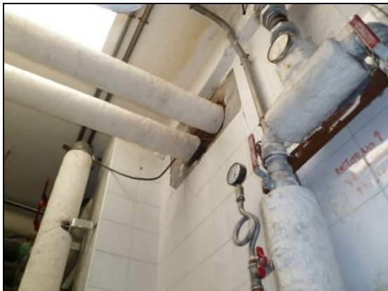
Salida de tuberías desde sala caldera
