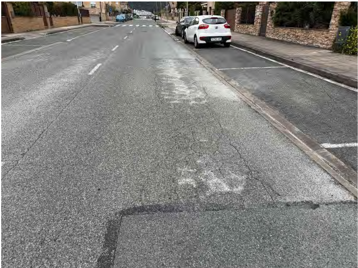
PK 0+275: daños en pavimento (parcheado 17).
