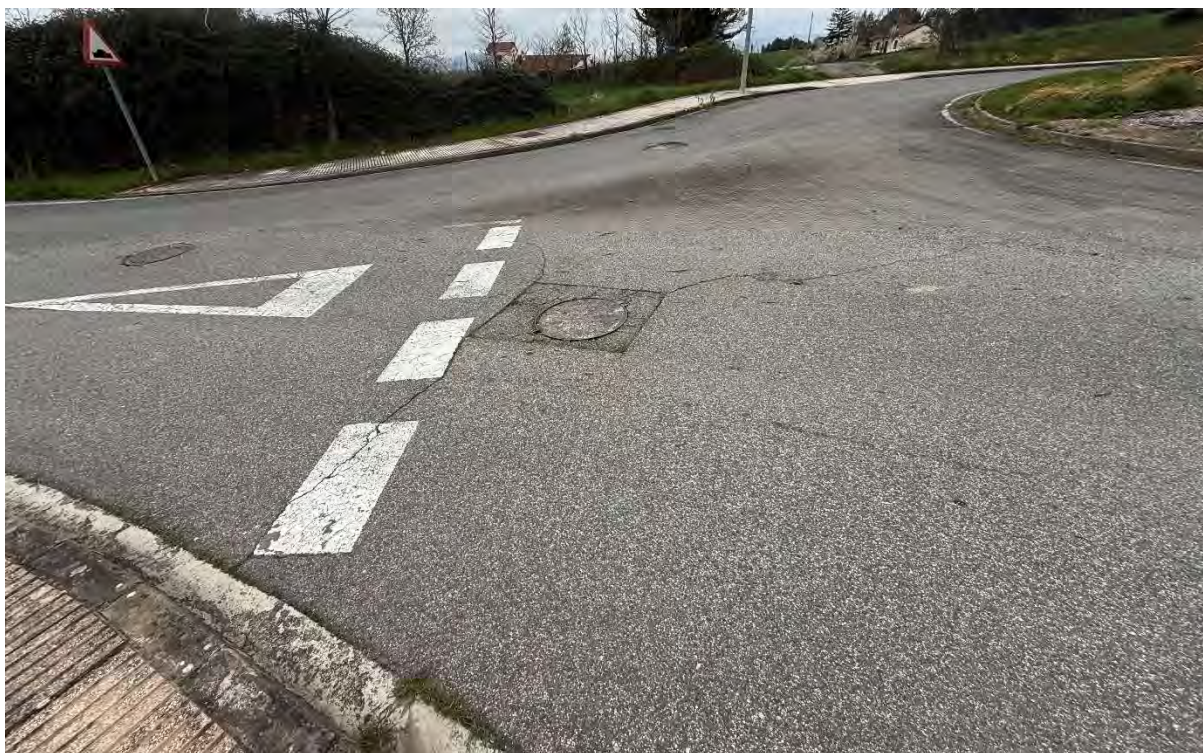
PK 0+331. Pavimento dañado y agrietado. Asentamientos. (Parcheado 14).
