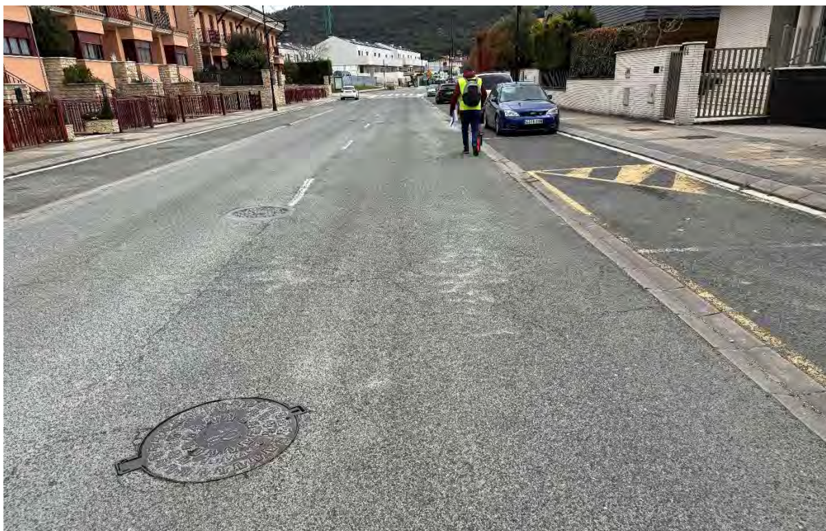
PK 0+500: daños en pavimento (parcheado 29). Parada 3 y contenedores de RSU.
