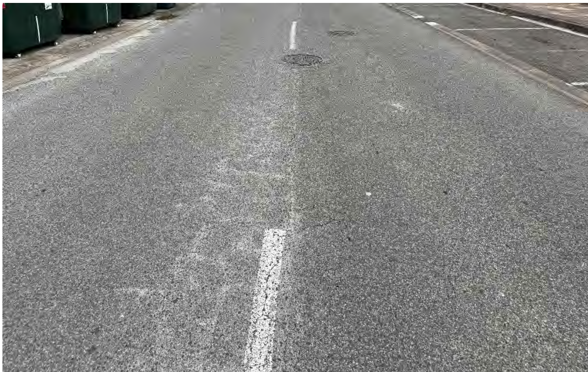
PK 0+355: daños en pavimento (parcheado 19.1).
