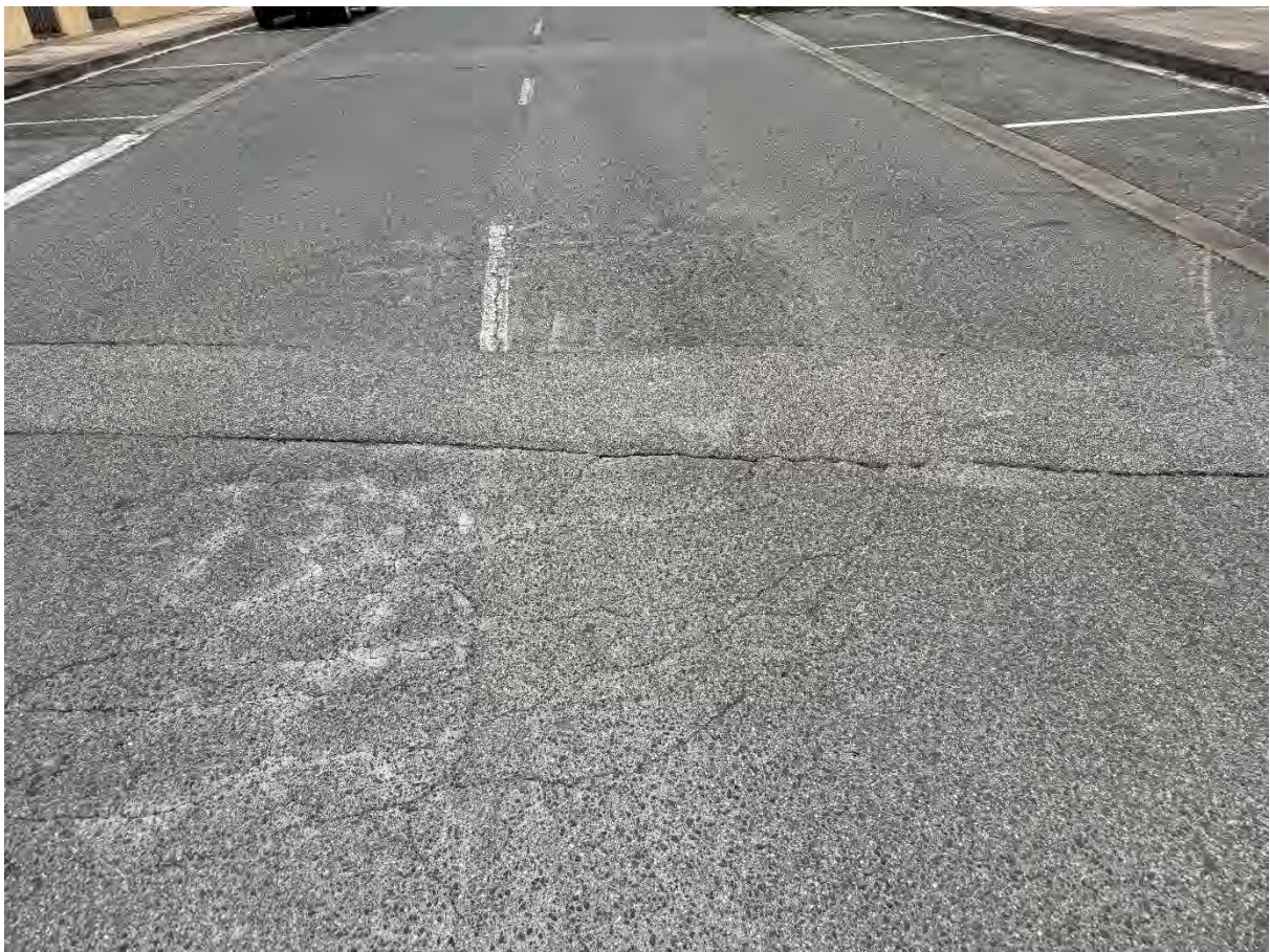
PK 0+209: daños en pavimento (parcheado 12)
