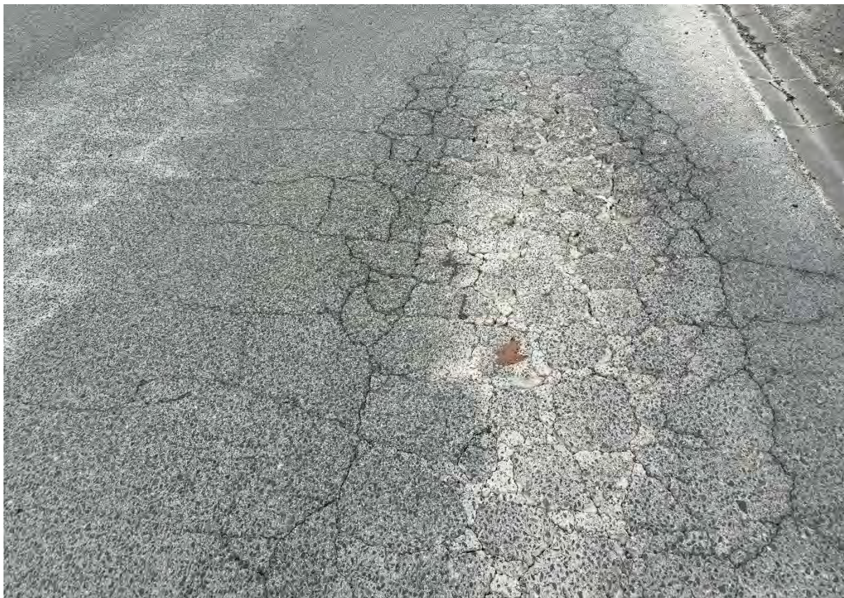
PK 0+476: daños en pavimento (parcheado 29).
