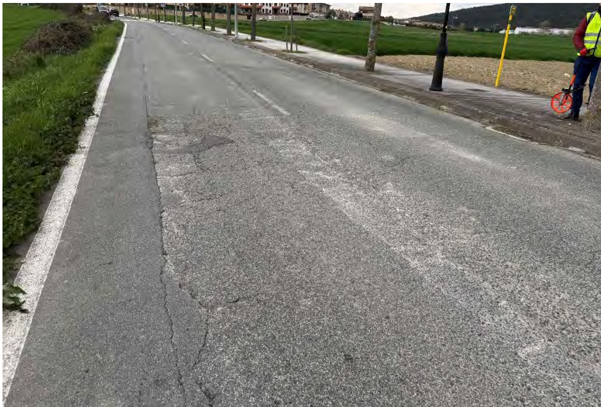
PK 0+220. Pavimento dañado y asentamientos. (Parcheado 6).
