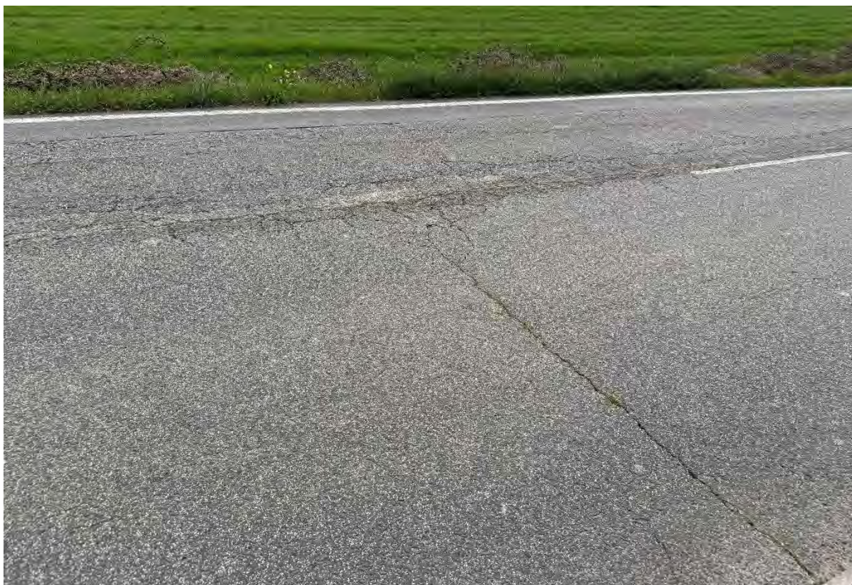
PK 0+230. Pavimento dañado y asentamientos. (Parcheado 7).
