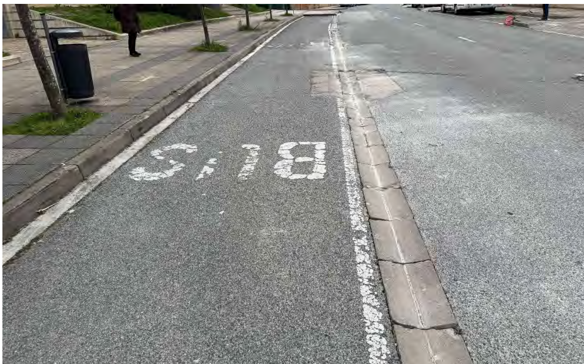
Parada bus 2: daños en caz y pavimento. Se observan reparaciones anteriores. (Parcheado 4).
