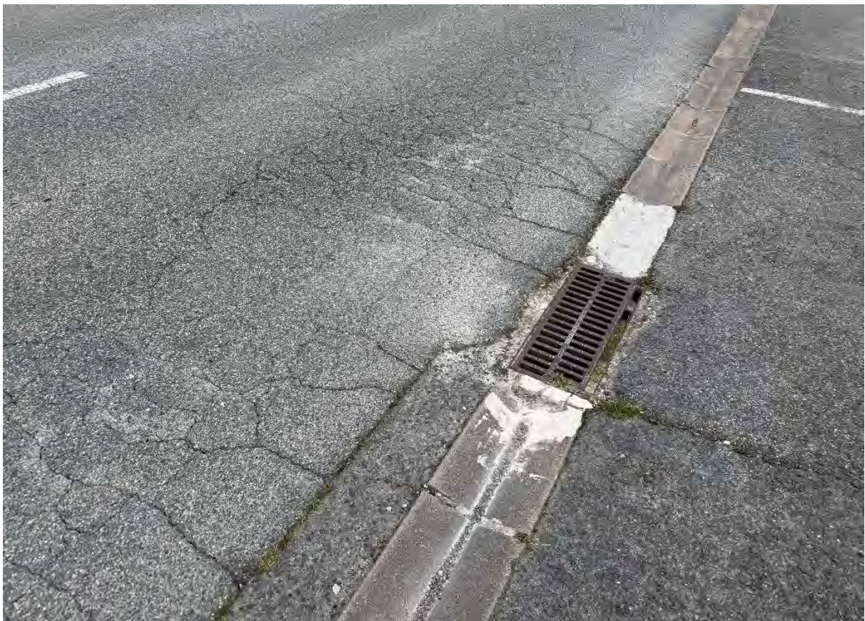
PK 0+345: detalle daños en pavimento y caz (parcheado 19).
