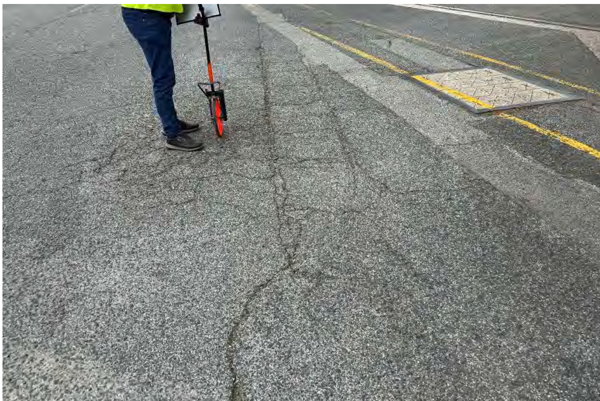
PK 0+040. Pavimento dañado en zona de acceso a parcela industrial. (Parcheado 2).
