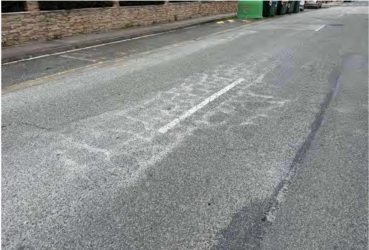
PK 0+420: daños en pavimento (parcheado 24). Parada 3.
