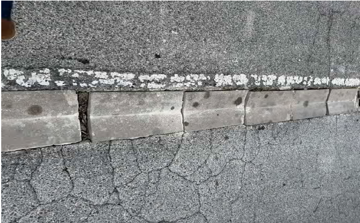
Parada bus 2: detalle de daños en caz y pavimento. (Parcheado 5).
