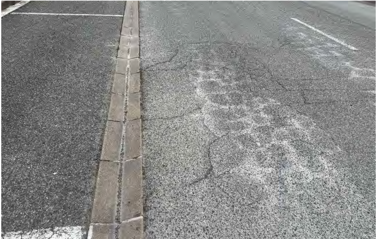
PK 0+280: daños en pavimento (parcheado 16).
