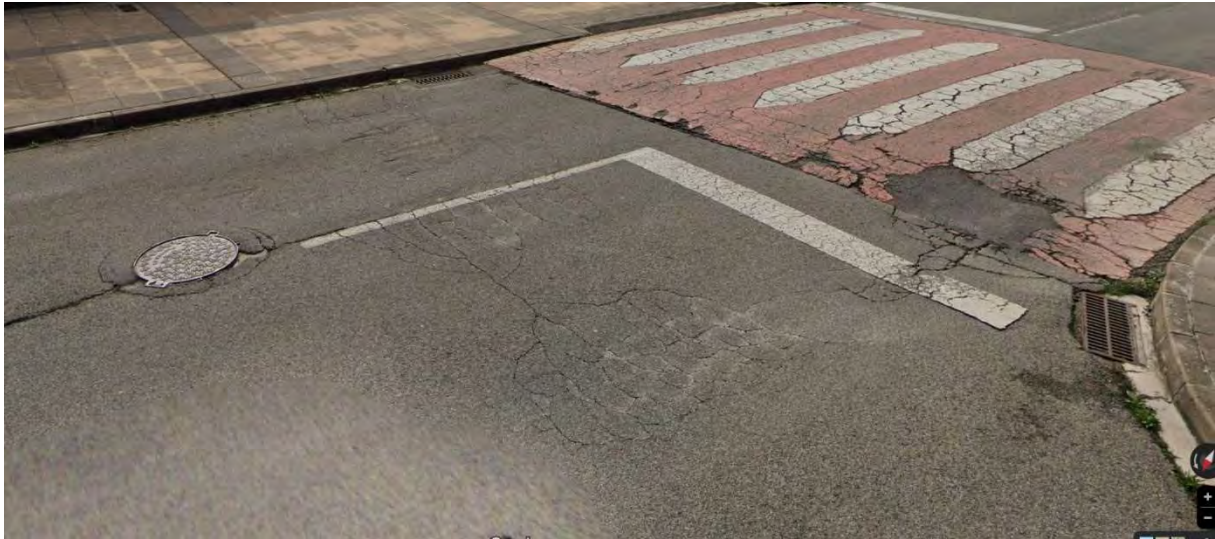
PK 0+255: daños en pavimento (parcheado 14).
