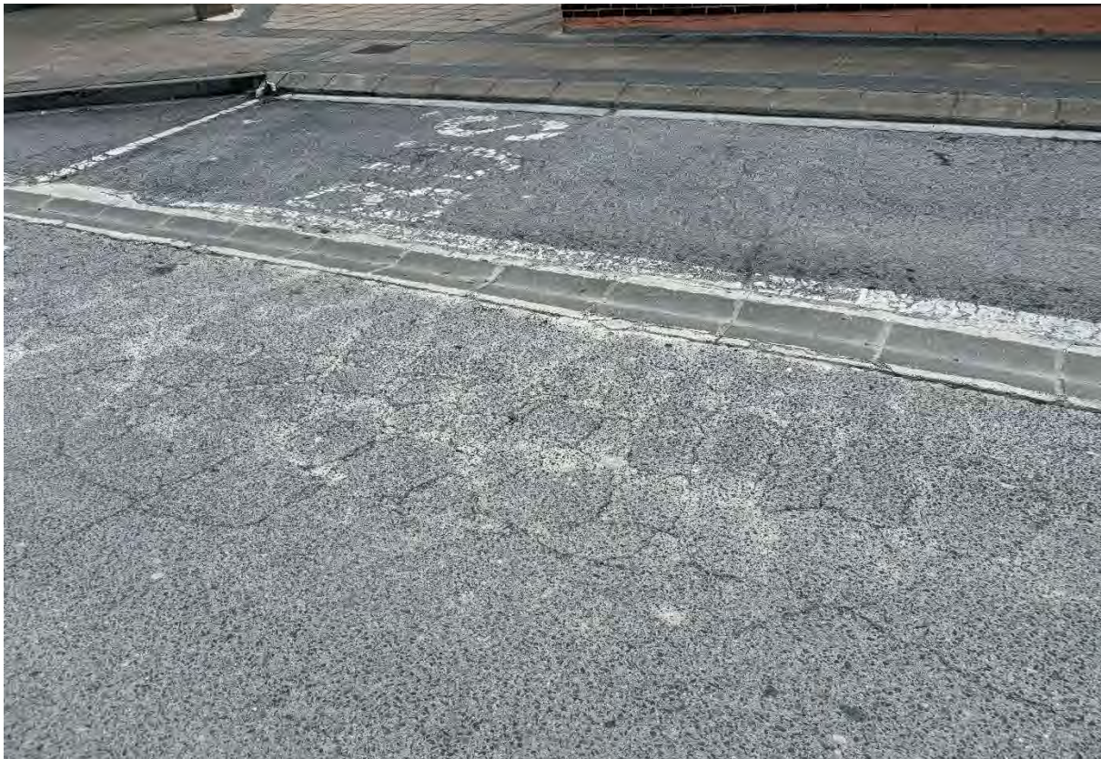
PK 0+710: daños en pavimento (parcheado 40).
