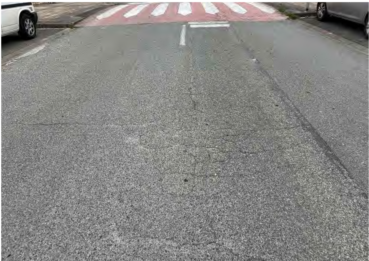
PK 0+380: daños en pavimento (parcheado 21).
