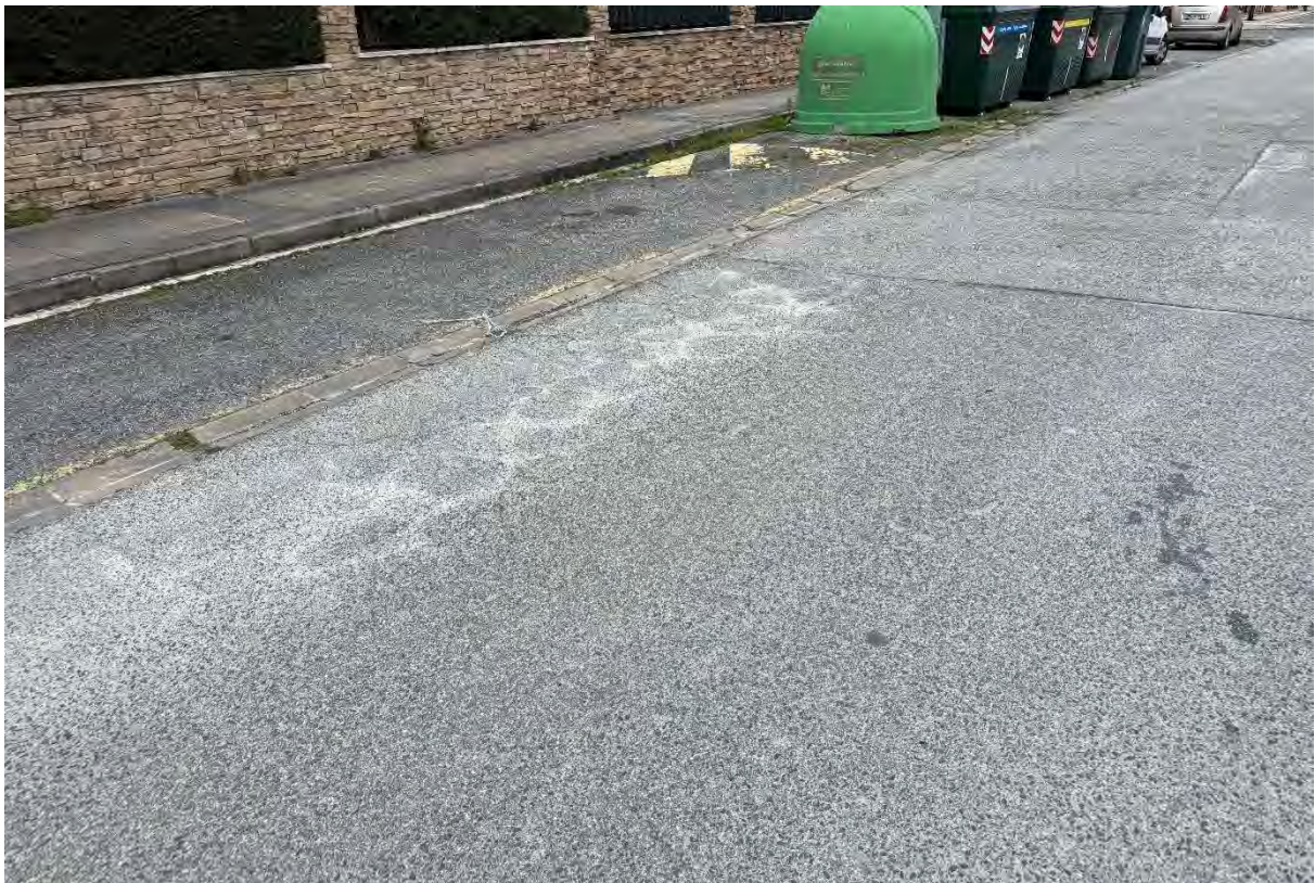
PK 0+440: daños en pavimento (parcheado 25). Parada 3.
