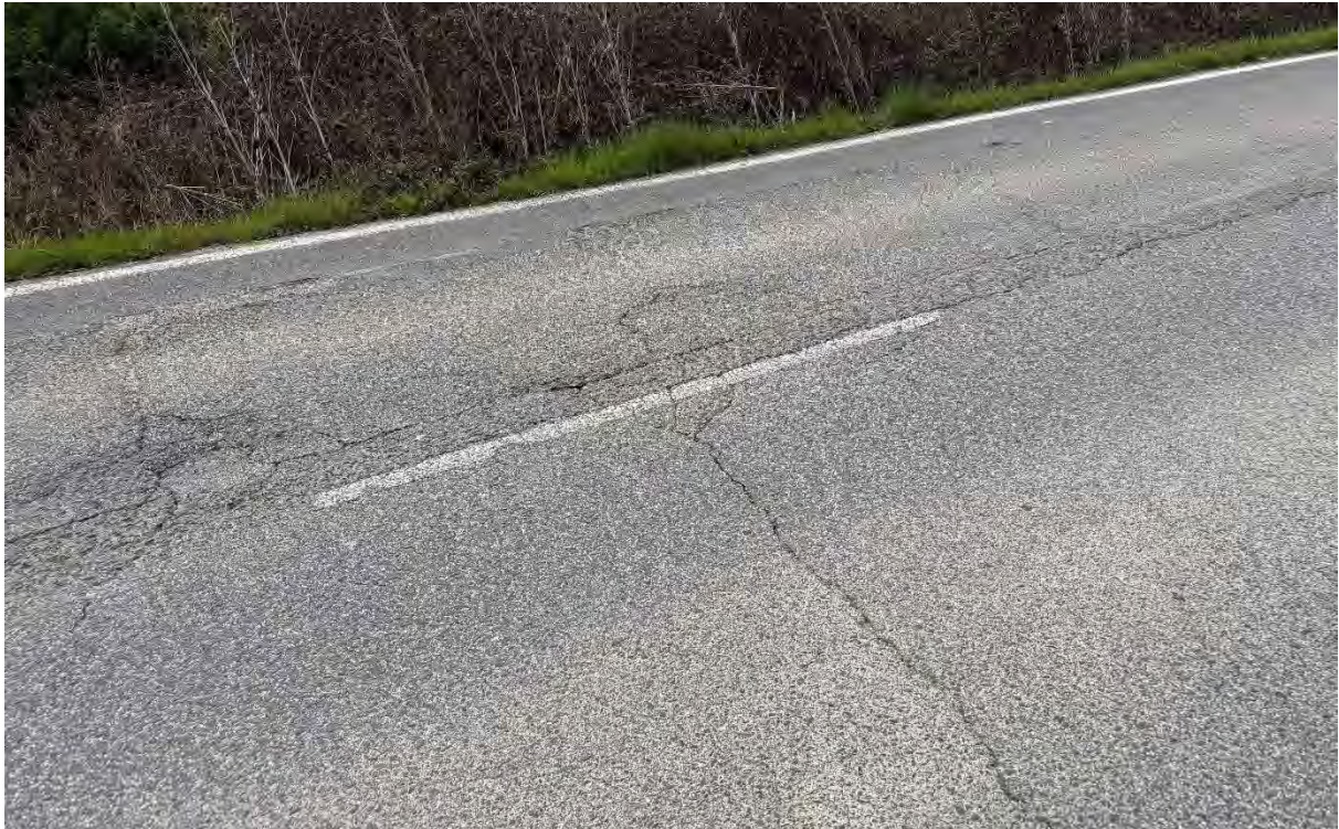
PK 0+152. Pavimento dañado y asentamientos. (Parcheado 4).
