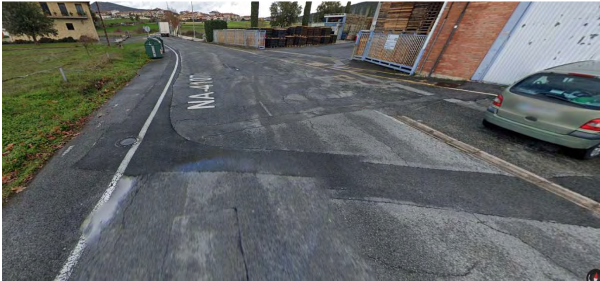
PK 0+025. Pavimento dañado por elzanjeado y asentamientos. (Parcheado 1).
