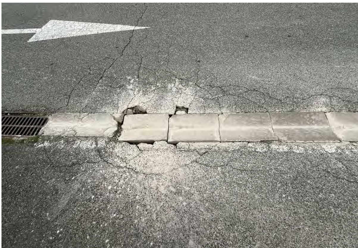
Parada bus 1: detalle del daños en caz y pavimento. Se observan reparaciones anteriores. (Parcheado 4).
