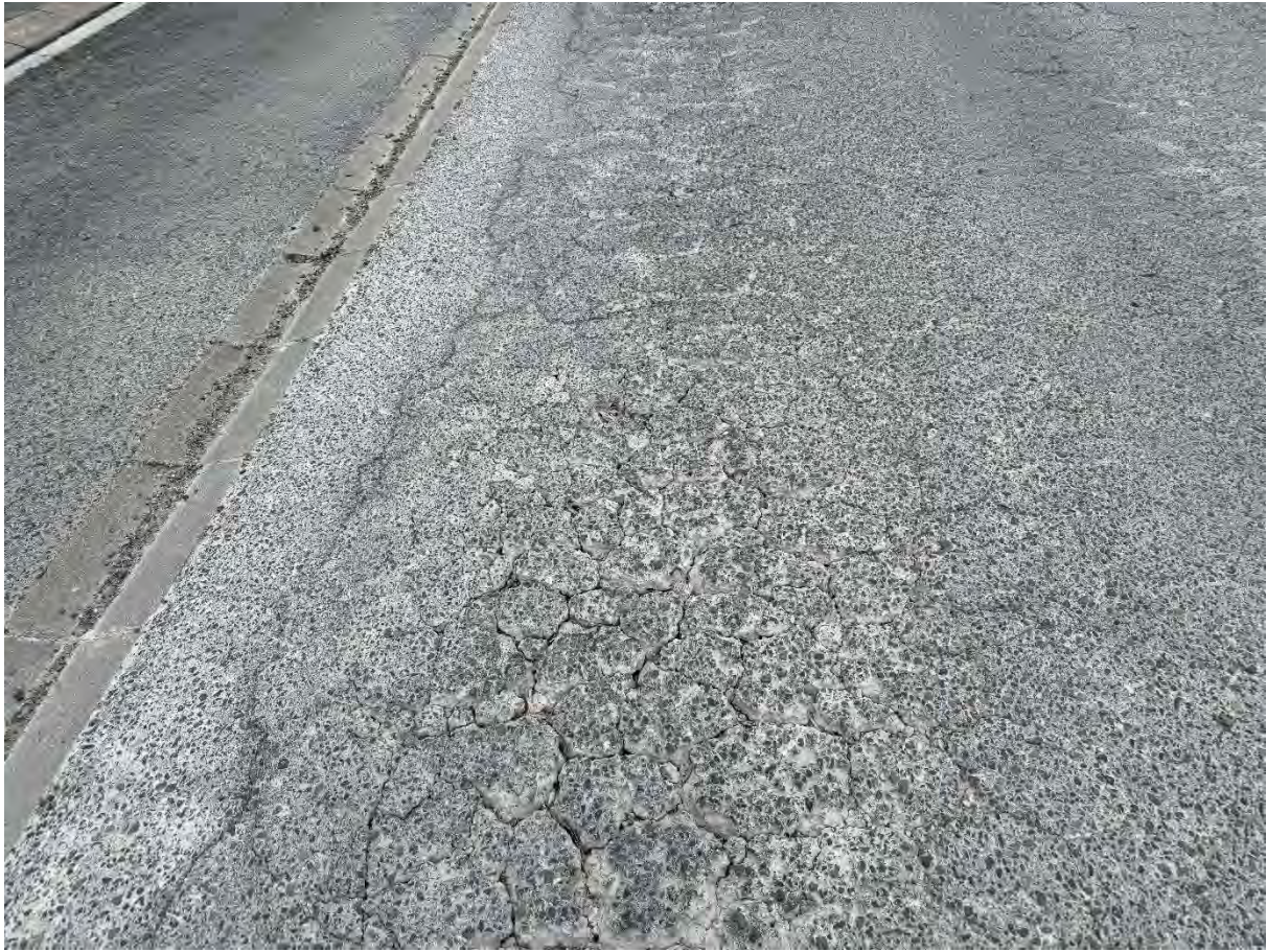
PK 0+570: detalle daños en pavimento (parcheado 33).
