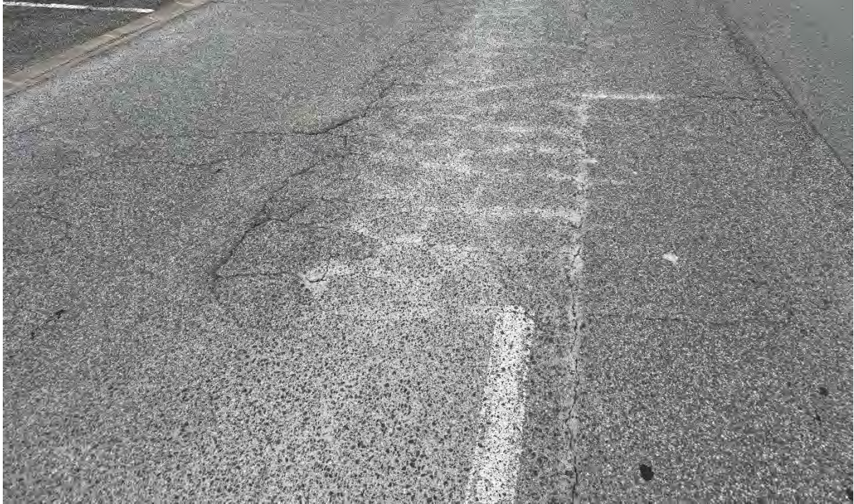
PK 0+272: daños en pavimento (parcheado 15).
