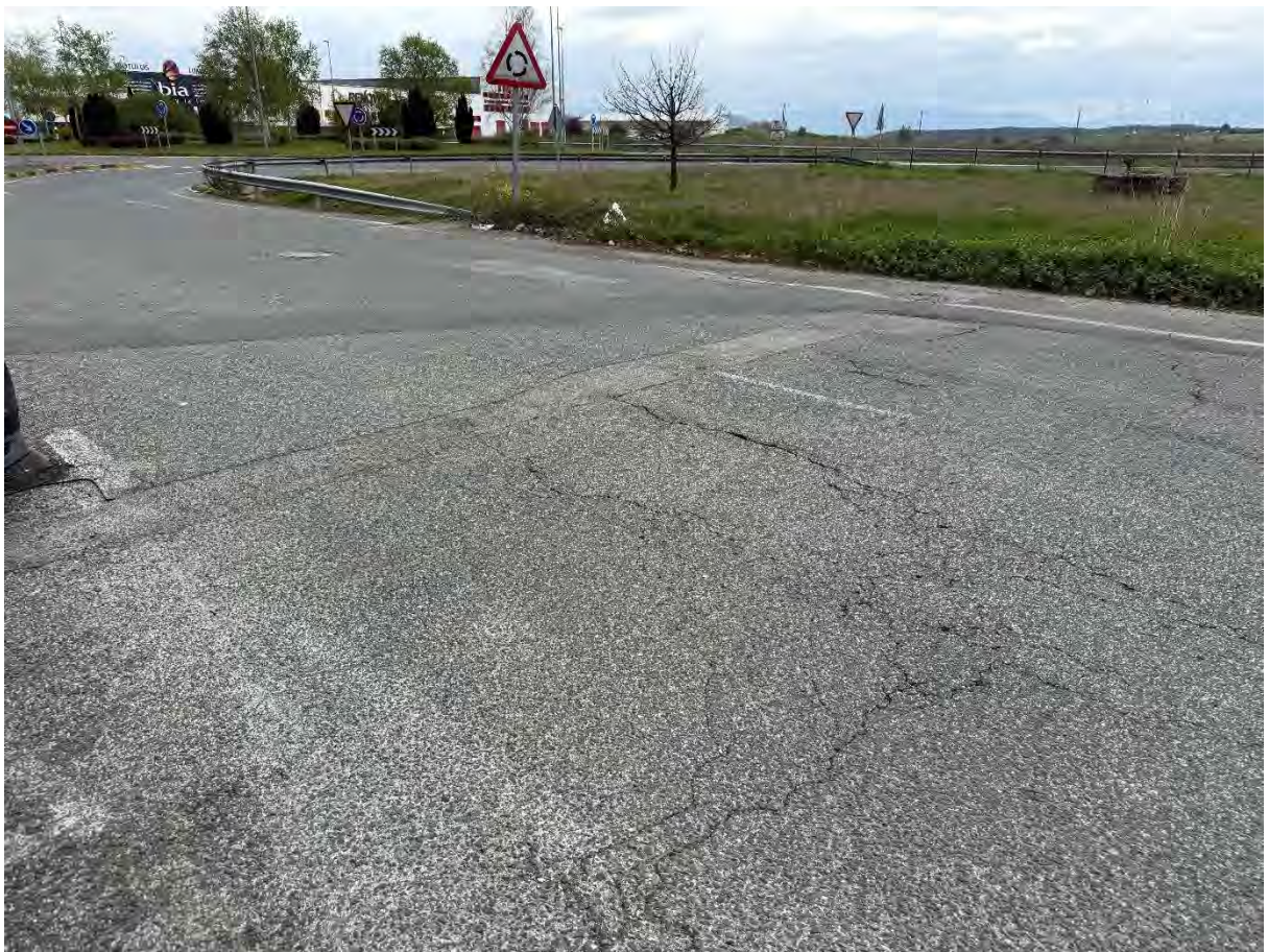
PK 0+025. Pavimento dañado por elzanjeado y asentamientos. (Parcheado 1).
