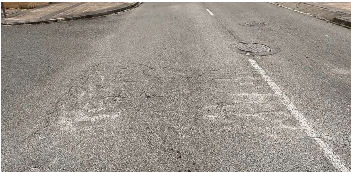
PK 0+255: daños en pavimento (parcheado 14).
