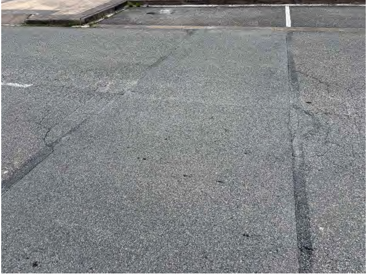
PK 0+220: daños en pavimento (parcheado 13)
