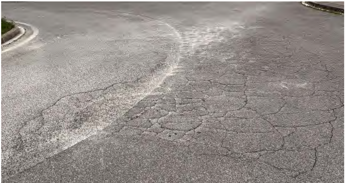
Detalle de los daños en el pavimento de la rotonda. (Parcheado 2).
