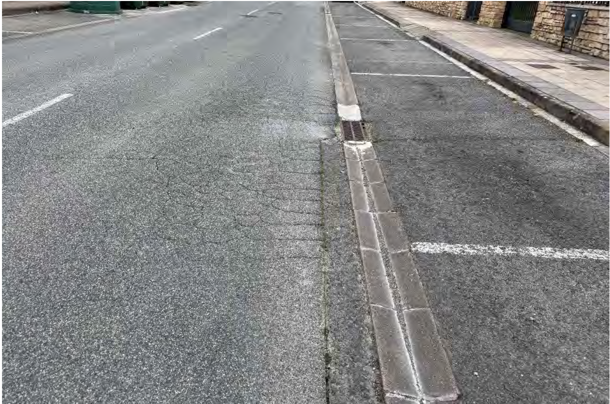
PK 0+345: daños en pavimento y caz (parcheado 19).
