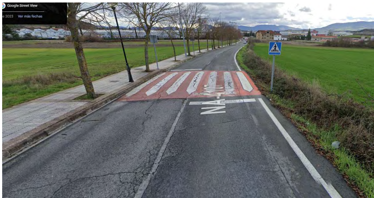
PK 0+299. Pavimento dañado y agrietado. Asentamientos. (Parcheado 9).
