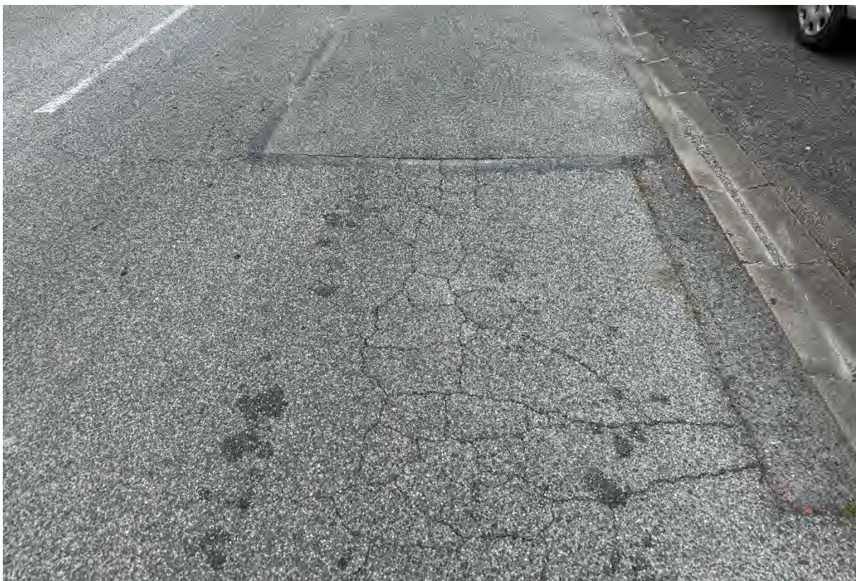
PK 0+405: daños en pavimento (parcheado 23).
