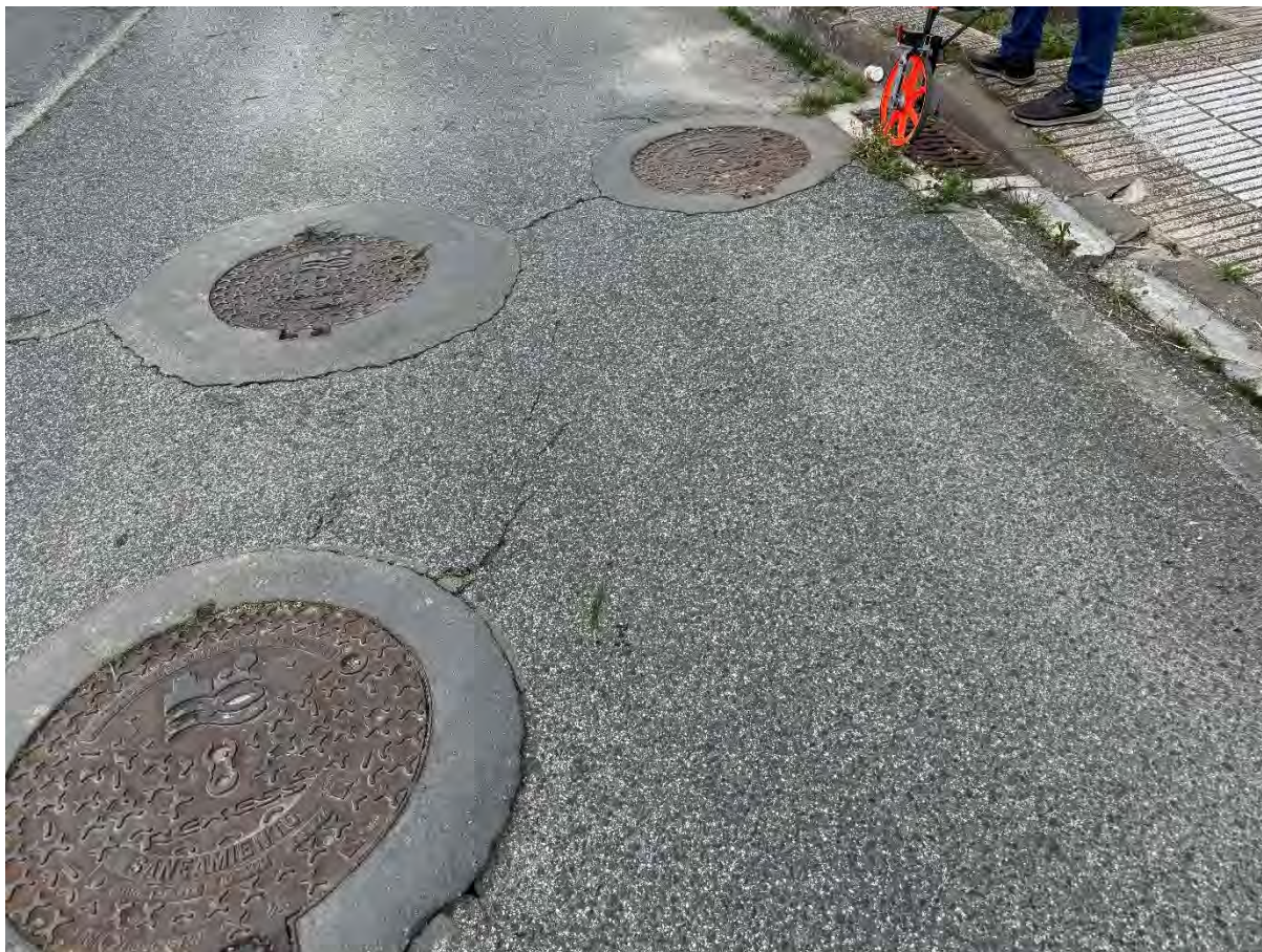
PK 0+312. Pavimento dañado y agrietado. Asentamientos. (Parcheado 11).
