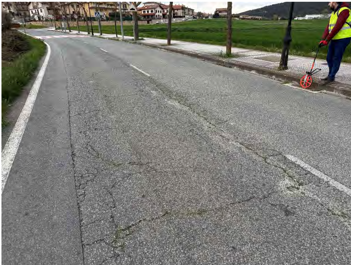
PK 0+258. Pavimento dañado y asentamientos. (Parcheado 8).
