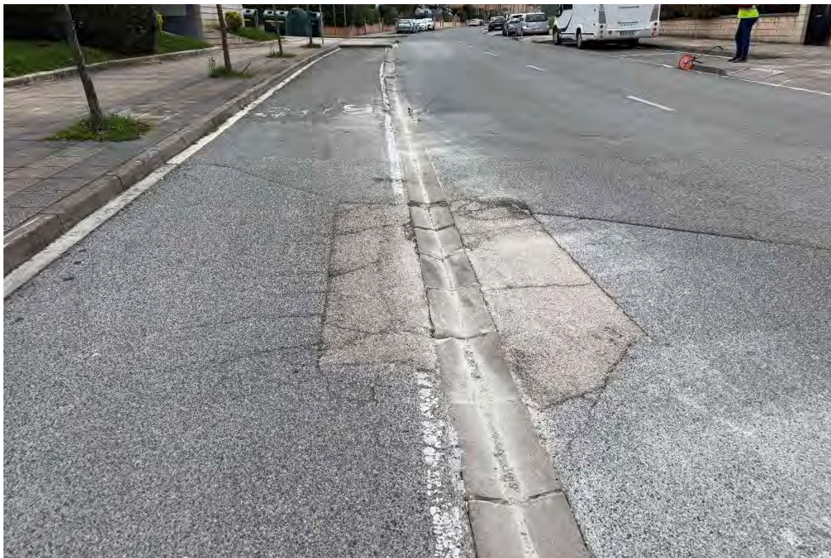
Parada bus 2: detalle de daños en caz y pavimento. Se observan reparaciones anteriores. (Parcheado 5).
