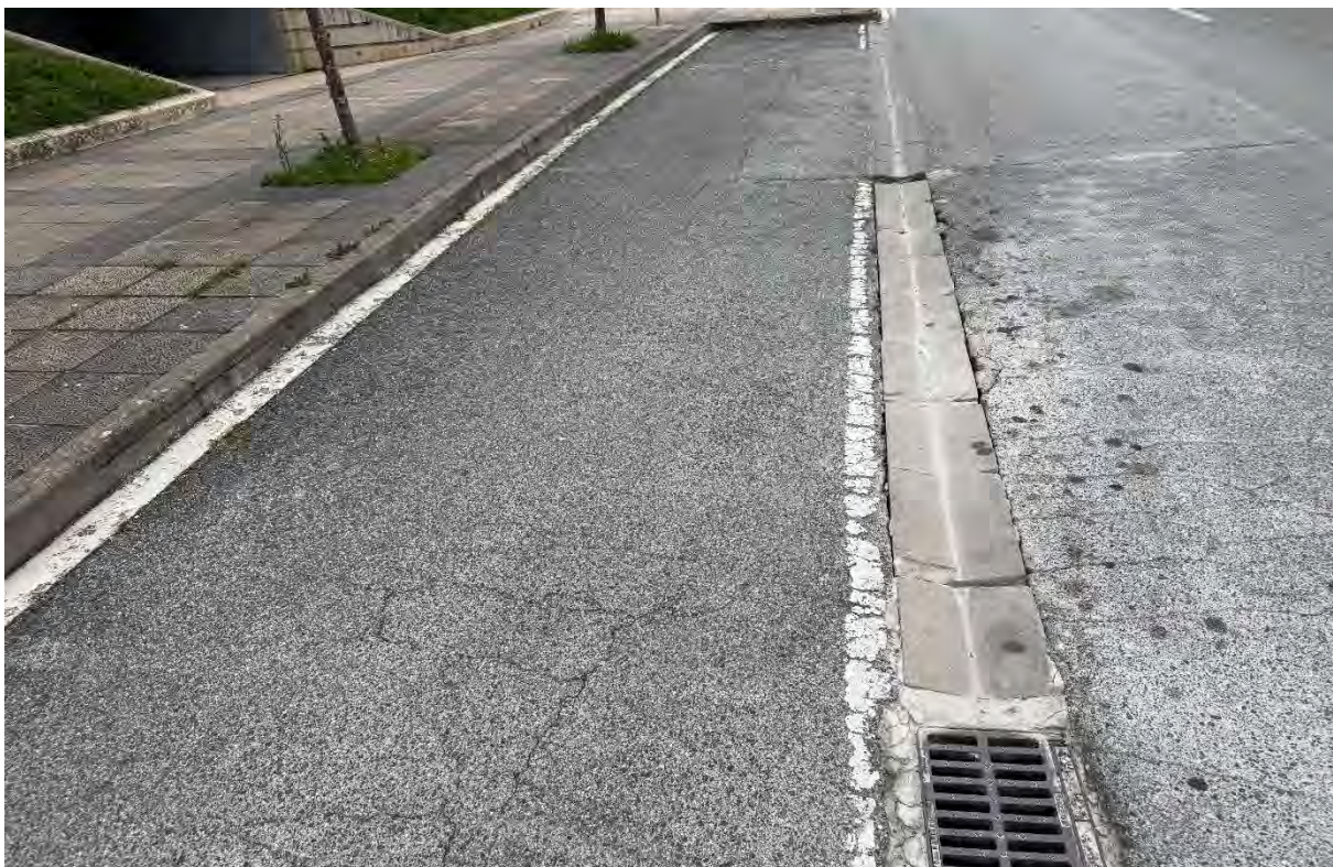
Parada bus 2: detalle de daños en caz y pavimento. Se observan reparaciones anteriores. (Parcheado 5).
