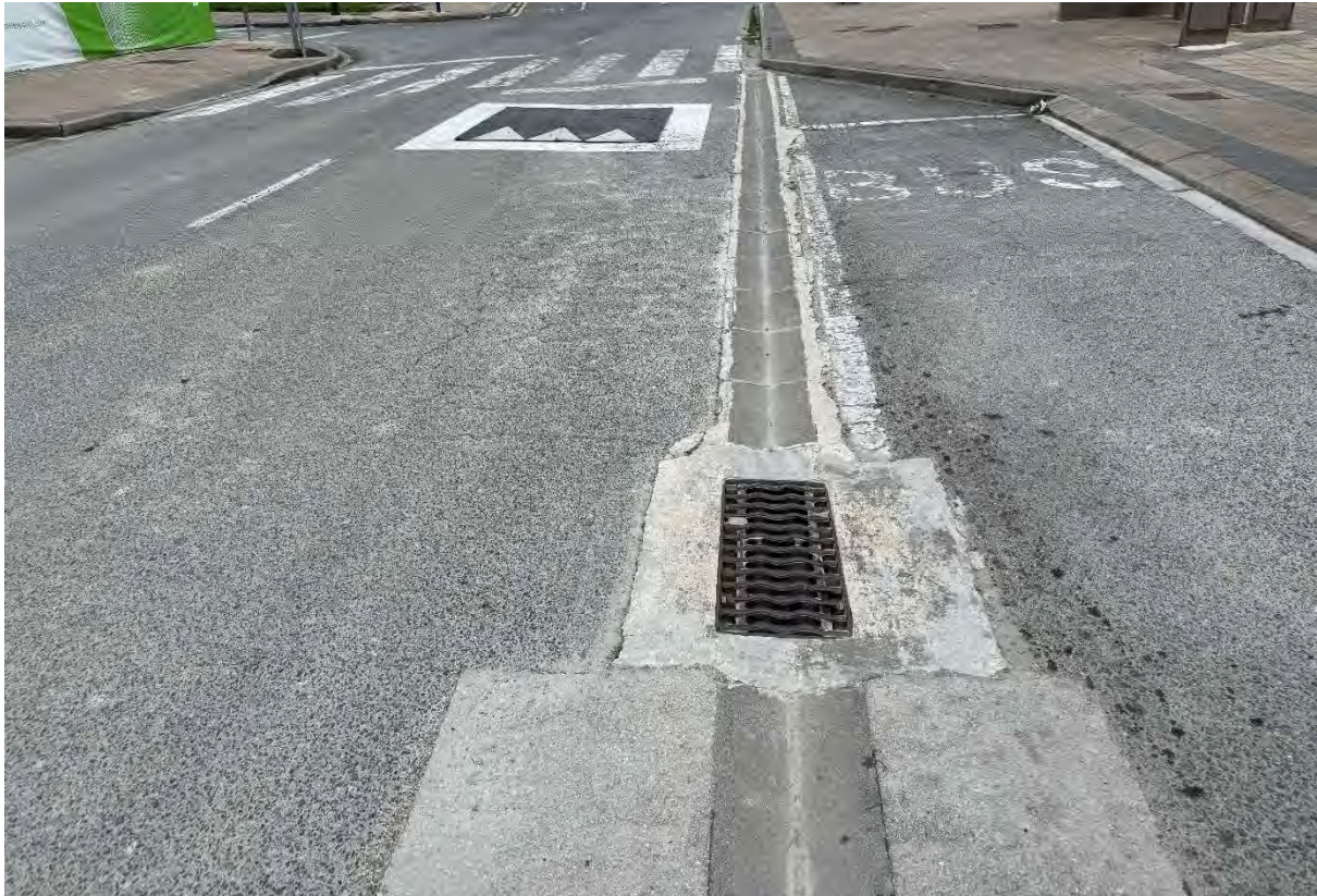
PK 0+710: daños en pavimento (parcheado 40).
