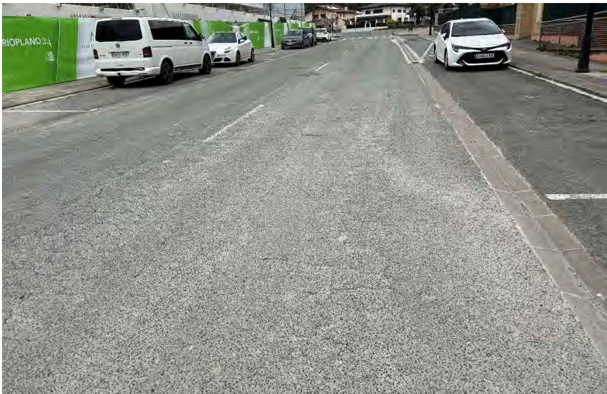
PK 0+668: daños en pavimento (parcheado 38.1).
