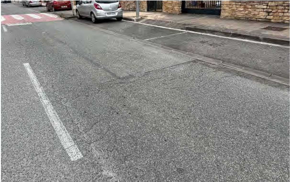
PK 0+370: daños en pavimento (parcheado 21).
