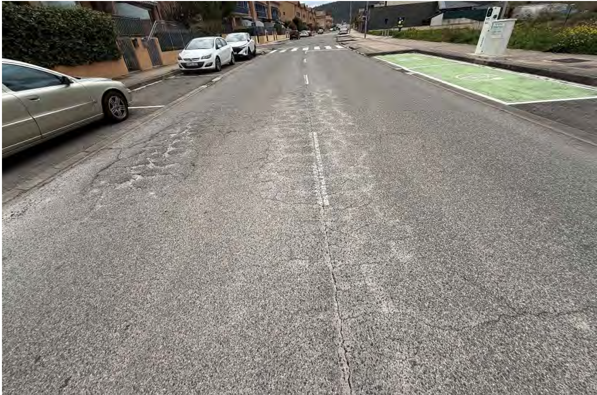
PK 0+170: daños en pavimento. (Parcheado 9).
