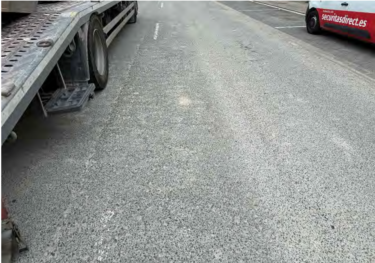
PK 0+649: daños en pavimento (parcheado 38).
