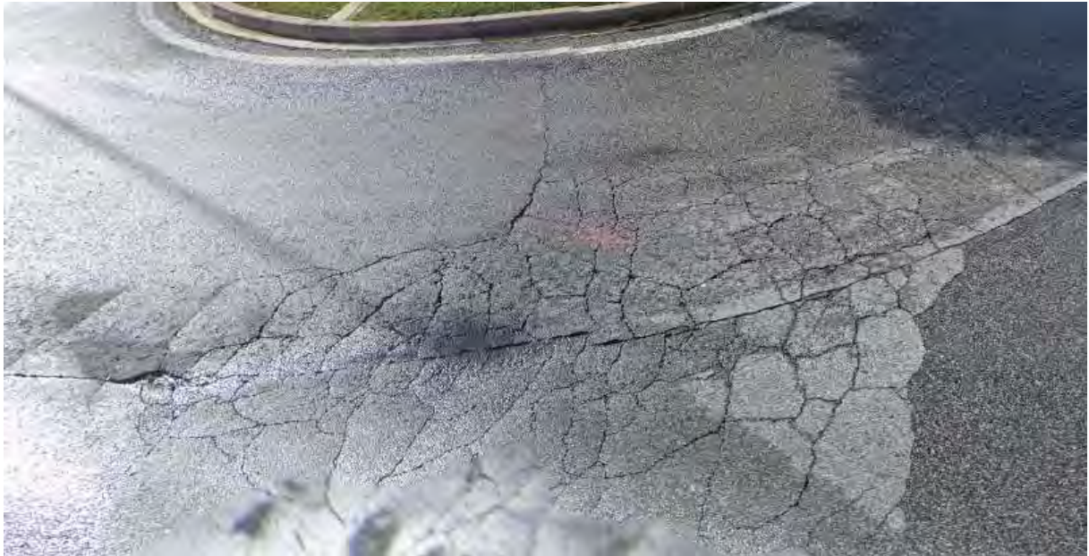
Detalle de los daños en el pavimento. (Parcheado 2).
