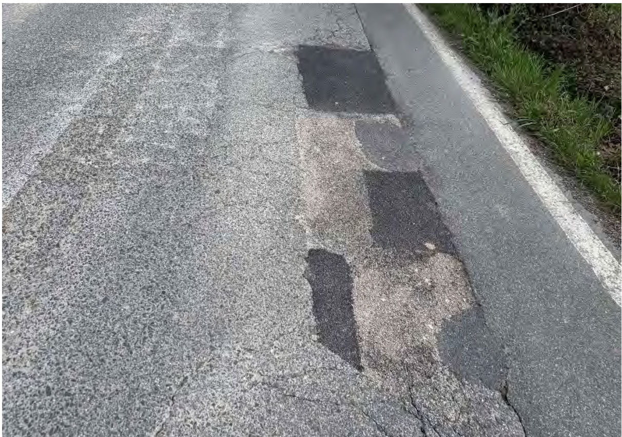
PK 0+186. Pavimento dañado y asentamientos. Reparaciones recientes. (Parcheado 5).
