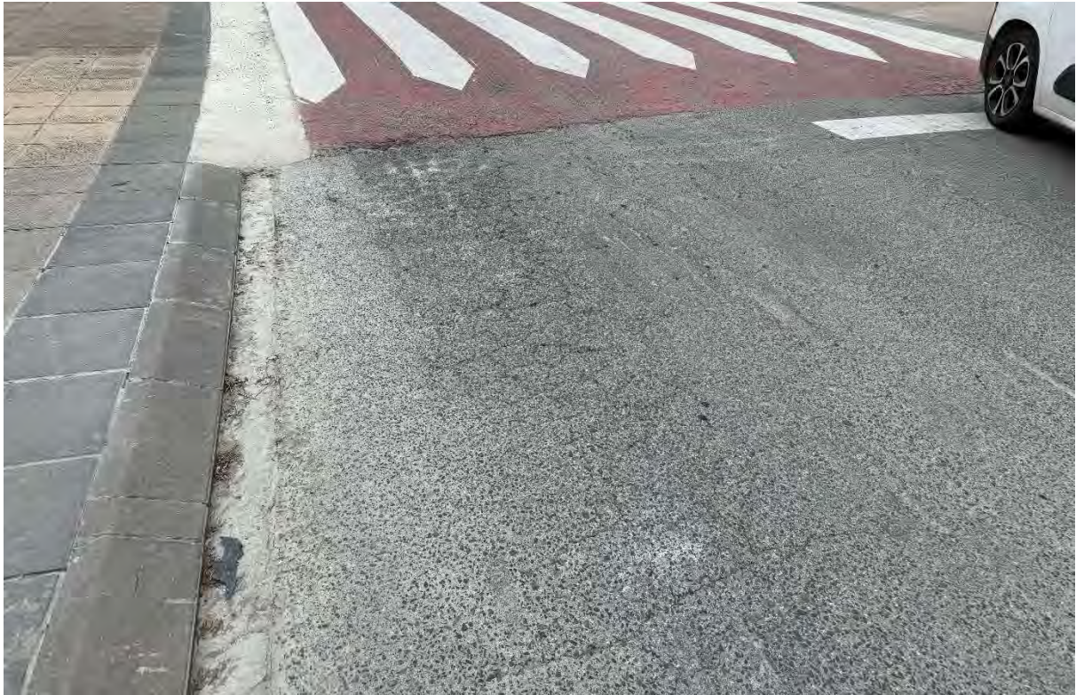
PK 0+596: daños en pavimento (parcheado 35).
