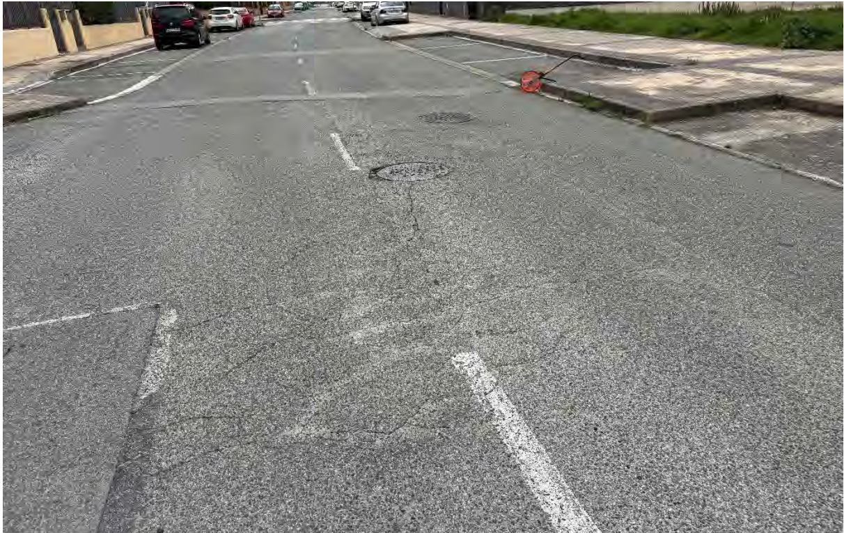
PK 0+205: daños en pavimento (parcheado 11.1)
