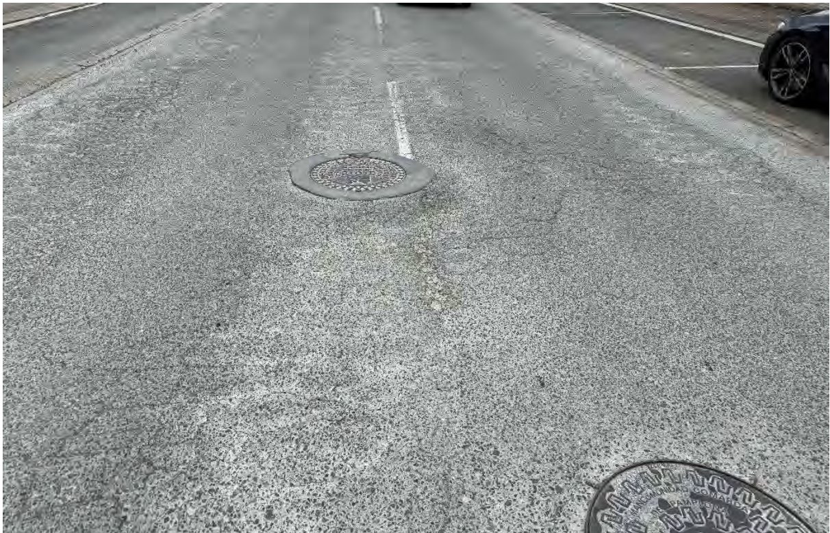
PK 0+570: daños en pavimento (parcheado 33).
