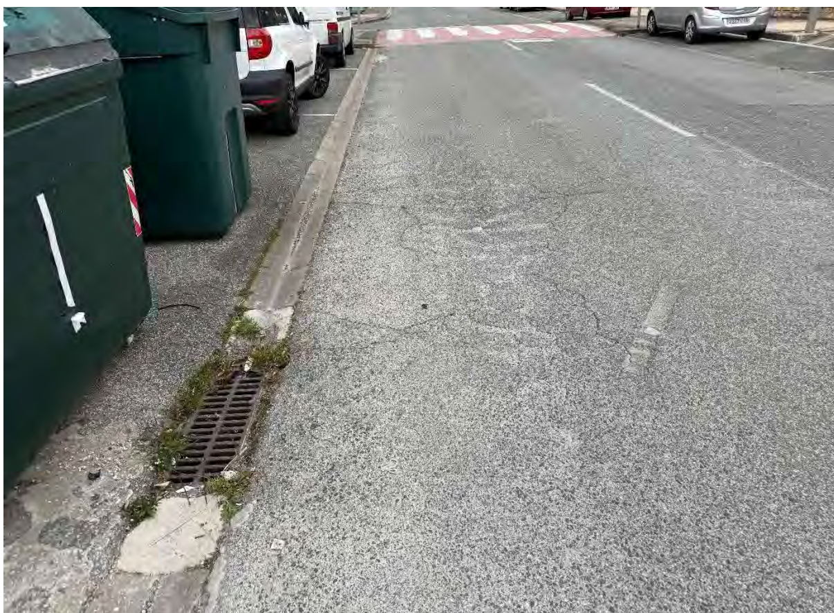
PK 0+345: daños en pavimento y caz (parcheado 20), a causa del camión de recogida de residuos.
