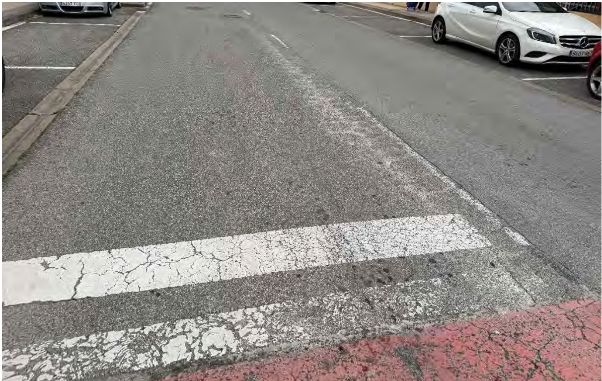
PK 0+246: daños en pavimento (parcheado 13.1)
