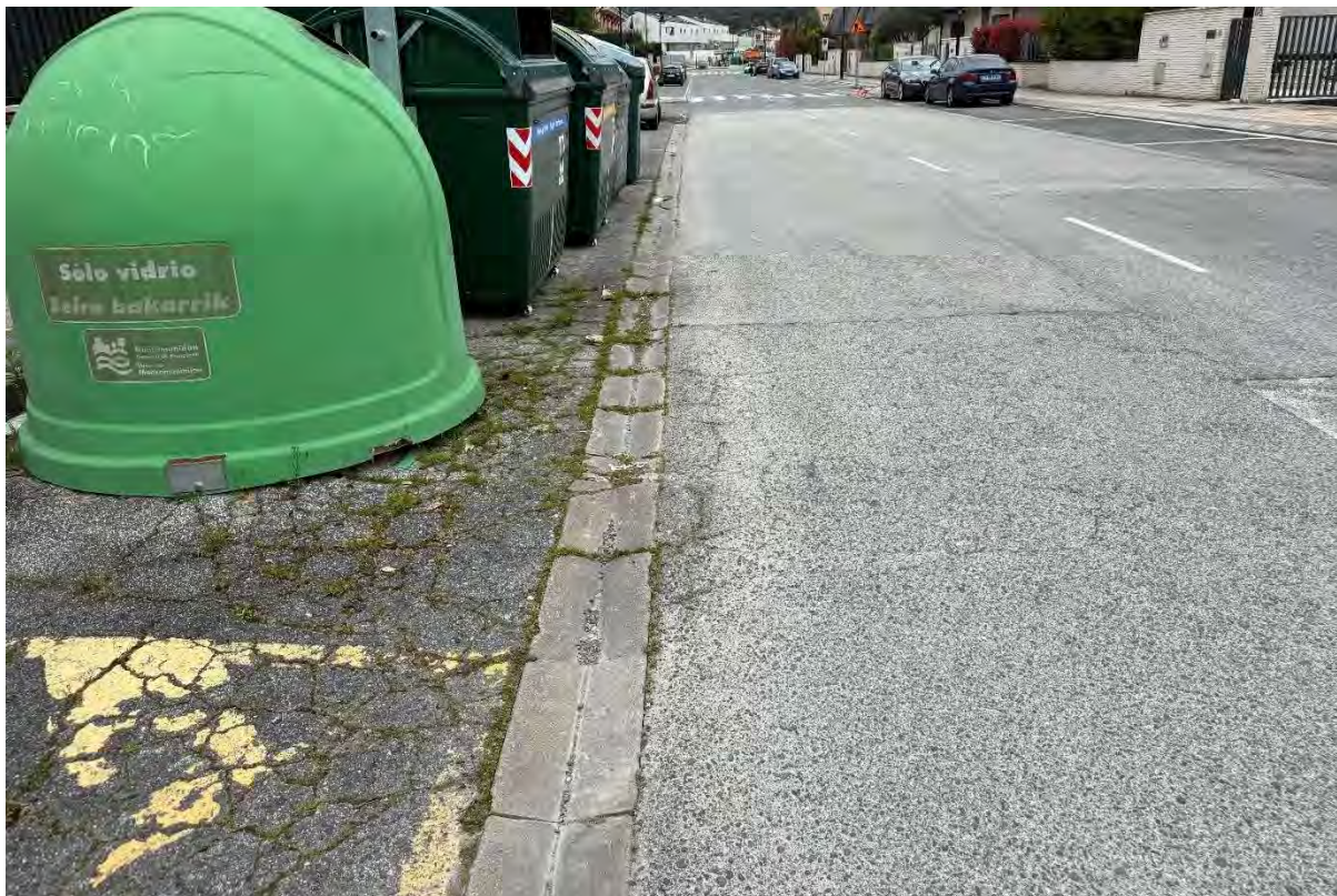
PK 0+447: daños en pavimento (parcheado 25). Parada 3 y contenedores de RU.
