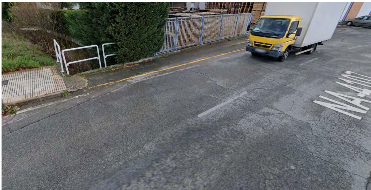
PK 0+071. Pavimento dañado por el zanjeado y asentamientos. Bajo esta zona cruza entubada la regata. (Parcheado 3).
