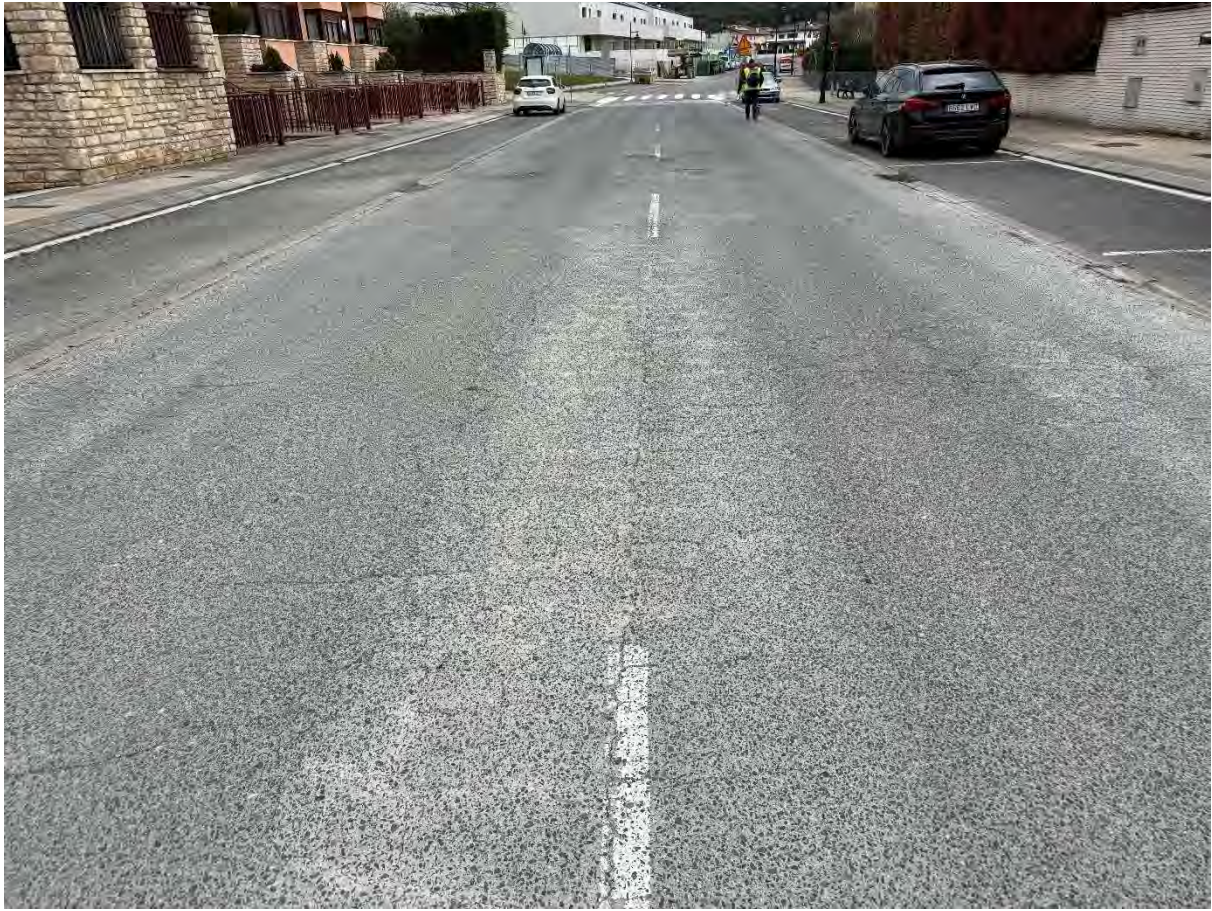
PK 0+560: daños en pavimento (parcheado 32).
