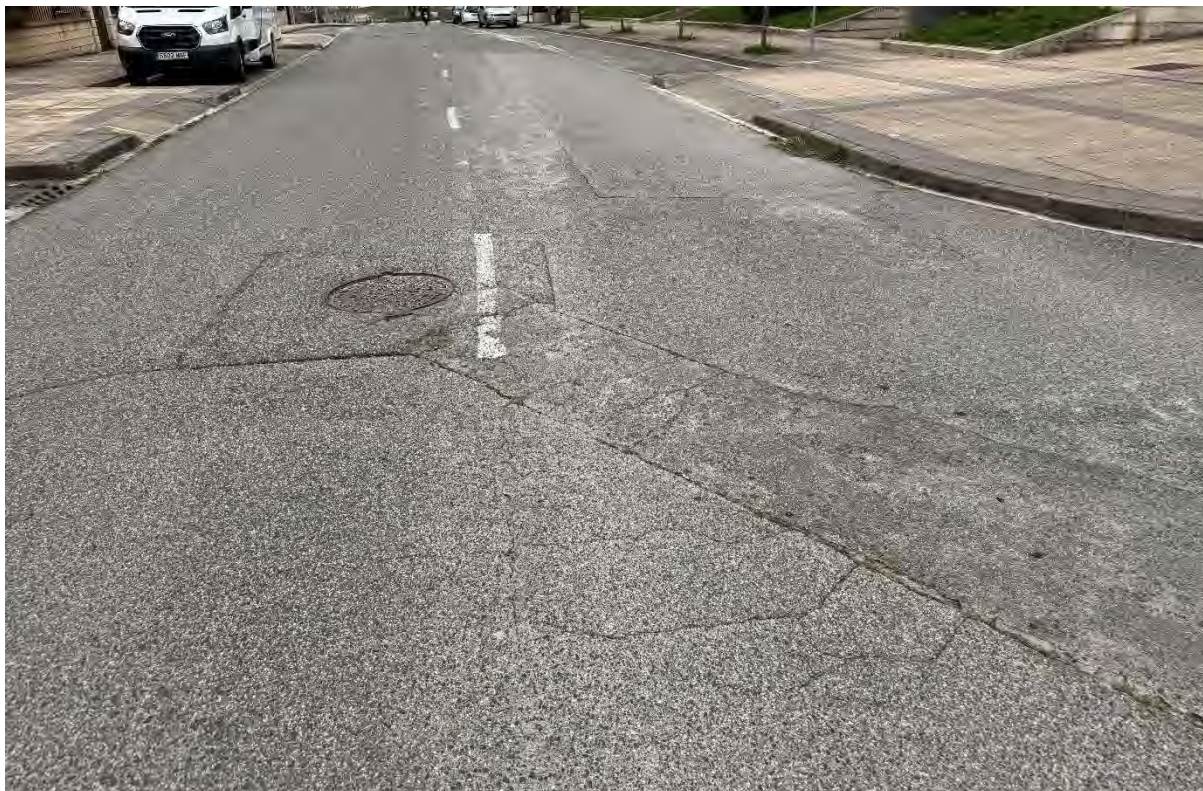
PK 0+137: daños en pavimento por zanjeado. (Parcheado 6 y 7).
