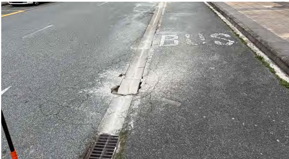
Parada bus 1: daños en caces y pavimentos. Se observan reparaciones. (Parcheado 4).
