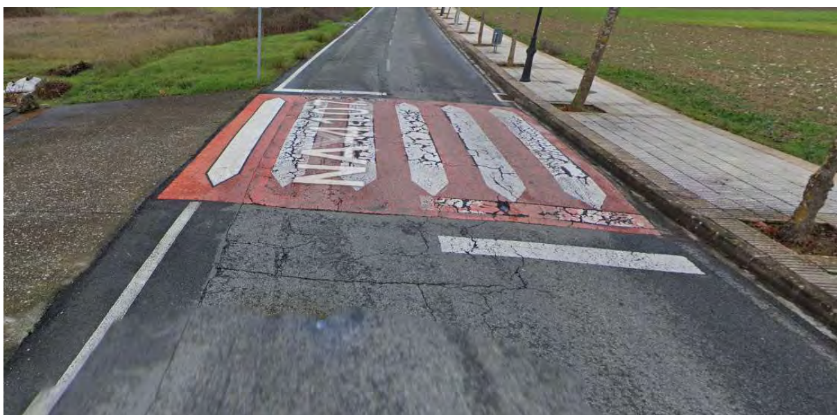
PK 0+108. Pavimento dañado y asentamientos. (Parcheado 3.1).
