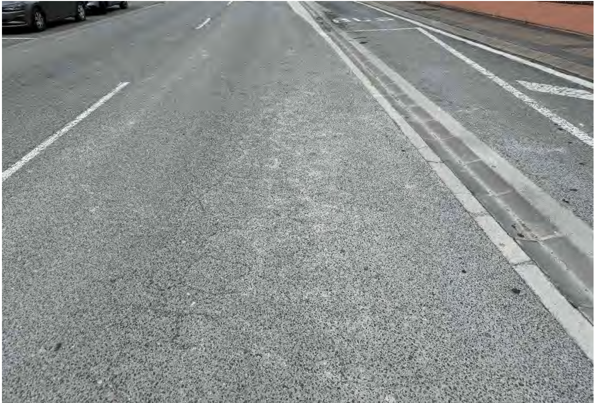
PK 0+660: daños en pavimento (parcheado 39).
