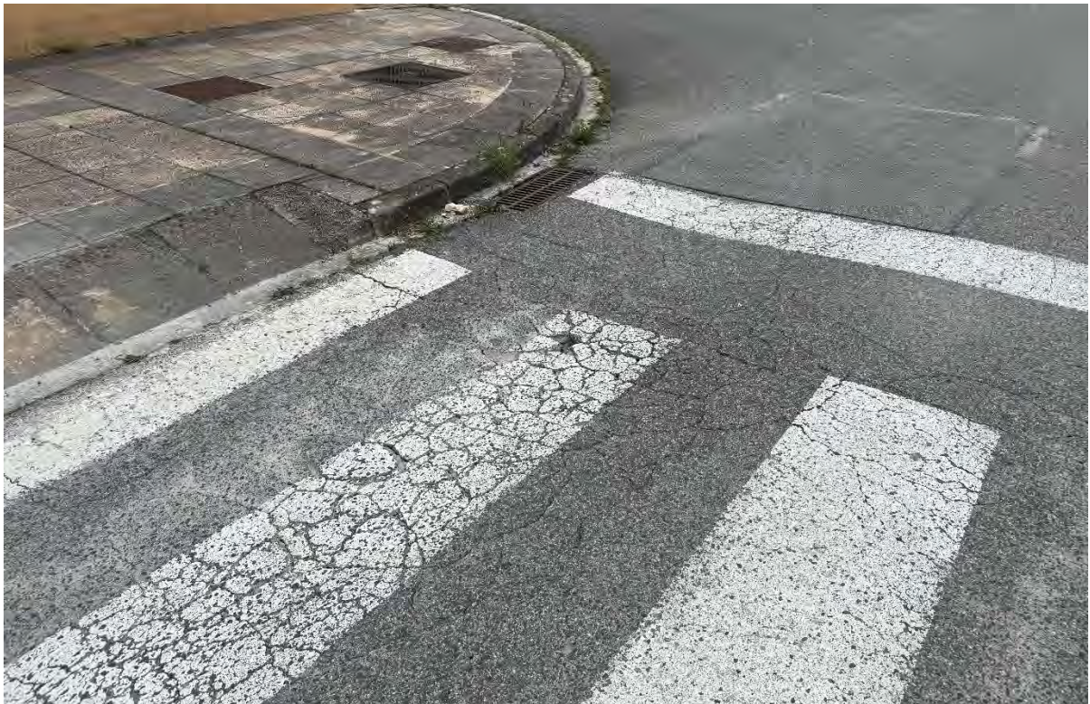
PK 0+200: daños en pavimento. ((Parcheado 11)).
