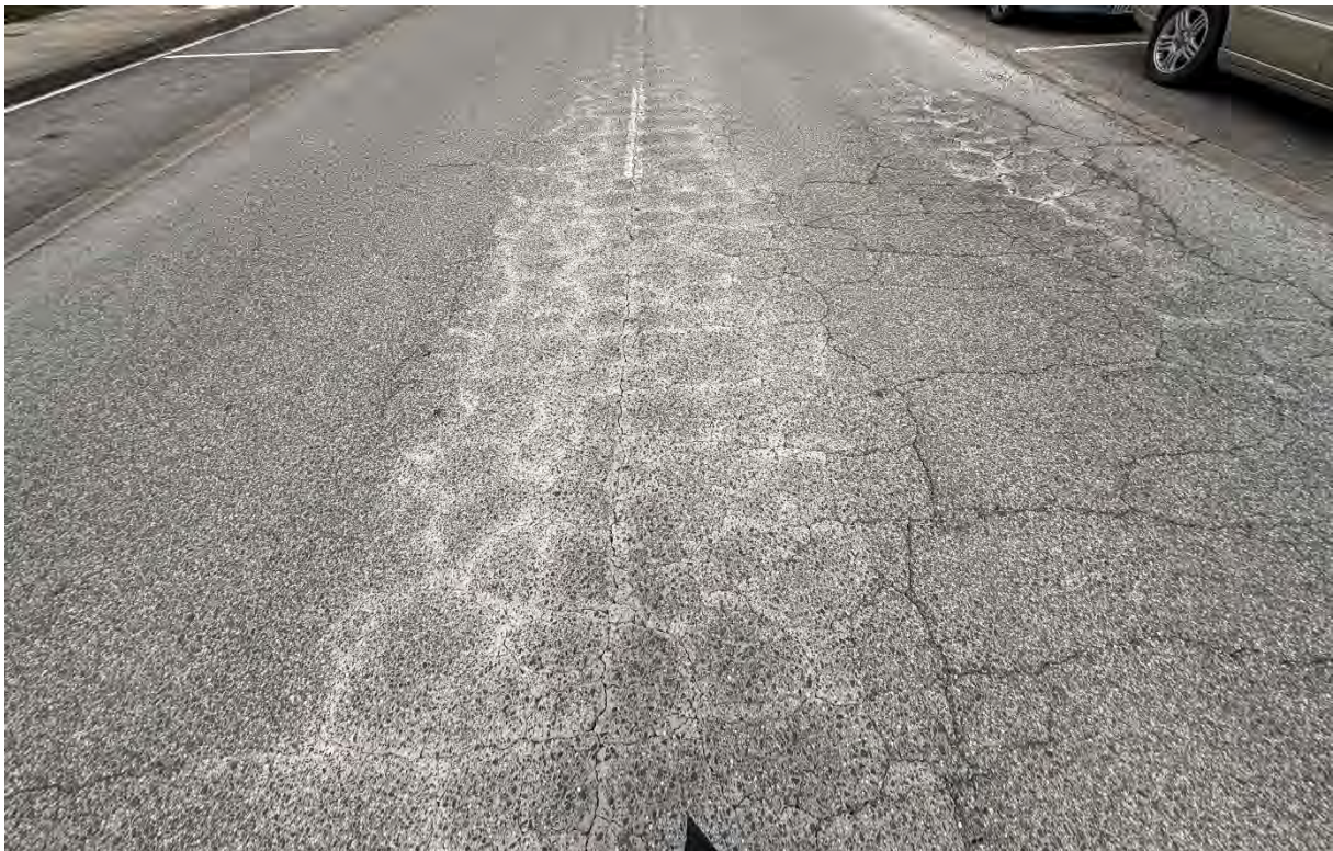
PK 0+170: daños en pavimento. (Parcheado 10).
