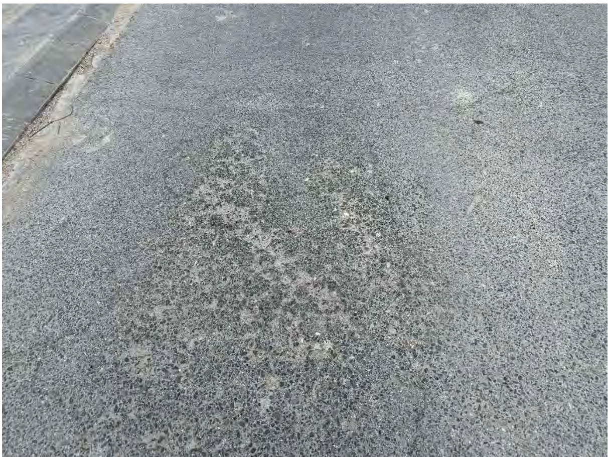
PK 0+640: daños en pavimento (parcheado 37).
