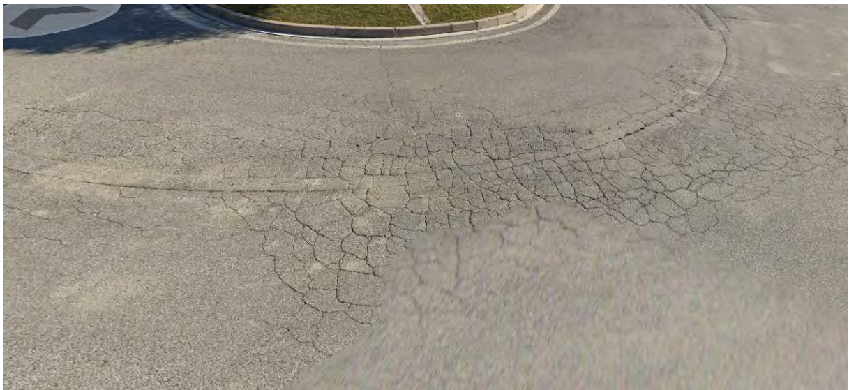
Detalle de los daños en el pavimento. (Parcheado 2).
