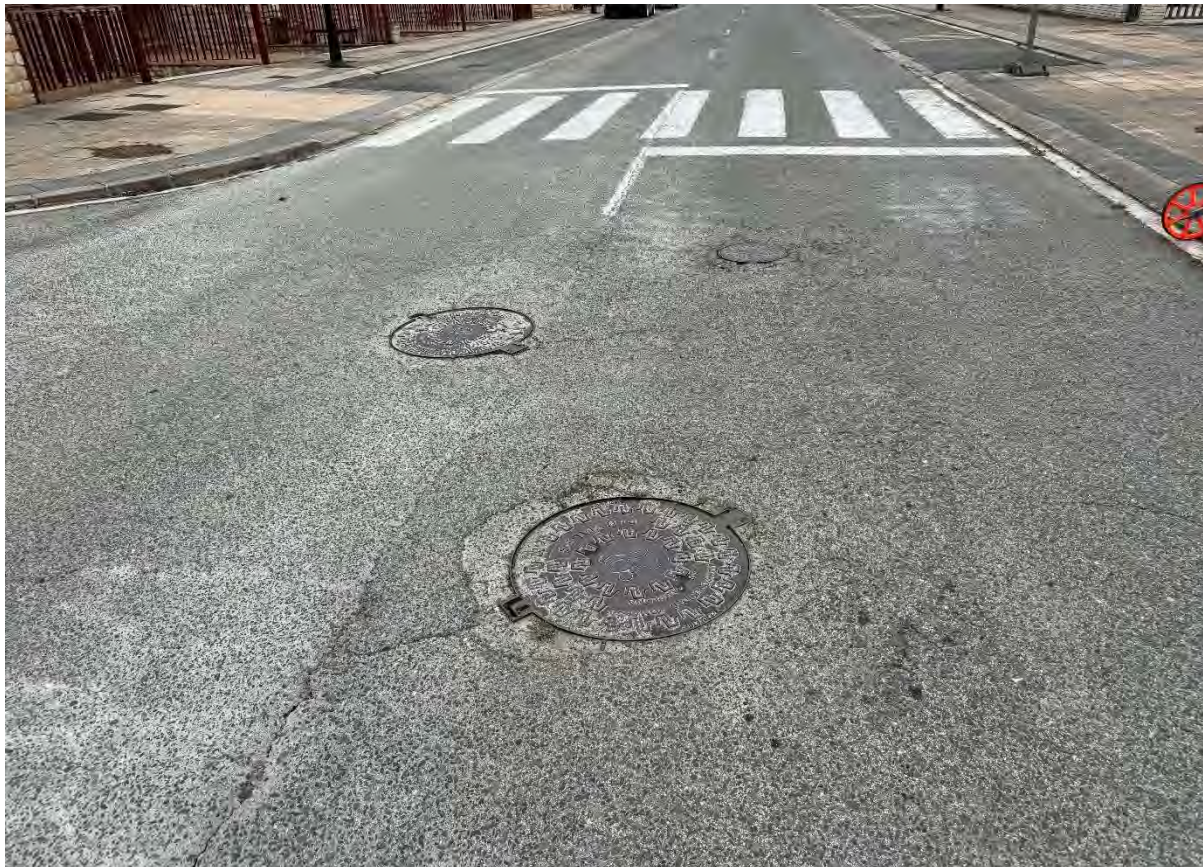
PK 0+447: daños en pavimento (parcheado 26).
