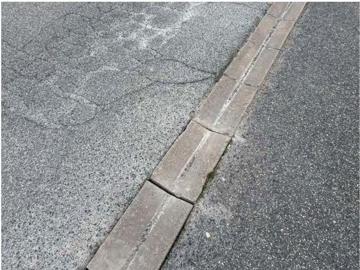
PK 0+280: daños en pavimento y caz (parcheado 16).
