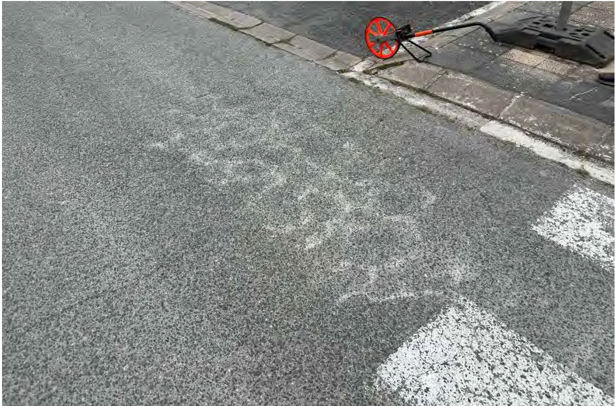
PK 0+476: daños en pavimento (parcheado 27).
