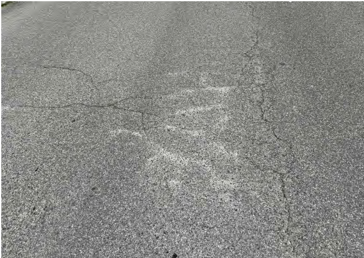
PK 0+335: daños en pavimento (parcheado 18.1).
