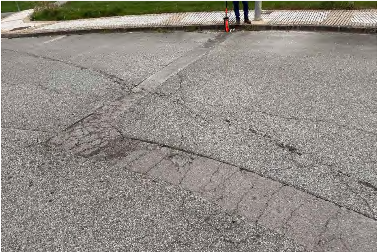
Detalle de los daños en el pavimento de la zanja del dren. (Parcheado 2).
