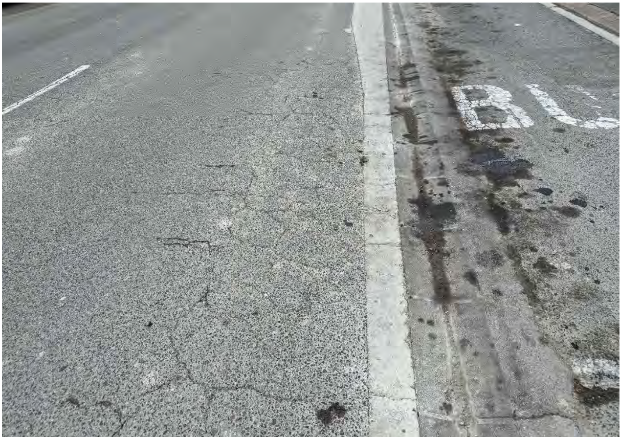
PK 0+660: daños en pavimento (parcheado 39).
