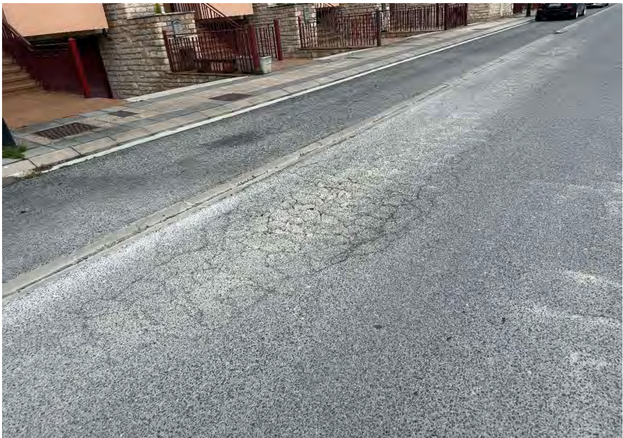
PK 0+476: daños en pavimento (parcheado 28).
