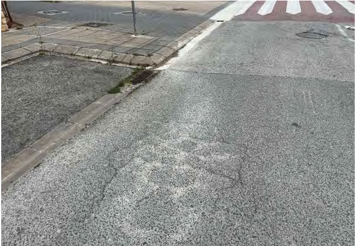
PK 0+583: daños en pavimento (parcheado 34).
