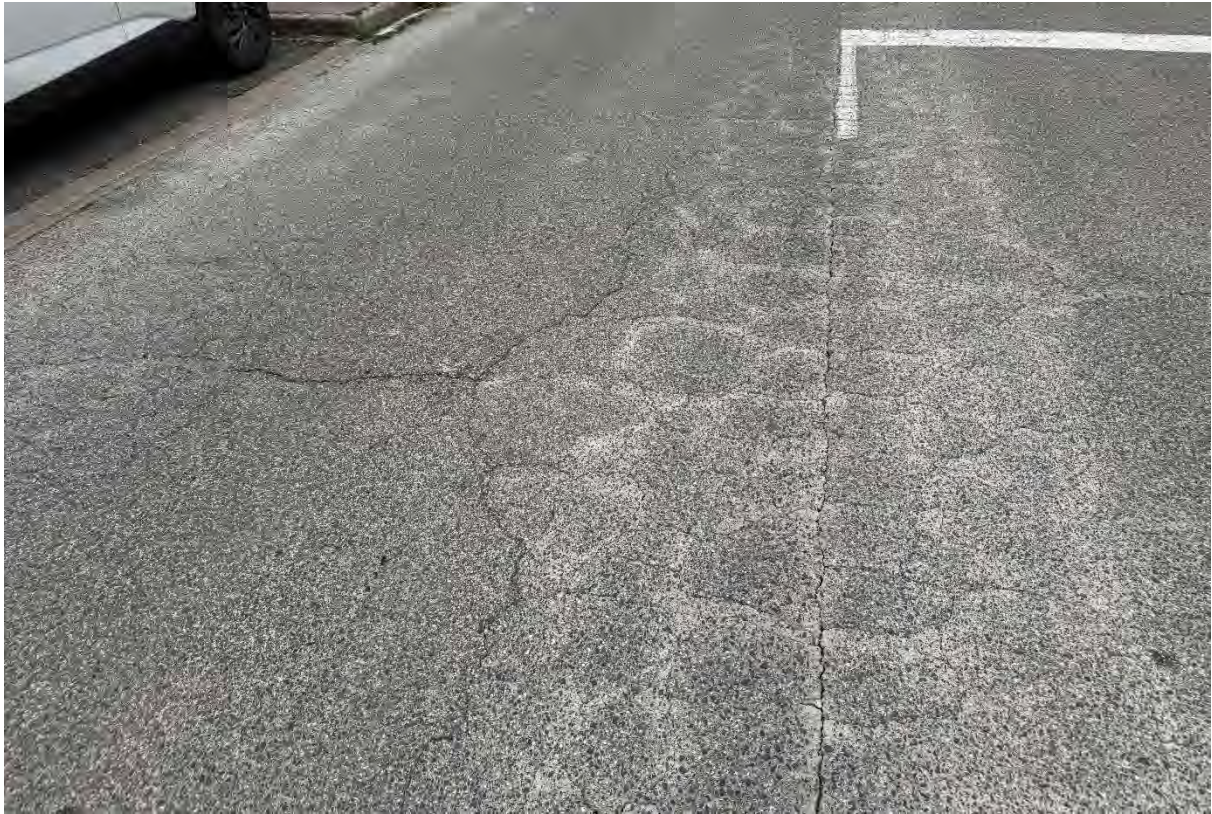
PK 0+180: daños en pavimento. (Parcheado 10).
