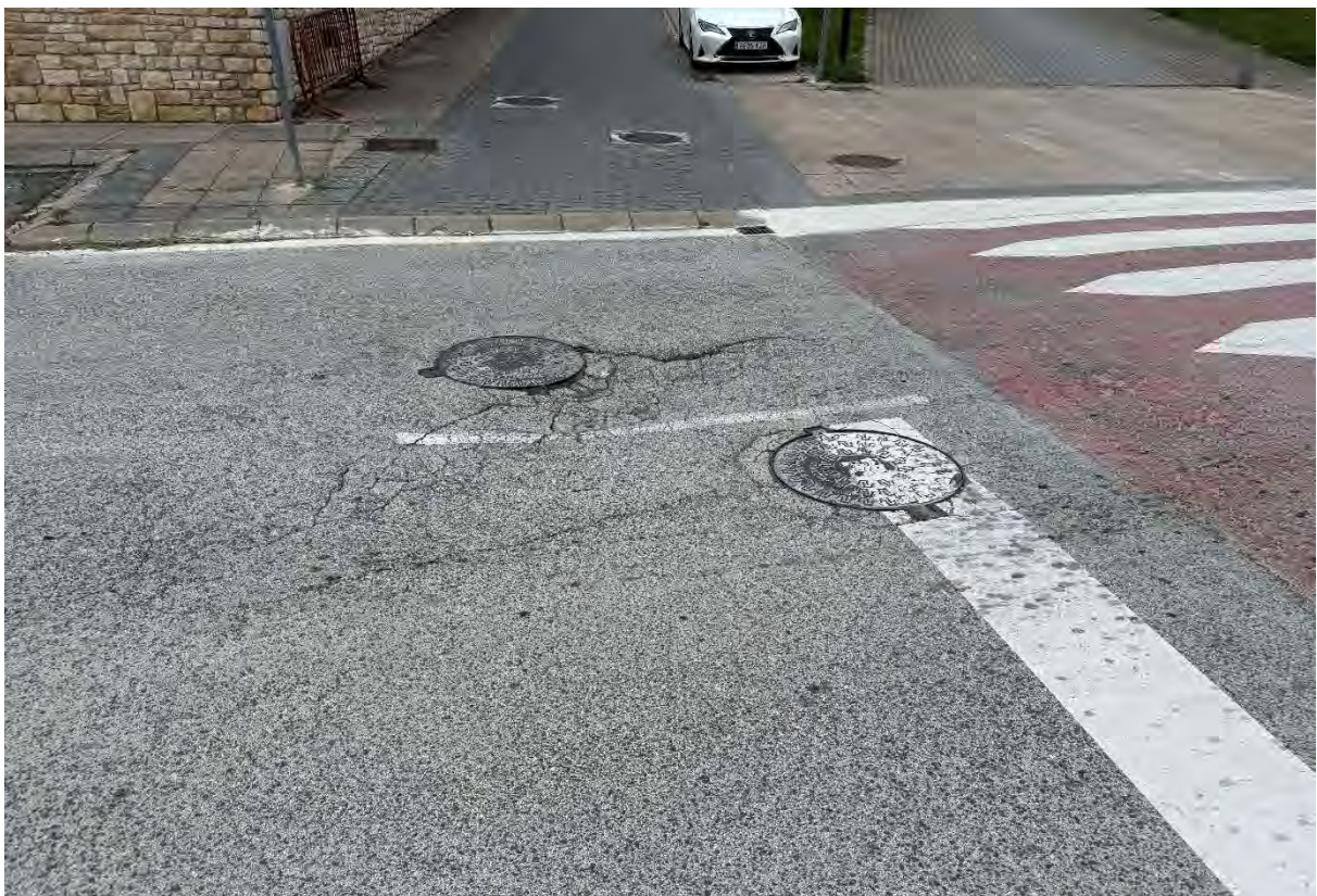
PK 0+570: daños en pavimento (parcheado 35).
