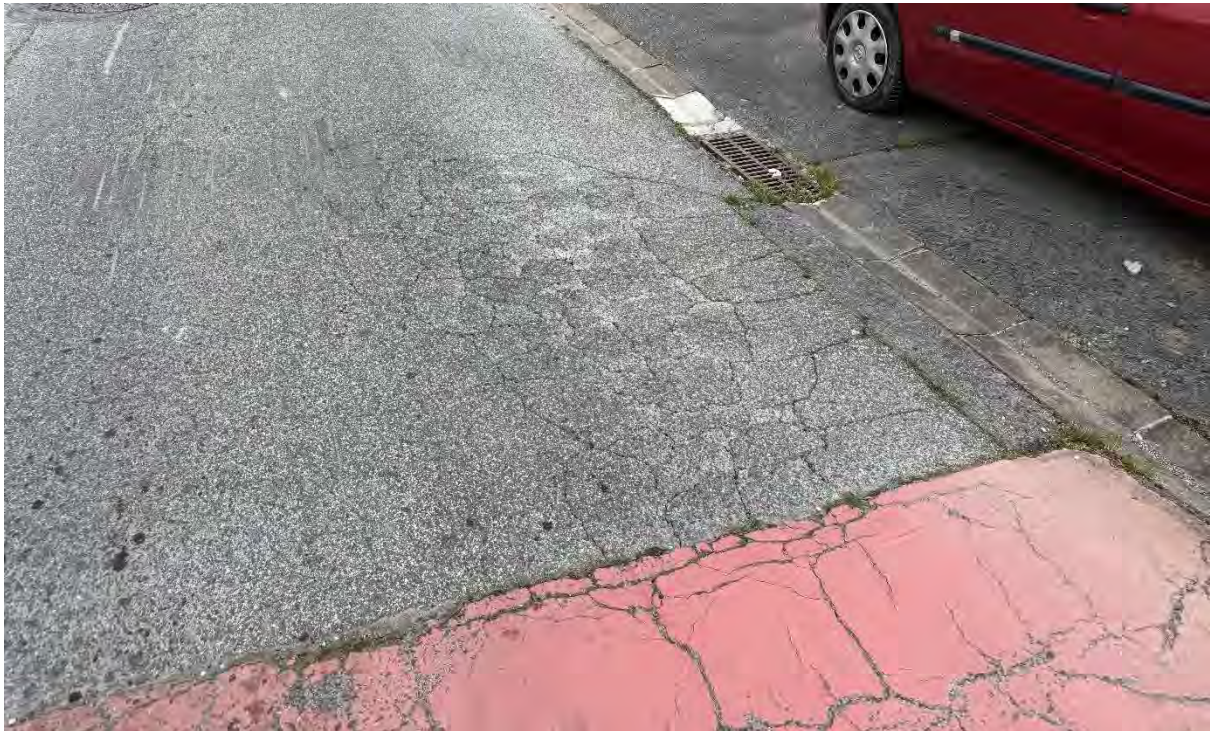
PK 0+389: daños en pavimento (parcheado 22).
