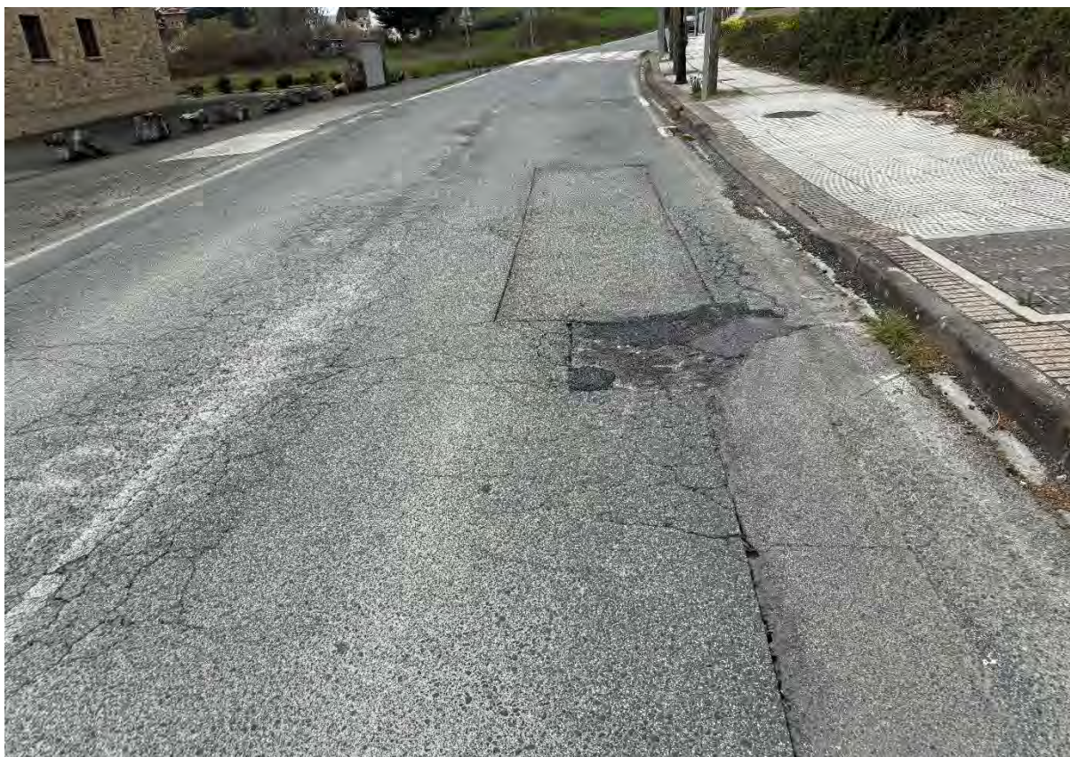
PK 0+071. Pavimento dañado por el zanjeado y asentamientos. Bajo esta zona cruza entubada la regata. (Parcheado 3).
