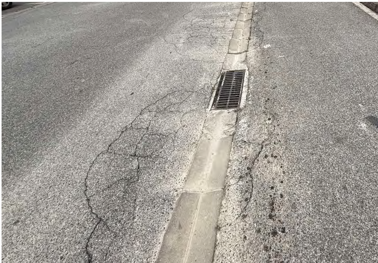
Parada bus 1: detalle de daños en caz y pavimento. Se observan reparaciones anteriores. (Parcheado 4).
