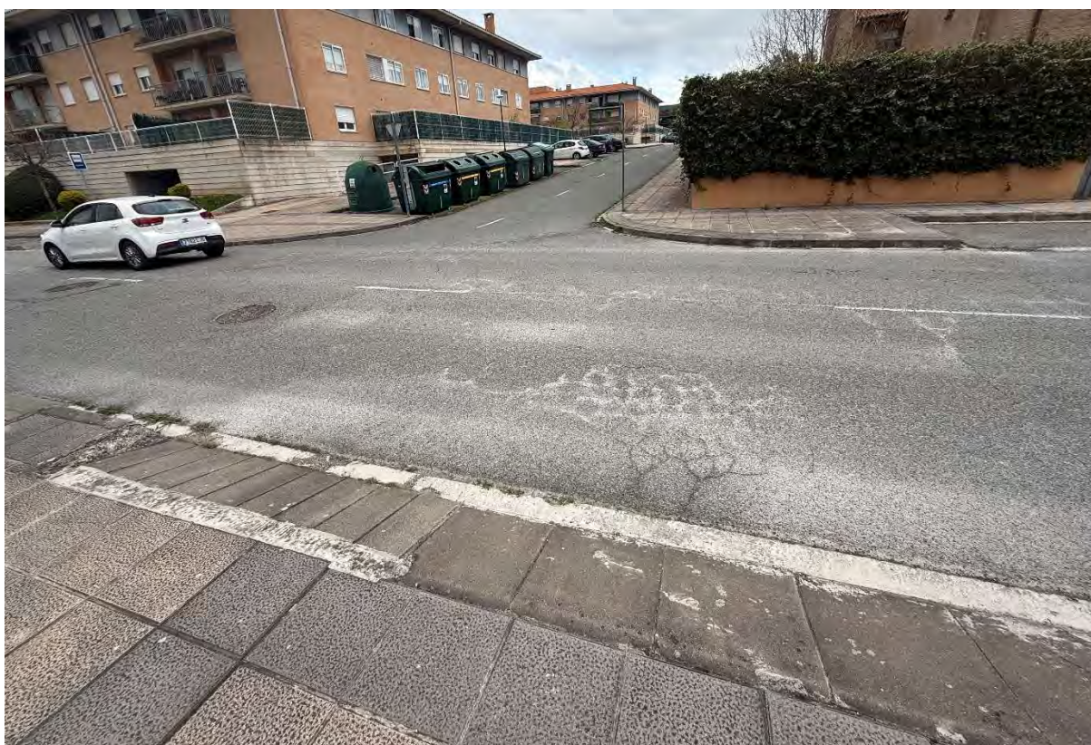
PK 0+150 daños en pavimento. (Parcheado 8).
