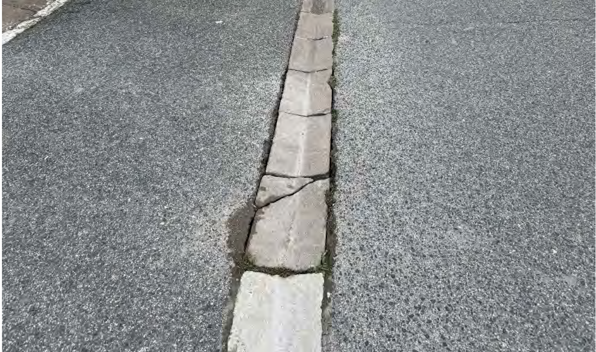
PK 0+290: daños en pavimento y caz. (parcheado 18).
