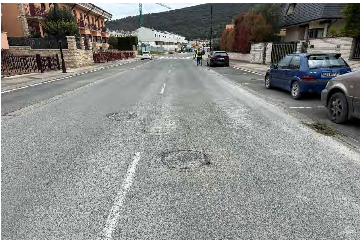
PK 0+550: daños en pavimento (parcheado 31). Salida de parada.
