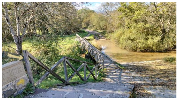
Estado del acceso a la pasarela de Xoringoa Ugaldea
