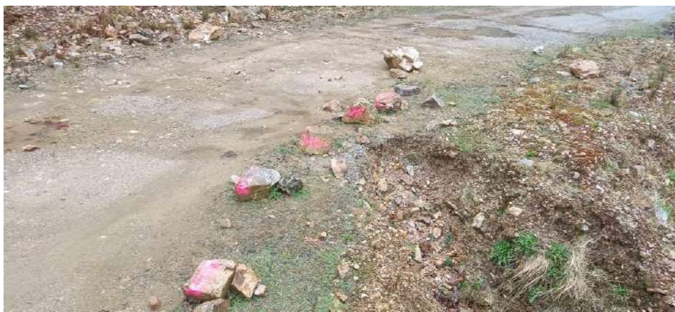
Camino a pastos extensos con desprendimiento
