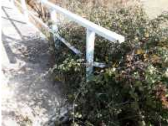
leve corrosión y deformación
