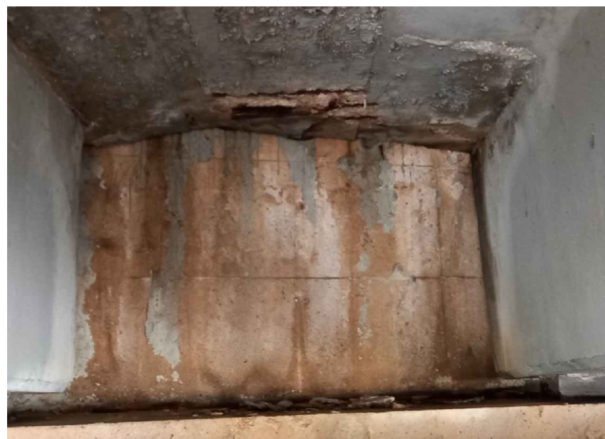
ESTADO ACTUAL TABLERO EN ZONA JUNTAS
