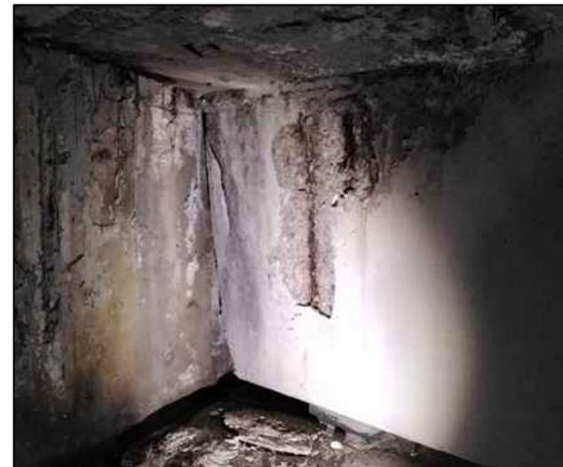
SITUACIÓN ACTUAL VIGAS
