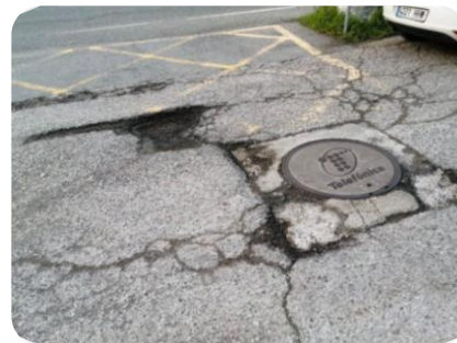
Foto 4: Nuevo agrietamiento/bache acceso Este
