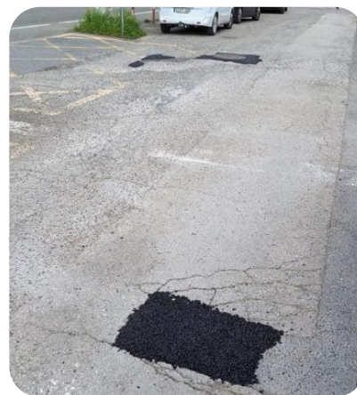
Foto 5: Reparcheo realizado en 2025
