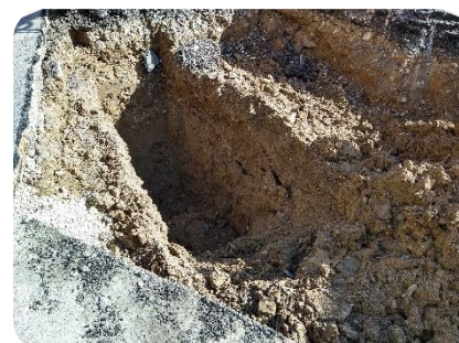
Foto 2: Excavación del terreno del hundimiento
