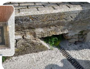
Foto 25 Salida PVC200 a rejilla
