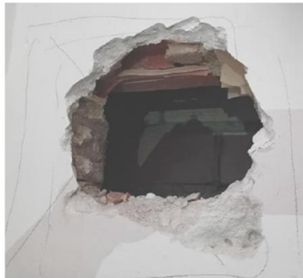
Apertura en medianera
