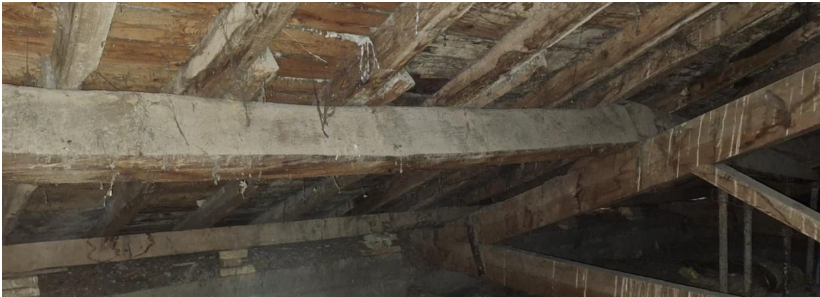
Vista de la afectación de vigas de madera en la actualidad.
