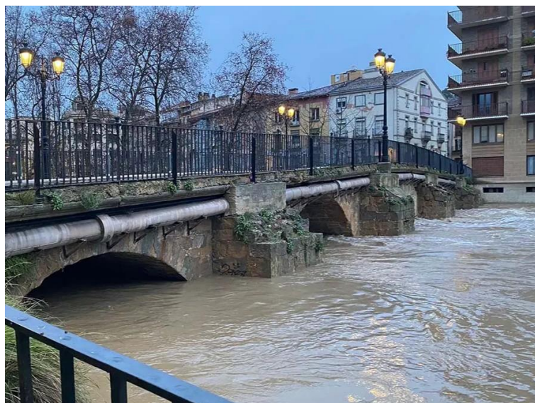
Imagen 19. Crecida Río Ega anegando salida de colectores
