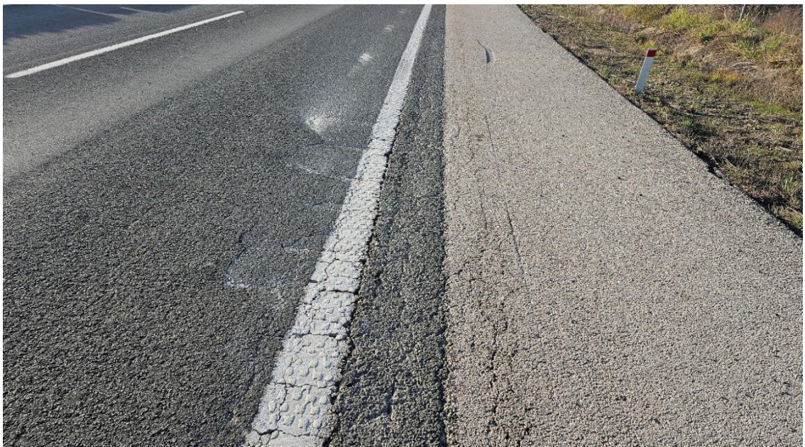
Estado del firme en el pk 73+000.
