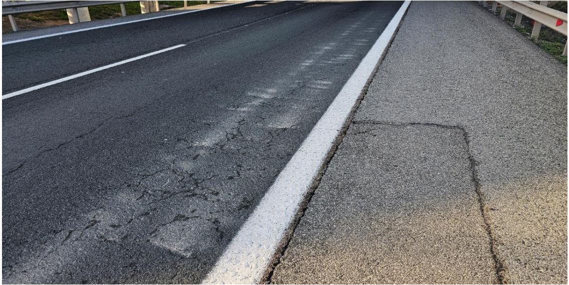
Estado del firme en el pk 74+500.
