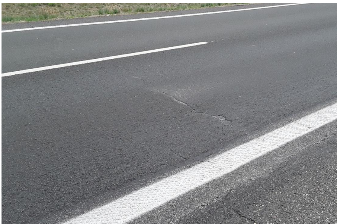
Estado firme tramo pk 25-19 Sur.
