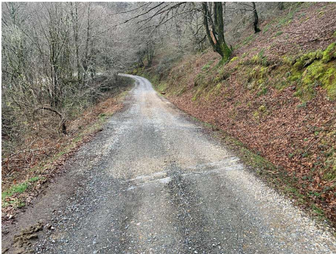
FOTOGRAFÍA 5: Vista general del camino, cortes de agua a eliminar. (Tramo 1)
