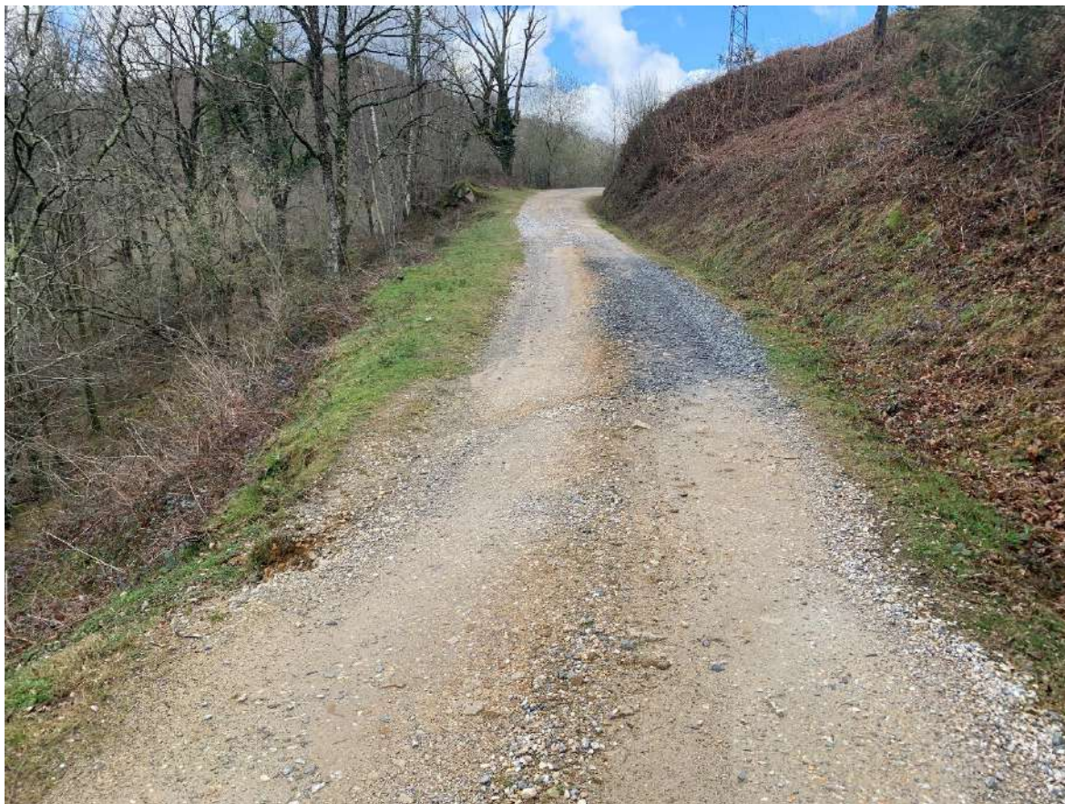
FOTOGRAFÍA 9: Vista general del camino, roderas. (Tramo 2)
