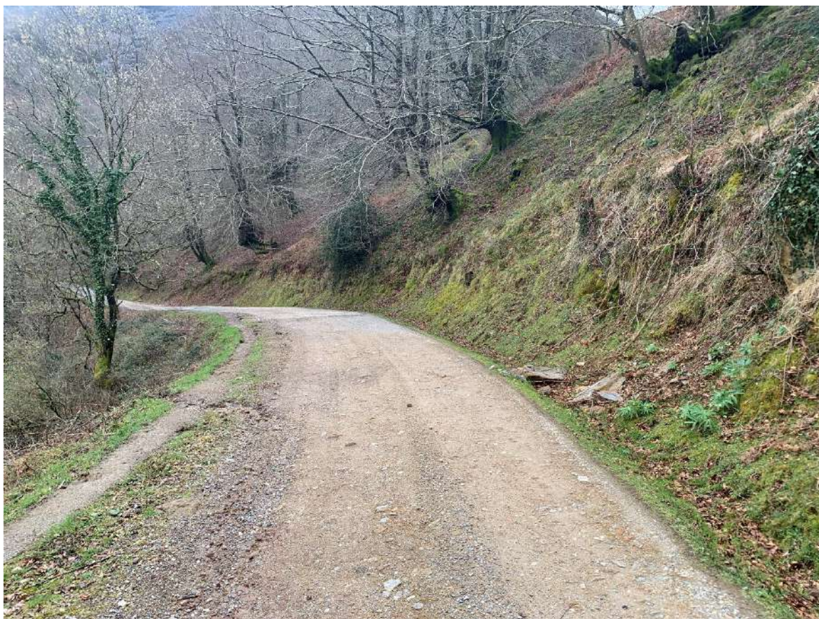
FOTOGRAFÍA 4: Vista general del camino, pequeño desprendimiento. (Tramo 1)
