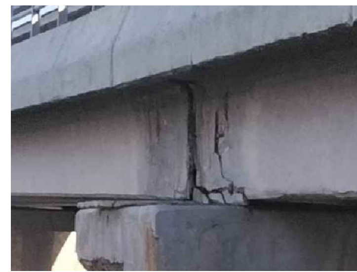
SITUACIÓN ACTUAL DE VIGAS
