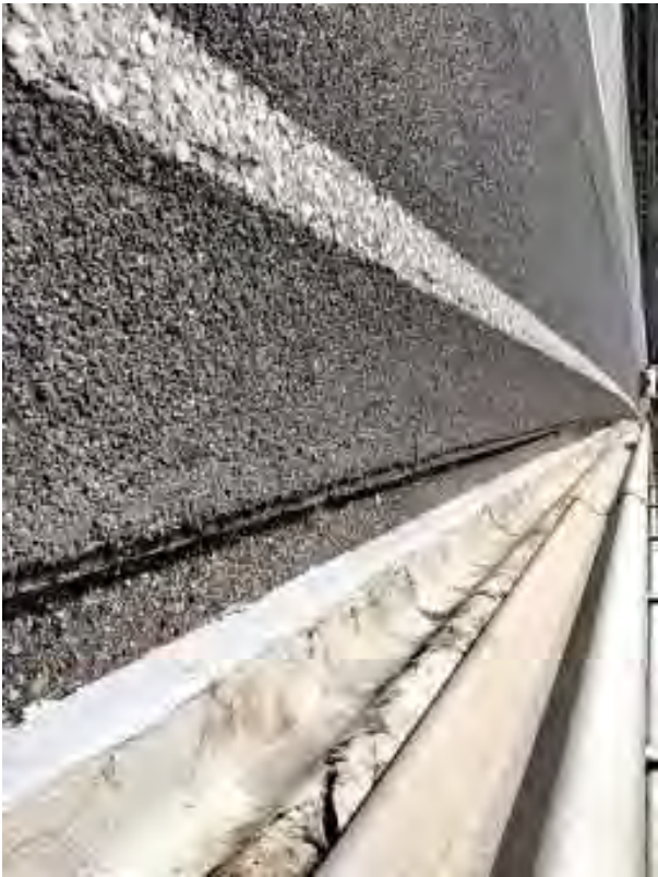
Foto 12 Sistema de drenaje arcén izquierdo sucio
