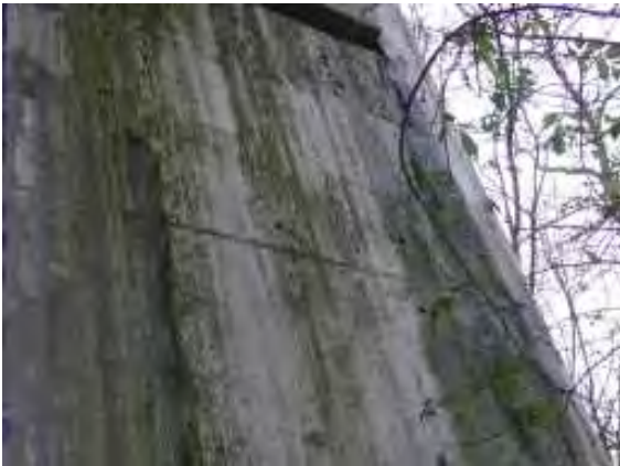
08 Humedad y deslavado en E2
