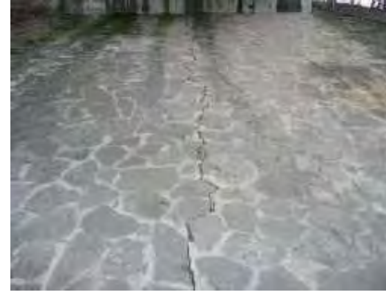
17 Revestimiento en talud de E1 fisurado
