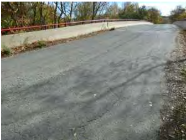
251104 Asiento en la losa de transición
