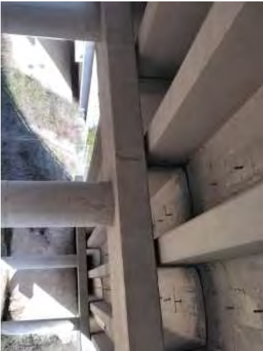
Foto 22 cabeza de viga sobre pila1
