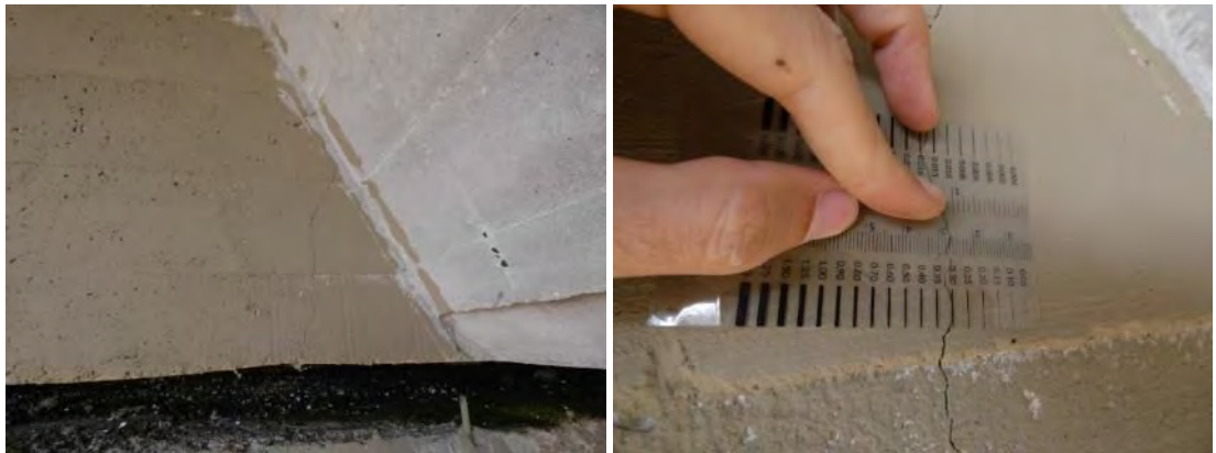
Figura 24. Fisuras en el diafragma ubicado en estribo
