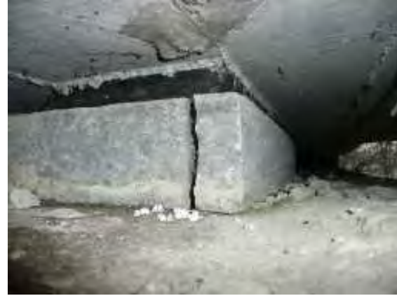
12 Cama de apoyo fisurada en apoyo central E1
