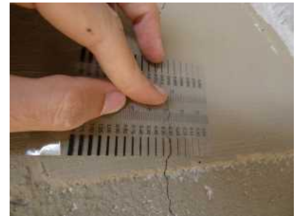
251104 Fisuras diagonales (Estribo 2)
