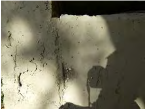
251104 Armaduras oxidadas ( Estribo 2 )
