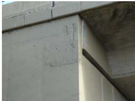
251104 Desprendimiento del recubrimiento ( Estribo 2 izquierda)
