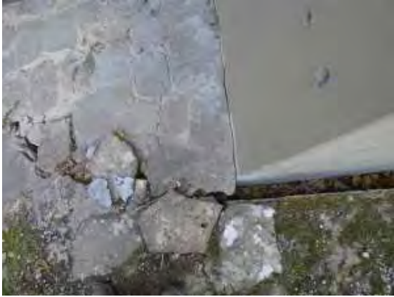
251104 Fisuración en revestimiento de talud de E1
