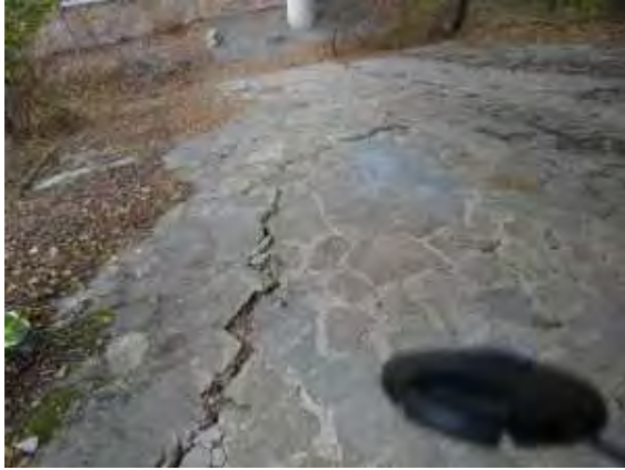
251104 Fisuración en revestimiento de talud de E1
