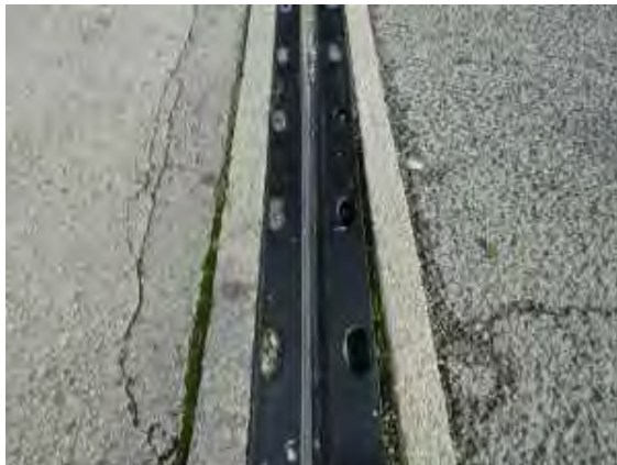
251104 Cubre juntas roto, permeable o inexistente ( Estribo 2)
