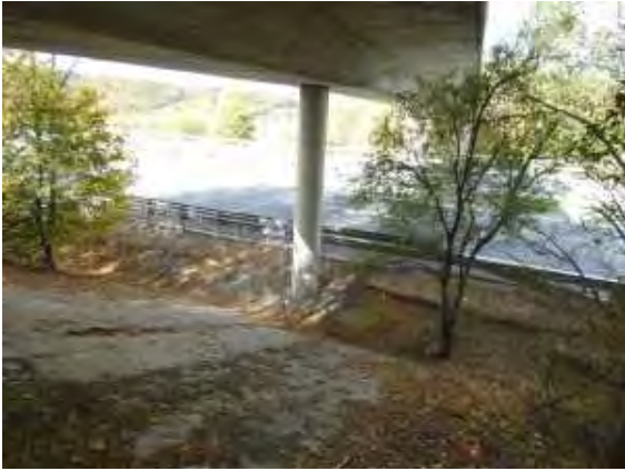
251104 Fisuración en revestimiento de talud de E1
