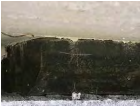
251104 Daños en los apoyos de neopreno ( Estribo 2 derecha)
