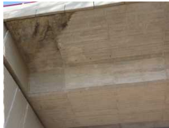
251104 Manchas de humedad activas
