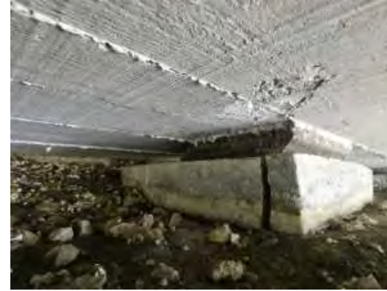
251104 Daños en los apoyos de neopreno ( Estribo 1 centro)
