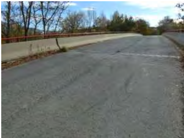
251104 Asiento en la losa de transición
