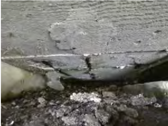
251104 Armaduras oxidadas ( Estribo 1 )
