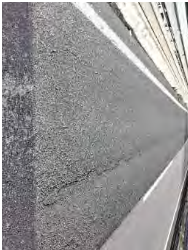
Foto 3 Estado del pavimento
