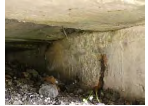
251104 Armaduras oxidadas ( Estribo 2 )
