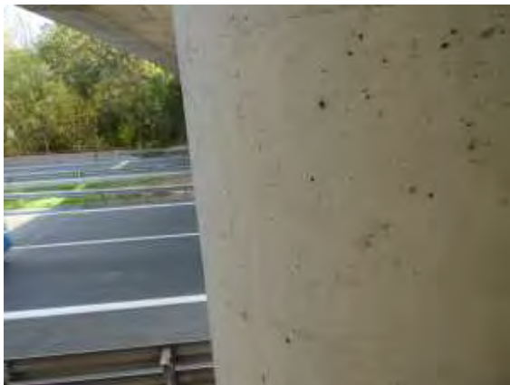
251104 Fisuras horizontales( Pila 2)
