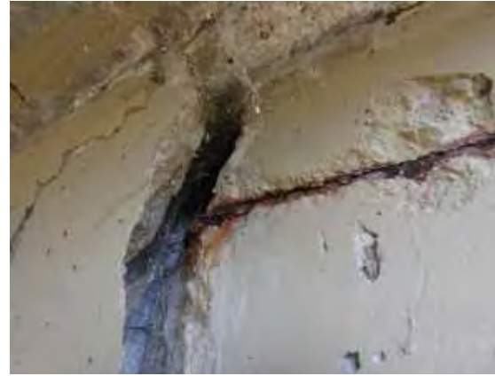
251104 Armaduras oxidadas ( Estribo 2 )
