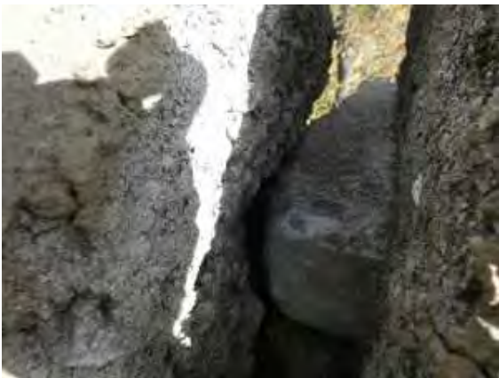
251104 Daños en valle, paramento o barandilla
