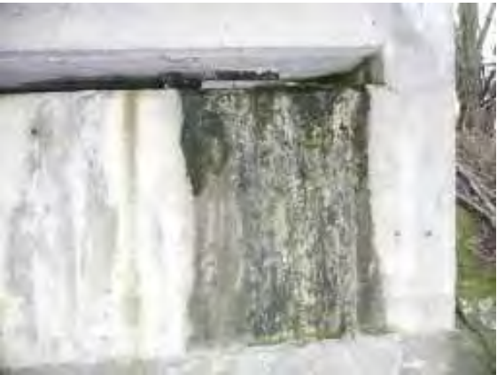
07 Manchas de humedad en E1
