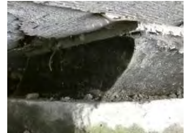
251104 Daños en los apoyos de neopreno ( Estribo 1 derecha)
