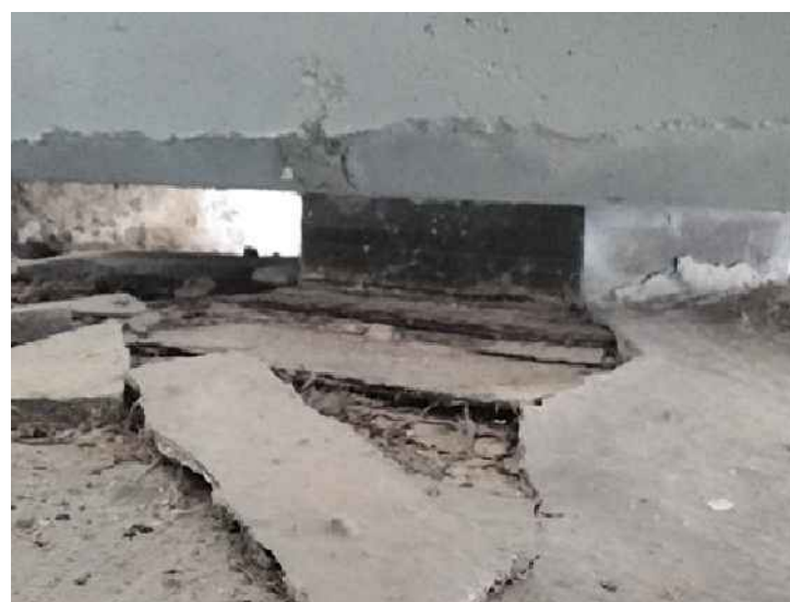
SITUACIÓN ACTUAL DE APOYOS
