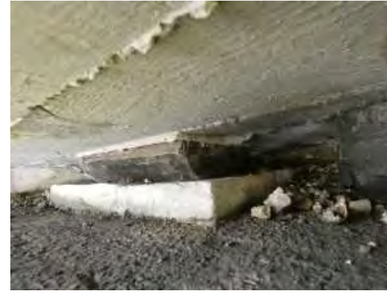
251104 Daños en los apoyos de neopreno ( Estribo 1 derecha)
