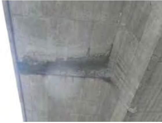
23 Humedad en tablero
