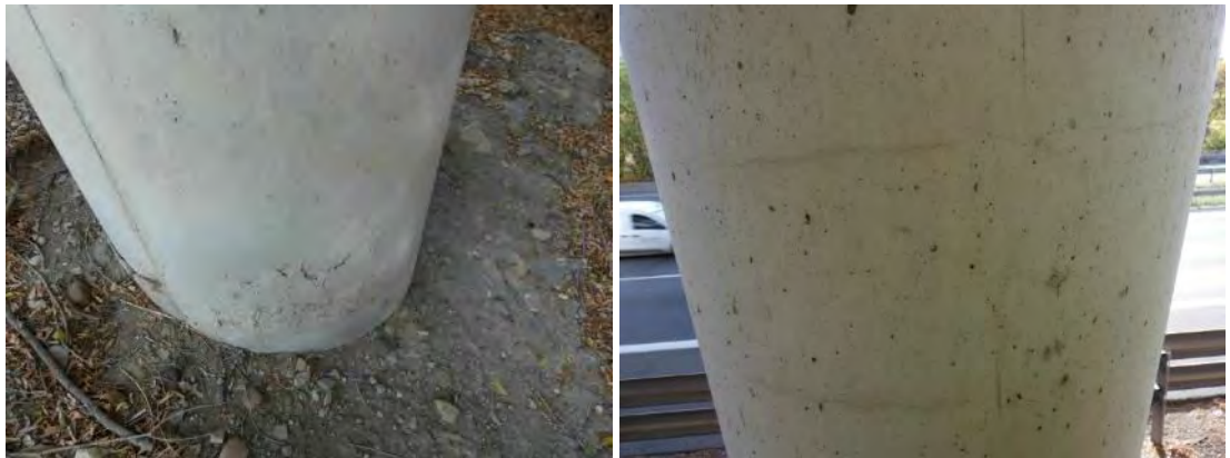
Figura 22. Desprendimiento del recubrimiento en la base de las pilas y fisuras horizontales en pilas
