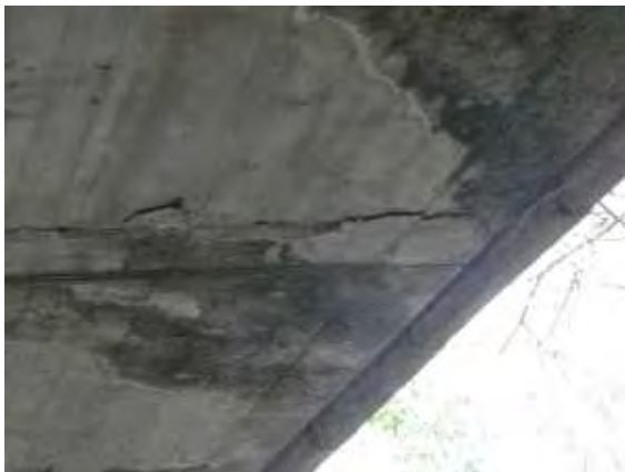
251104 Desprendimiento del recubrimiento
