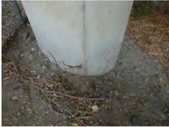
251104 Desprendimiento del recubrimiento ( Pila 1)
