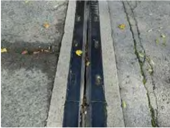
251104 Cubre juntas roto, permeable o inexistente ( Estribo 1))
