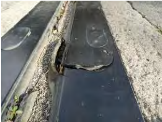
251104 Cubre juntas roto, permeable o inexistente ( Estribo 1))
