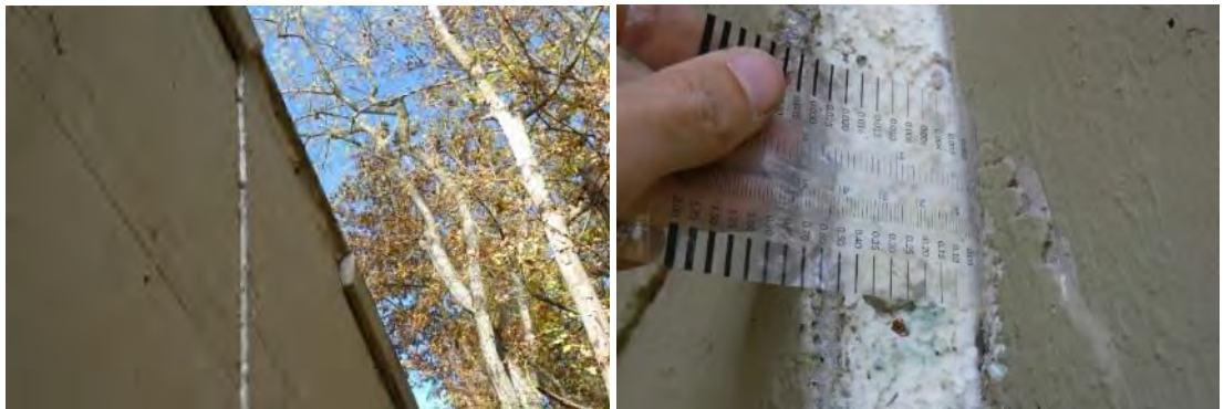
Figura 17. Pérdida de verticalidad en el estribo 1, alrededor de 4 cm
