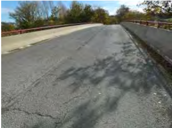
251104 Fisuras y anomalías en el pavimento
