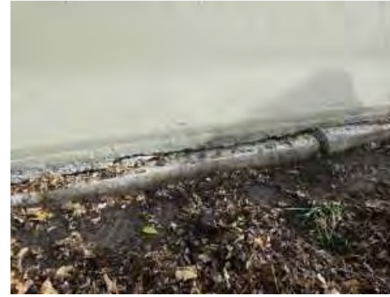
251104 Daños en valle, paramento o barandilla
