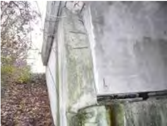
11 Murete lateral del E1 daado (lado derecho)
