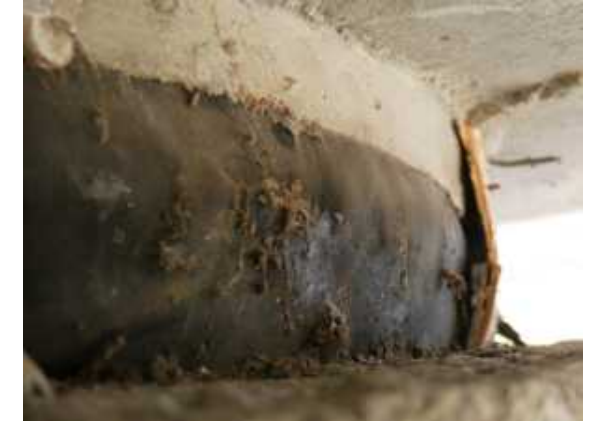
251104 Daños en los apoyos de neopreno
