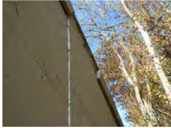
251104 Desplome, pérdida de verticalidad ( Estribo 2 derecha)
