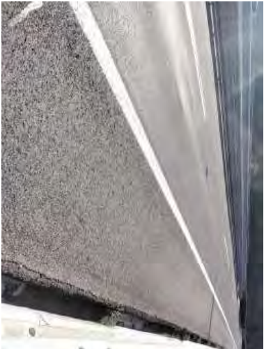
Foto 4 Estado del pavimento
