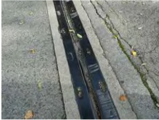
251104 Cubre juntas roto, permeable o inexistente ( Estribo 1))
