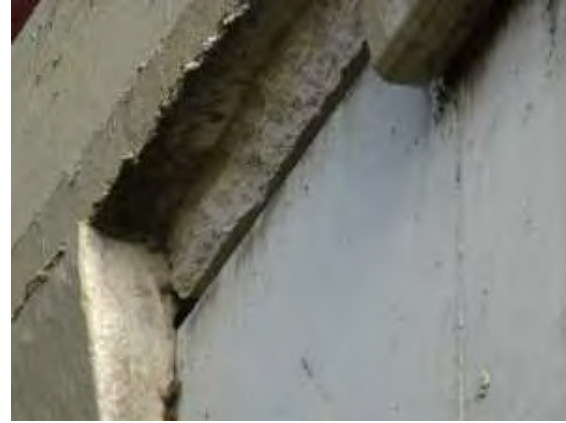
251104 Imposta deteriorada ( Estribo 2 izquierda)
