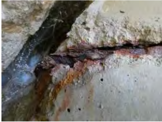
251104 Armaduras oxidadas ( Estribo 2 )
