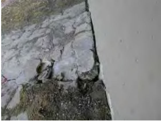
251104 Fisuración en revestimiento de talud de E1
