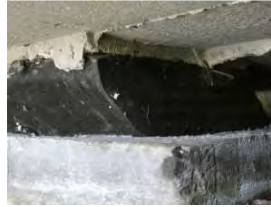
251104 Daños en los apoyos de neopreno ( Estribo 1 izquierda)
