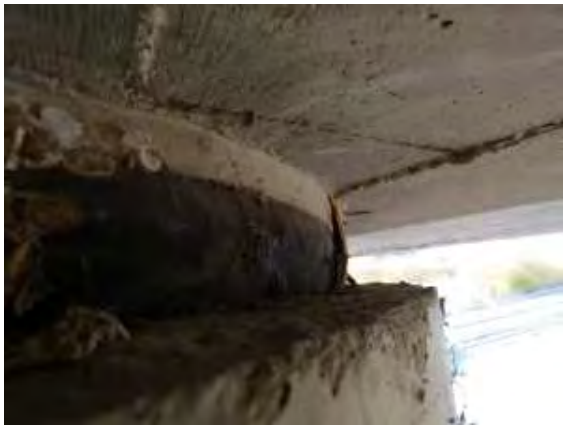
251104 Daños en los apoyos de neopreno
