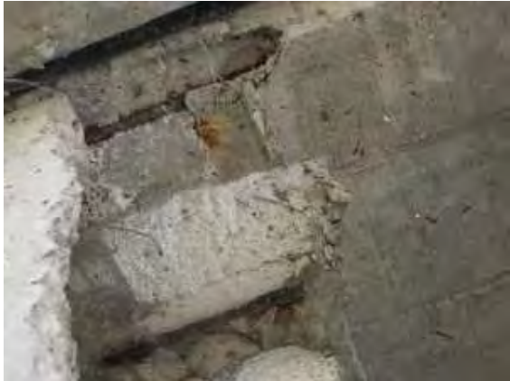
251104 Armaduras oxidadas ( Estribo 1 )
