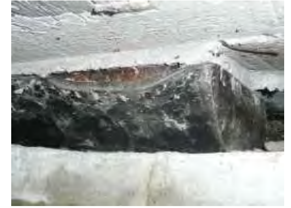
14 Detalle neopreno dañado en aparato de apoyo E1 (lado derecho)
