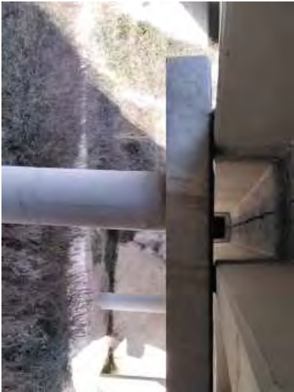
Foto 32 apoyo de viga de borde sobre Pila 1 deteriorado
