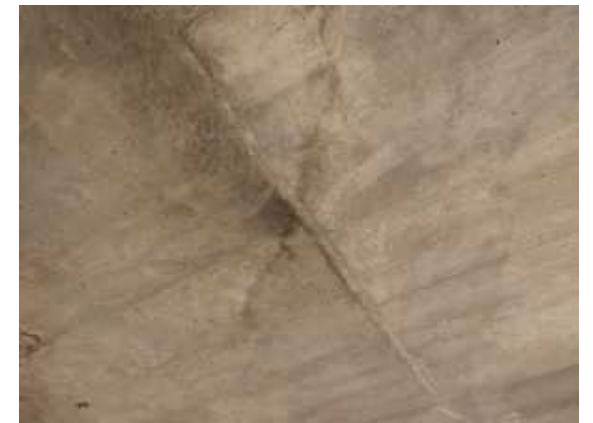
251104 Fisuras diagonales (Estribo 2)
