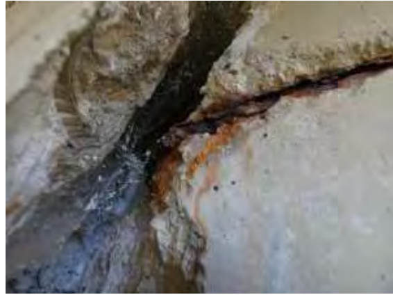
251104 Armaduras oxidadas ( Estribo 2 )
