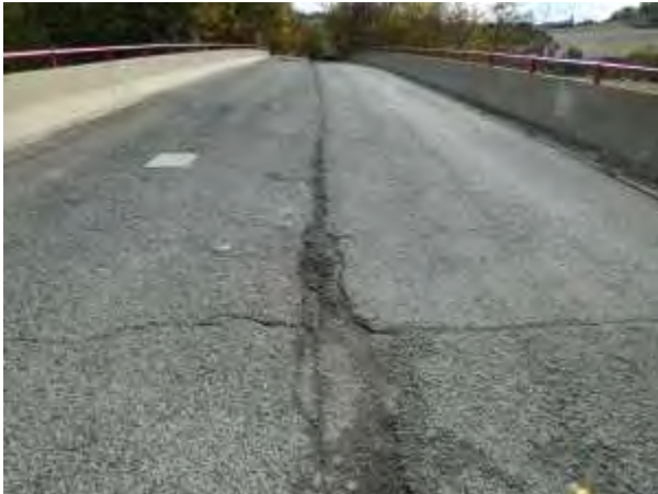
251104 Baches en el pavimento
