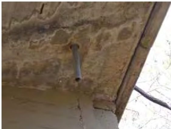
251104 Tubo de desagüe dañado
