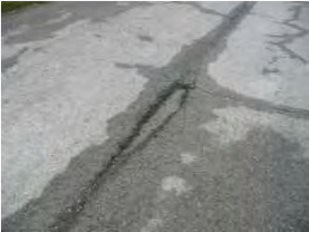
29 Bache en calzada
