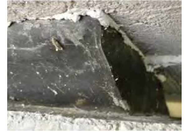
251104 Daños en los apoyos de neopreno ( Estribo 2 centro)
