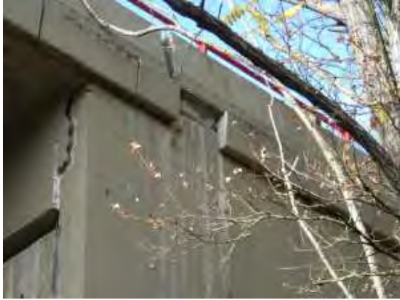
251104 Imposta deteriorada ( Estribo 2 derecha)
