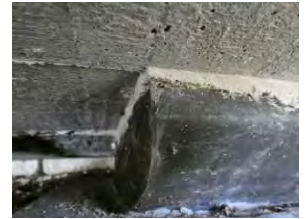
251104 Daños en los apoyos de neopreno ( Estribo 1 izquierda)
