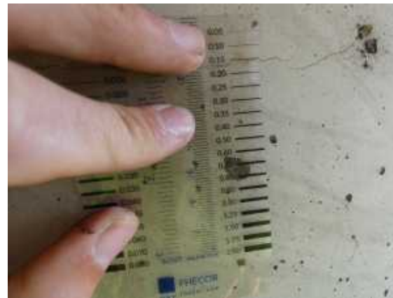
251104 Fisuras horizontales( Pila 2)
