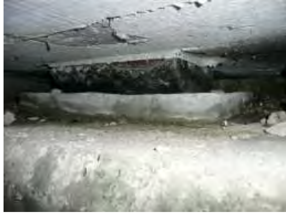
13 Neopreno dañado en aparato de apoyo E1 (lado derecho)
