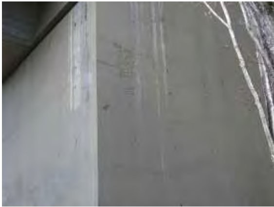
251104 Hormigón deslavado/deteriorado ( Estribo 2 derecha)
