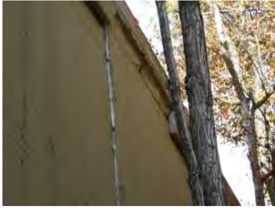
251104 Desplome, pérdida de verticalidad ( Estribo 2 derecha)
