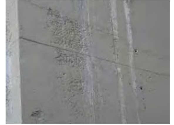
251104 Hormigón deslavado/deteriorado ( Estribo 2 derecha)
