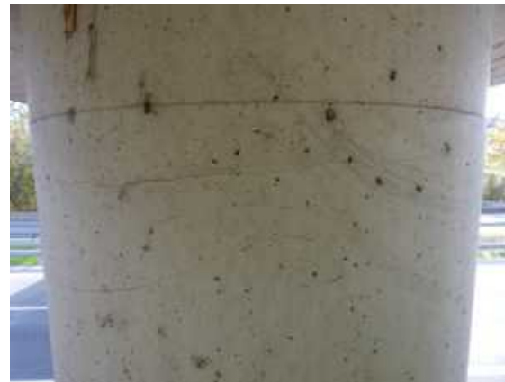
251104 Fisuras horizontales( Pila 2)
