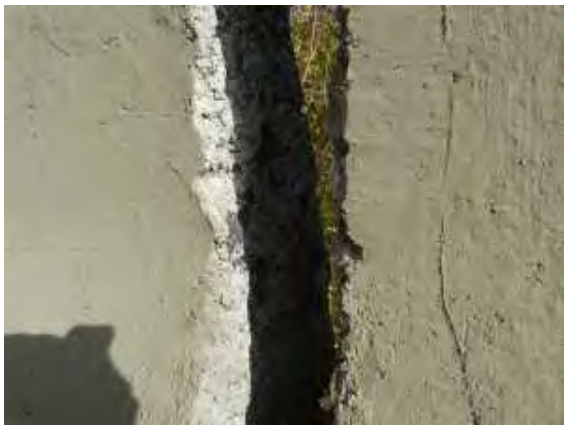
251104 Daños en valle, paramento o barandilla
