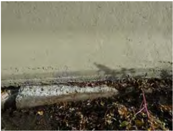
251104 Daños en valle, paramento o barandilla
