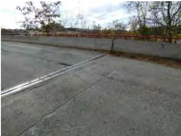
251104 Asiento en la losa de transición
