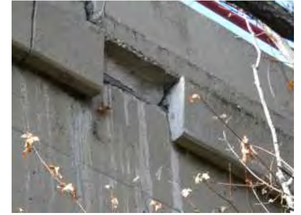
251104 Imposta deteriorada ( Estribo 2 derecha)
