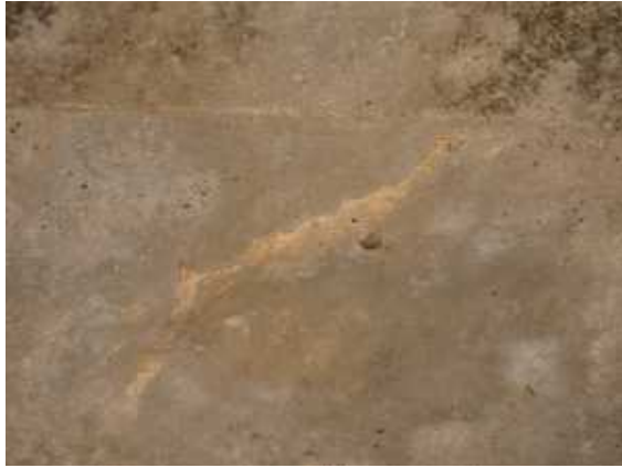
251104 Fisuras diagonales (Estribo 2)
