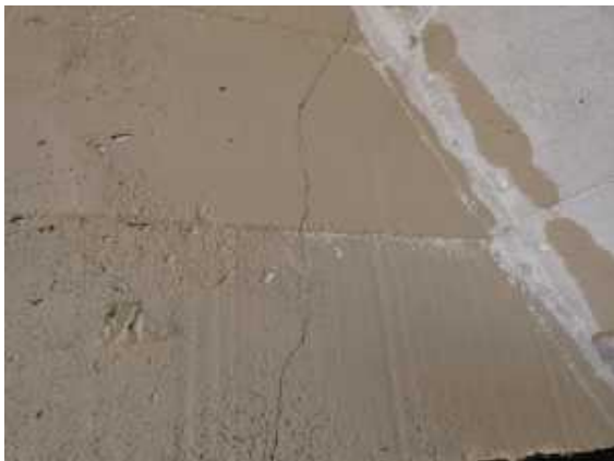
251104 Fisuras diagonales (Estribo 2)
