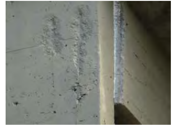
251104 Desprendimiento del recubrimiento ( Estribo 2 izquierda)
