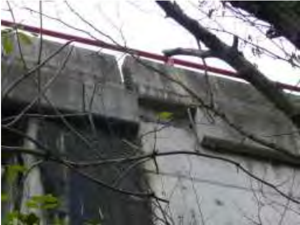
31 Imposta dañada en E2
