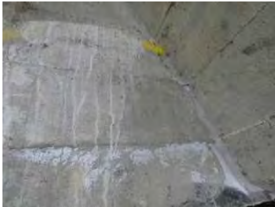
251104 Fisuras diagonales (Estribo 1)
