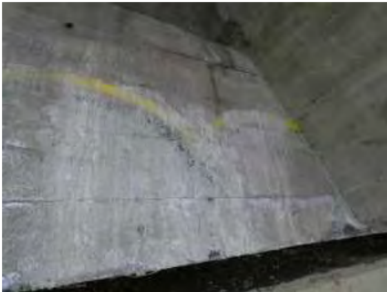
251104 Fisuras diagonales (Estribo 1)
