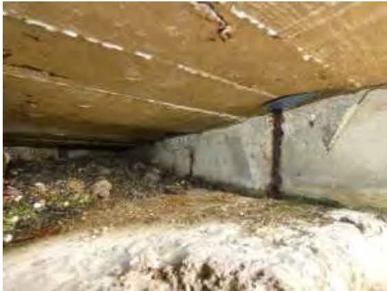
251104 Armaduras oxidadas ( Estribo 2 )
