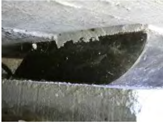
251104 Daños en los apoyos de neopreno ( Estribo 1 izquierda)
