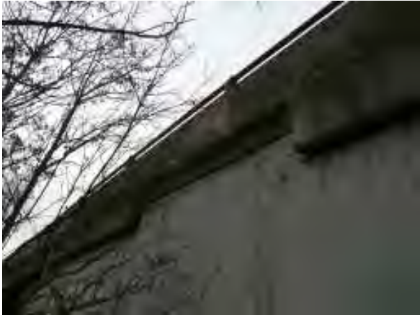
32 Imposta dañado en muro lateral E2
