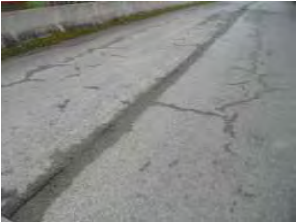
28 Fisuras en calzada
