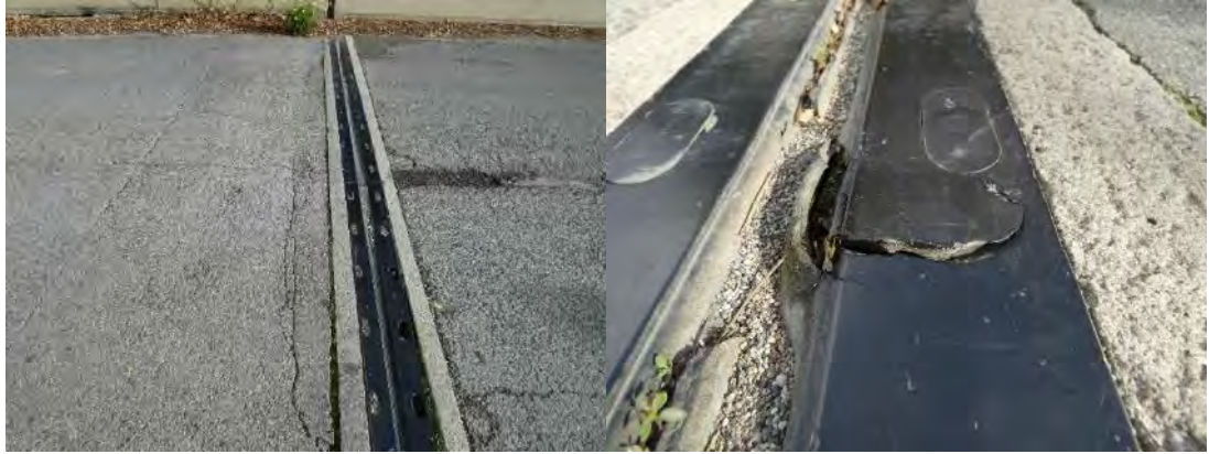
Figura 27. Perfiles de junta rotos
