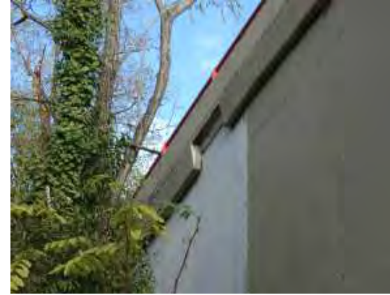
251104 Imposta deteriorada ( Estribo 2 izquierda)
