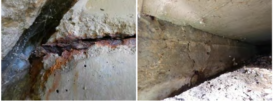
Figura 16. Armadura oxidada y desconchones con corrosión de armaduras en estribos
