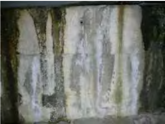
09 Eflorescencias en E1
