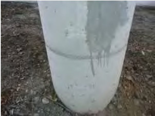
20 Rozaduras en P2
