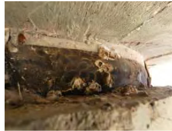
251104 Daños en los apoyos de neopreno
