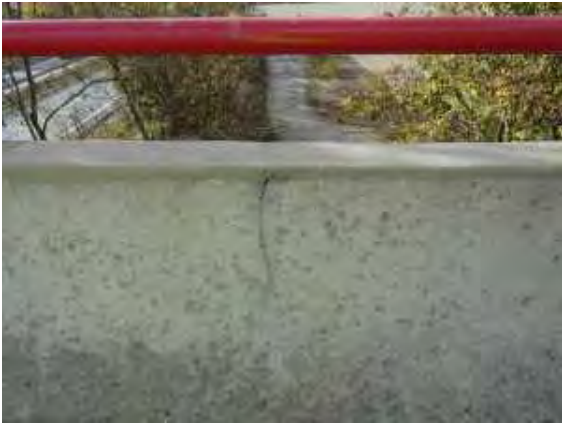
251104 Daños en valle, paramento o barandilla
