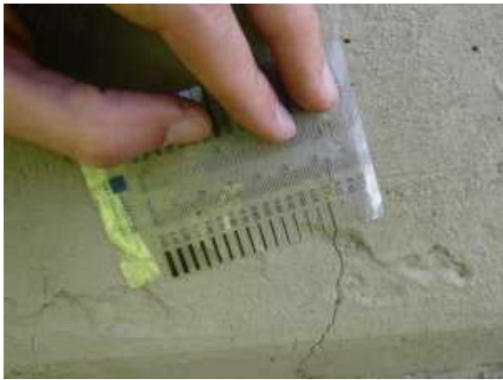
251104 Daños en valle, paramento o barandilla
