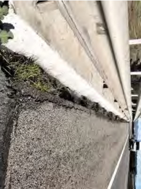
Foto 13 Sistema de drenaje arcén derecho sucio
