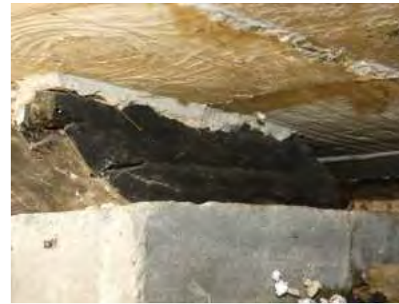
251104 Daños en los apoyos de neopreno ( Estribo 2 izquierda)
