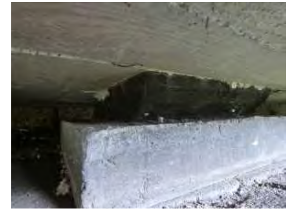
251104 Daños en los apoyos de neopreno ( Estribo 2 derecha)
