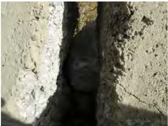
251104 Daños en valle, paramento o barandilla
