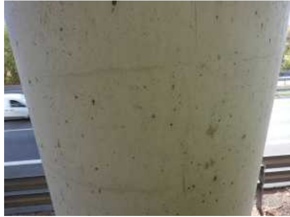
251104 Fisuras horizontales( Pila 2)
