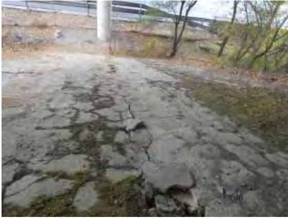
251104 Fisuración en revestimiento de talud de E1
