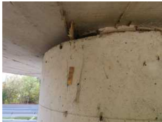
251104 Fisuras horizontales( Pila 2)
