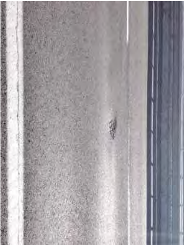
Foto 3 bache en carril derecho
