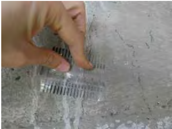
251104 Fisuras diagonales (Estribo 1)
