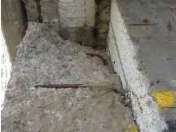
251104 Armaduras oxidadas ( Estribo 1 )
