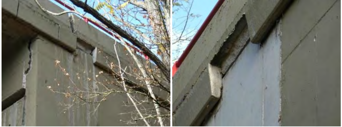
Figura 18. Deterioro en la imposta
