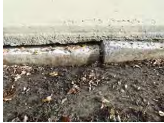
251104 Daños en valle, paramento o barandilla
