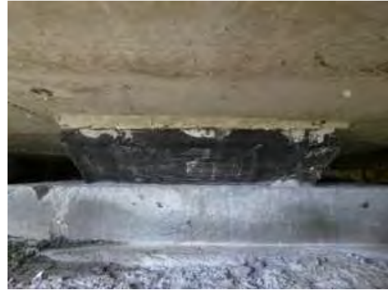
251104 Daños en los apoyos de neopreno ( Estribo 2 izquierda)
