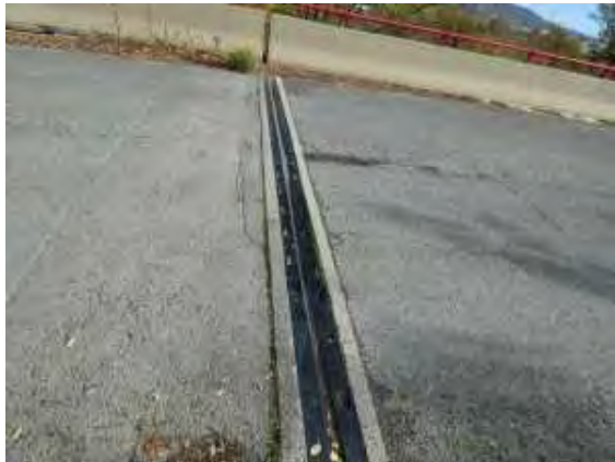
251104 Cubre juntas roto, permeable o inexistente ( Estribo 2)
