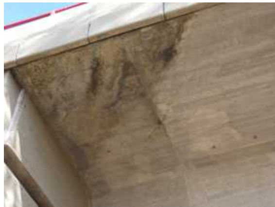
251104 Manchas de humedad activas
