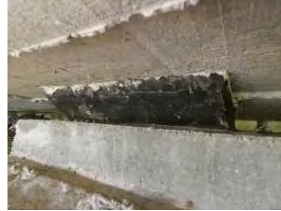
251104 Daños en los apoyos de neopreno ( Estribo 2 centro)
