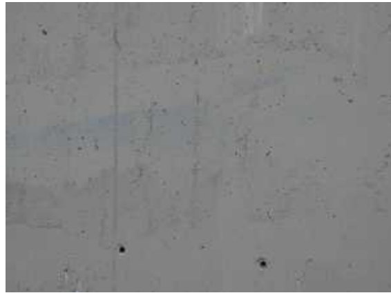
251104 Hormigón deslavado/deteriorado ( Estribo 2 )
