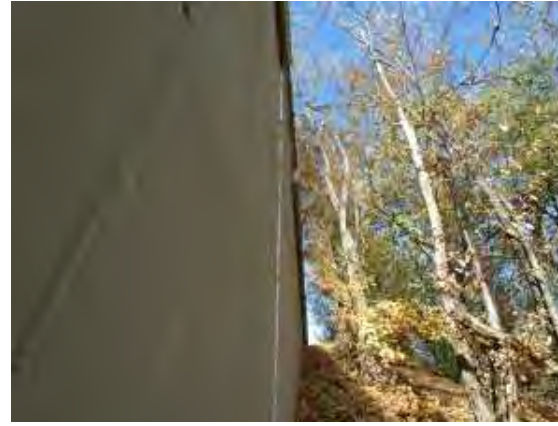
251104 Desplome, pérdida de verticalidad ( Estribo 2 derecha)
