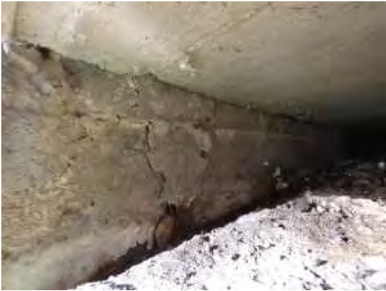
251104 Armaduras oxidadas ( Estribo 2 )
