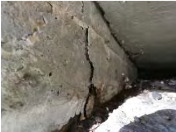
251104 Armaduras oxidadas ( Estribo 2 )
