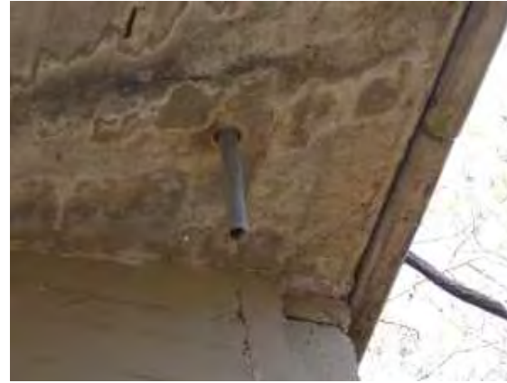
251104 Manchas de humedad activas
