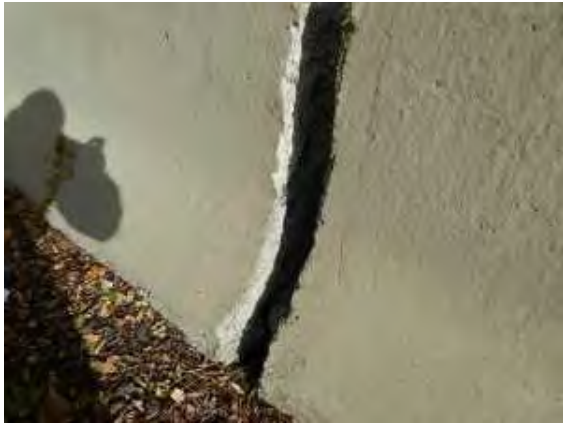
251104 Daños en valle, paramento o barandilla
