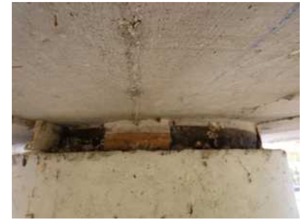
251104 Daños en los apoyos de neopreno
