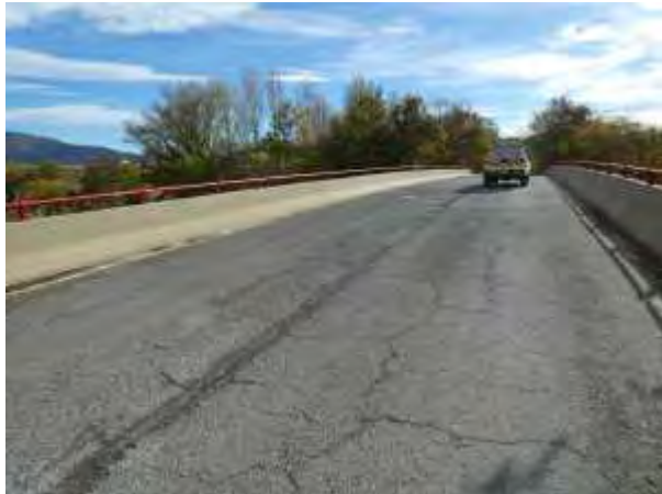
251104 Fisuras y anomalías en el pavimento
