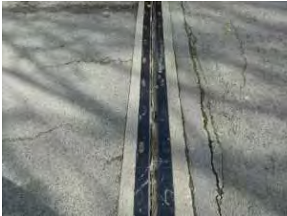
251104 Cubre juntas roto, permeable o inexistente ( Estribo 1))
