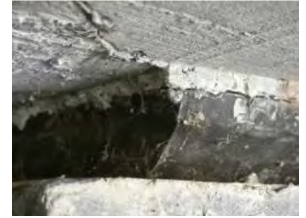
251104 Daños en los apoyos de neopreno ( Estribo 1 centro)
