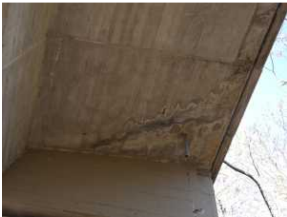
251104 Manchas de humedad activas
