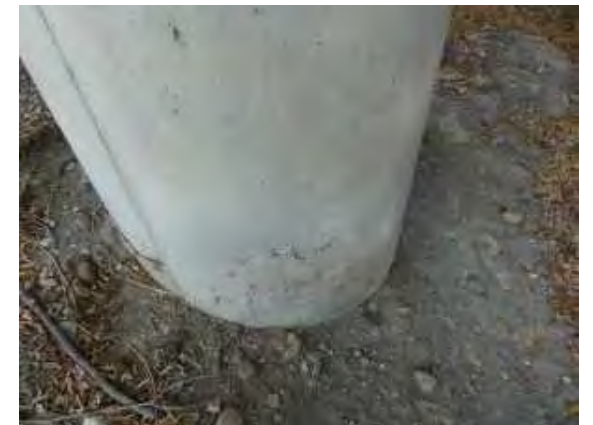
251104 Desprendimiento del recubrimiento ( Pila 1)
