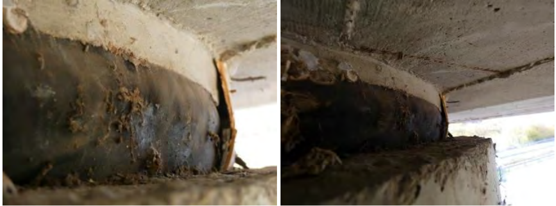
Figura 21. Daño moderado en apoyos sobre pila
