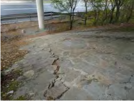
251104 Fisuración en revestimiento de talud de E1
