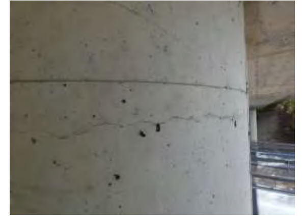
251104 Fisuras horizontales( Pila 2)
