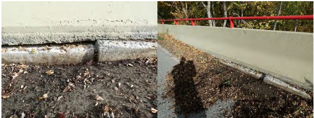
Figura 26. Movimientos del terreno asociados a descensos en la losa de transición y desplomes de los muros en vuelta del estribo 1
