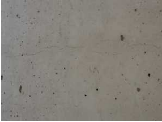
251104 Fisuras horizontales( Pila 2)
