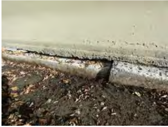
251104 Daños en valle, paramento o barandilla
