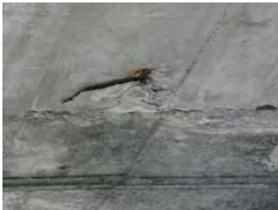
251104 Desprendimiento del recubrimiento
