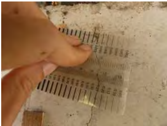
251104 Fisuras horizontales( Pila 2)
