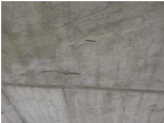
251104 Desprendimiento del recubrimiento
