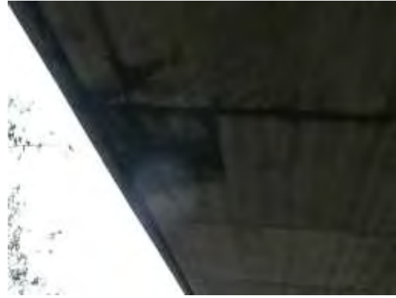
22 Humedad en tablero
