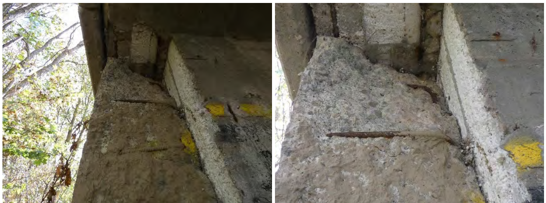
Figura 20. Rotura en el tape lateral derecho del estribo 2
