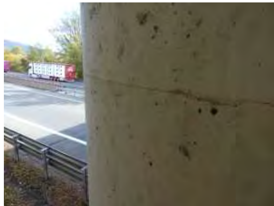
251104 Fisuras horizontales( Pila 2)
