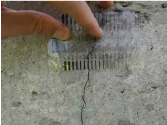
251104 Daños en valle, paramento o barandilla
