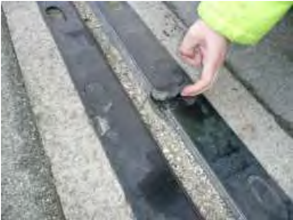
26 Cubrejuntas dañado en E1
