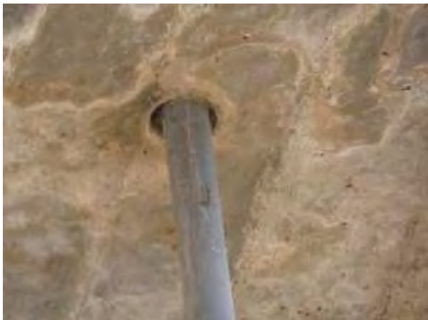
251104 Tubo de desagüe dañado
