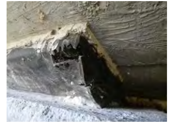
251104 Daños en los apoyos de neopreno ( Estribo 2 izquierda)
