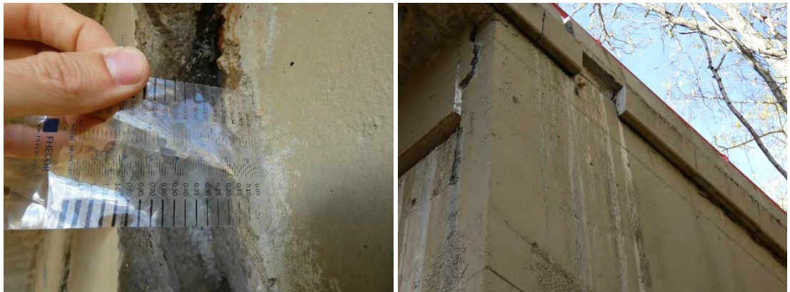
Figura 19. Rotura en el tape lateral izquierdo del estribo 1
