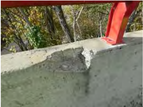
251104 Daños en valle, paramento o barandilla
