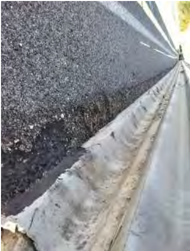
Foto 9 pretil curvo izquierdo deteriorado
