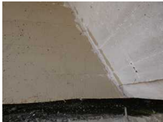
251104 Fisuras diagonales (Estribo 2)
