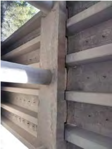
Foto 34 Losa en juntas
