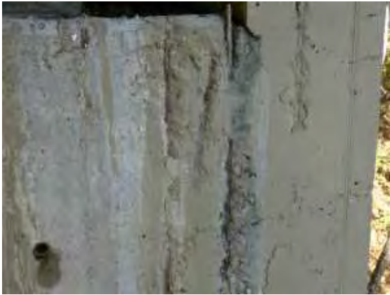
251104 Armaduras oxidadas ( Estribo 2 )
