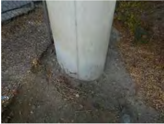
251104 Desprendimiento del recubrimiento ( Pila 1)
