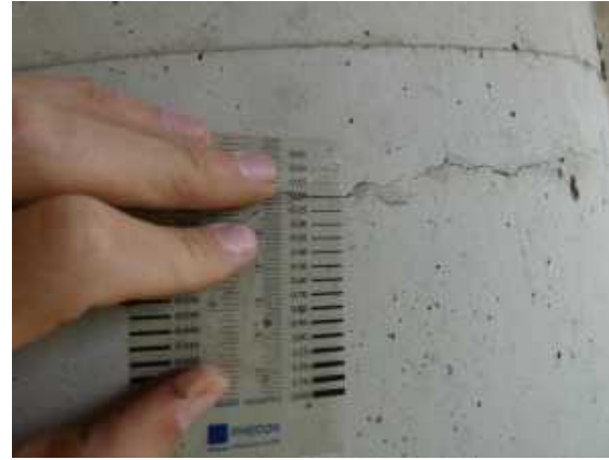
251104 Fisuras horizontales( Pila 2)
