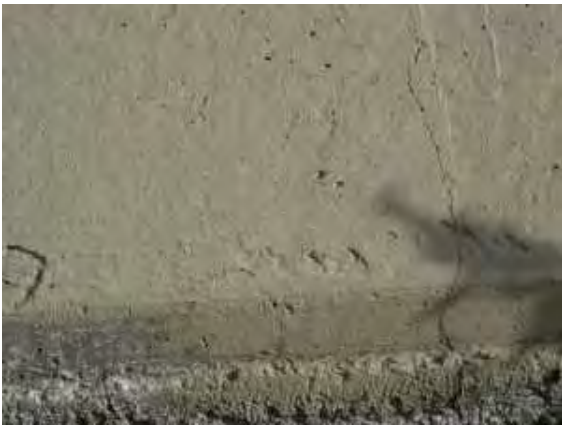
251104 Daños en valle, paramento o barandilla
