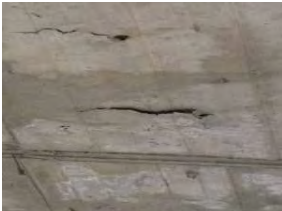
251104 Desprendimiento del recubrimiento
