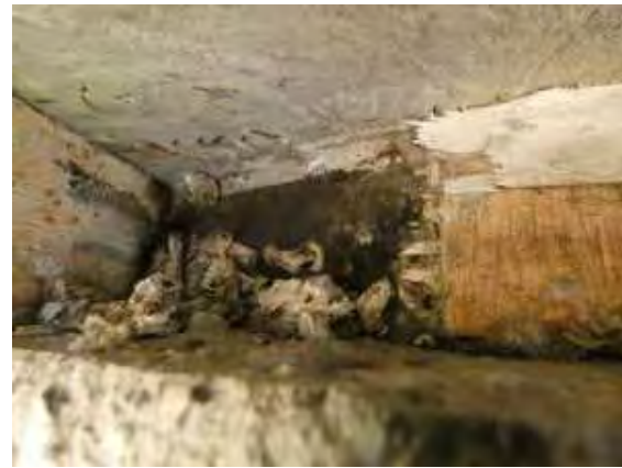
251104 Daños en los apoyos de neopreno
