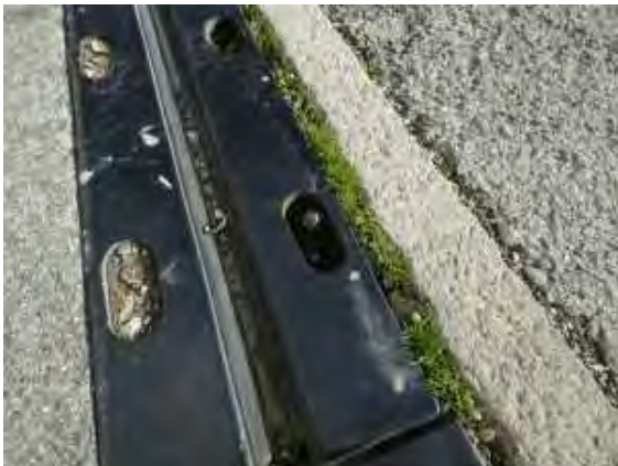
251104 Cubre juntas roto, permeable o inexistente ( Estribo 2)
