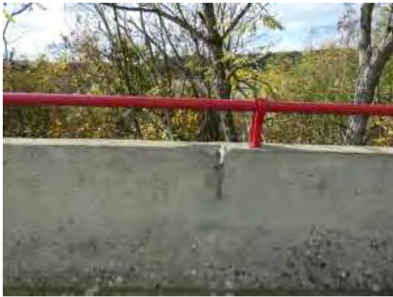
251104 Daños en valle, paramento o barandilla
