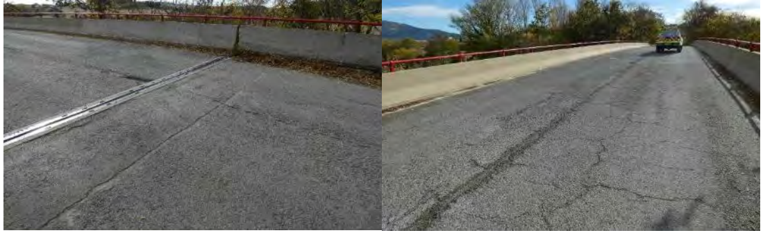
Figura 25. Deterioro en la pavimentación
