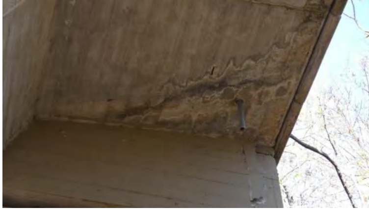
Figura 23. Humedades en la cara inferior del tablero, junto a estribo
