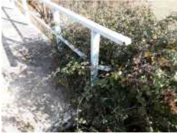
leve corrosión y deformación
