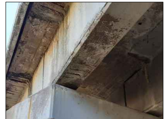
SITUACIÓN ACTUAL VIGAS DE BORDE
