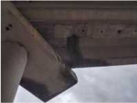
Foto 34 humedad en Losa drenes cortos
