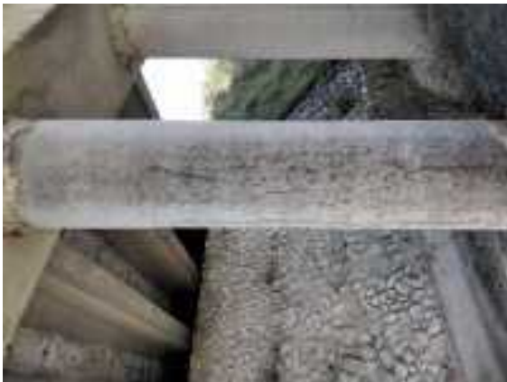
Foto 13 fisuras en pila norte
