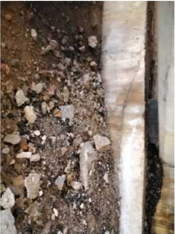
Foto 35 fisura en estribo norte
