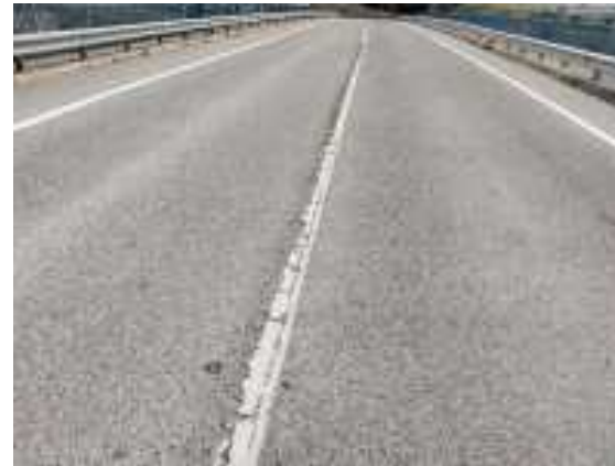
Fotos 7 Estado del pavimento.
