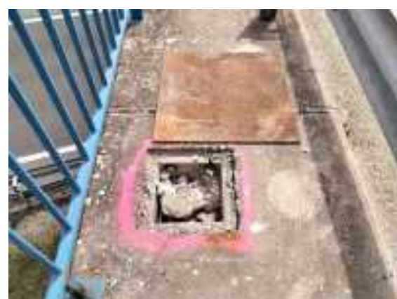
Foto 1 Arqueta en acera rota.
