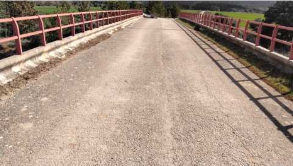
Foto 6 Estado del pavimento
