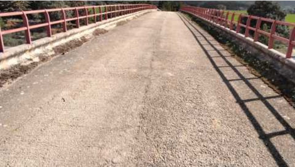
Foto 5 Estado del pavimento.
