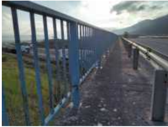
Foto 4 barandilla para reparar y pintar
