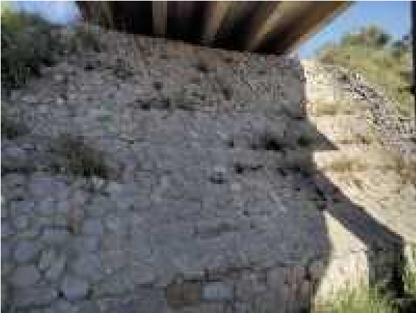
Foto 20 Fisura transversal en encachado de estribo 2
