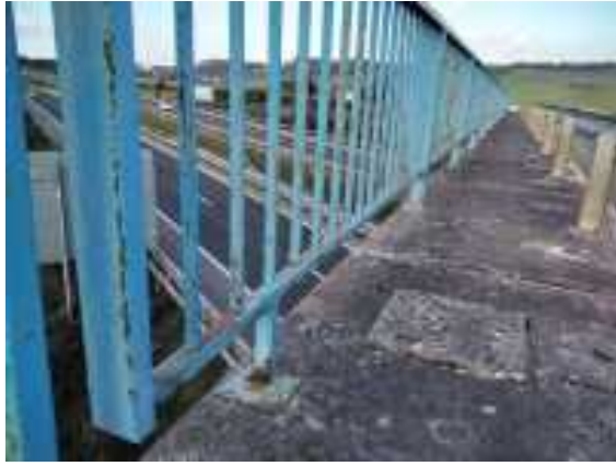
Fotos 6 barandilla para reparar y pintar
