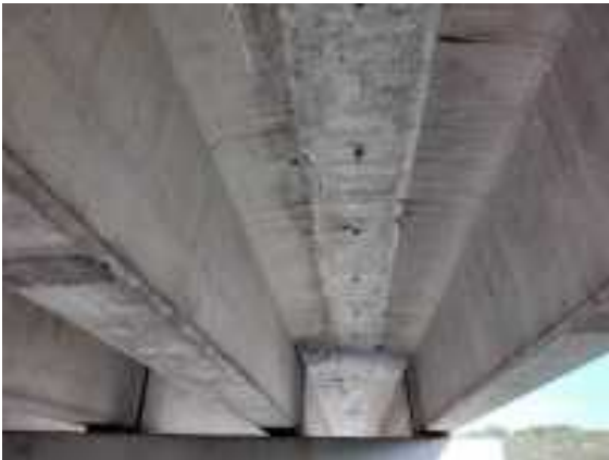
Foto 10 drenes en losa cortos
