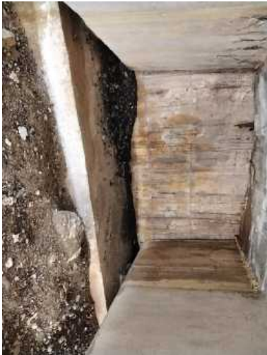
Foto 32 humedad activa en estribo norte
