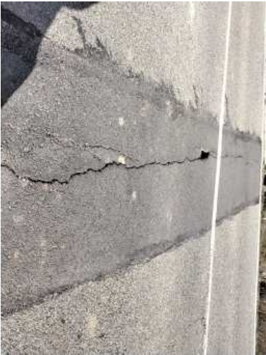
Foto 9 Junta sobre estribo norte
