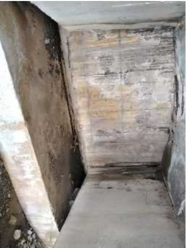
Foto 31 humedad activa en estribo norte
