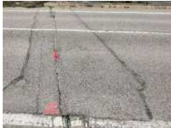
Foto 6 Estado del pavimento.
