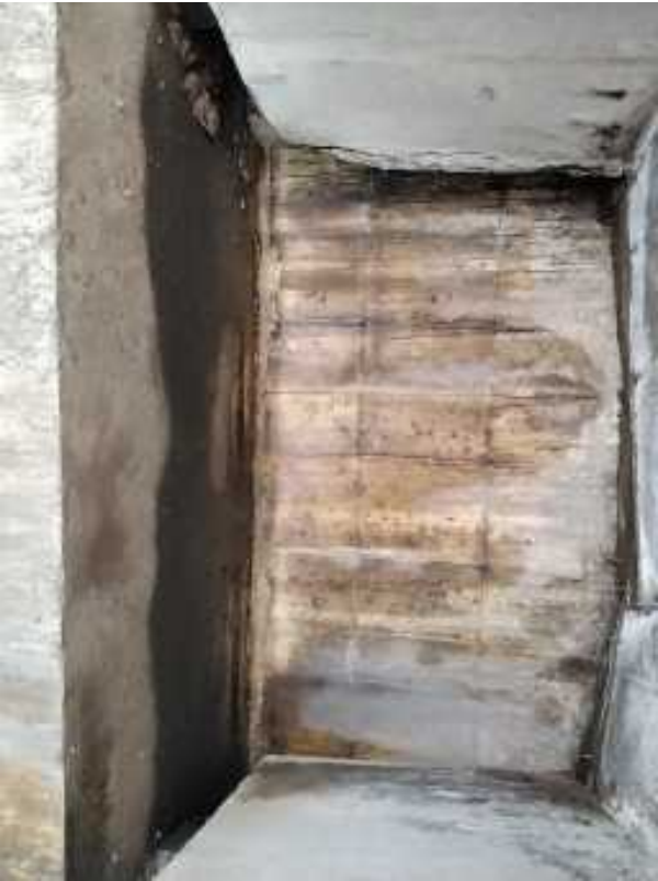
Foto 16 humedad activa en estribo sur
