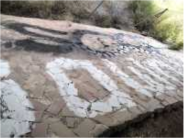
Foto 41 fisura transversal en encachado estribo 2
