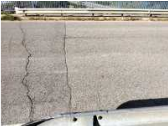
Foto 3 fisuras en pavimento
