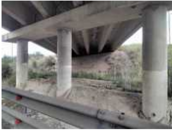
Foto 26 fisuras verticales en fuste de pila sur
