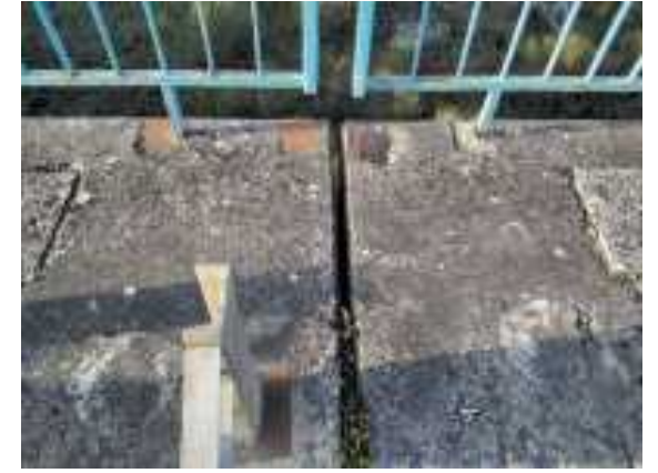
Foto 2 Separación de acera con humedad en dintel
