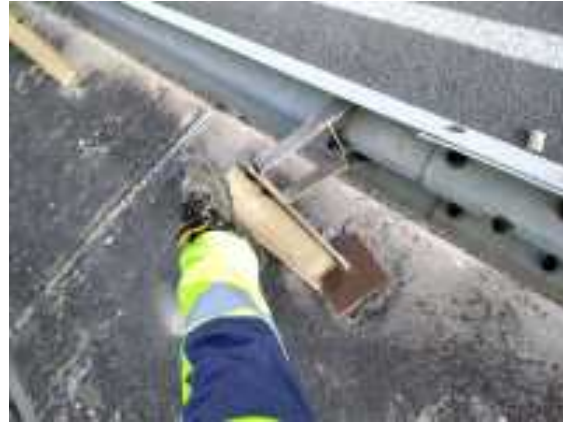
Foto 10 base de bionda y poste sueltos.
