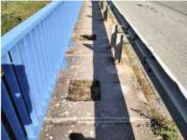
Foto 1 acera deteriorada con filtraciones de agua en arquetas
