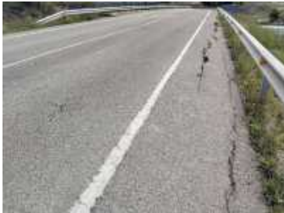
Foto 44 Grietas en pavimento antes de entrar en estructura.
