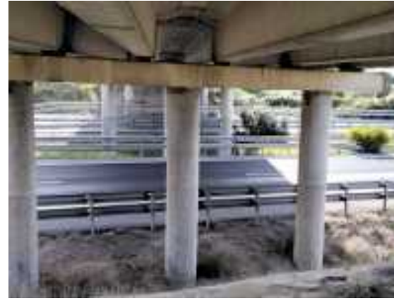
Foto 42 fisuras en pila de sur
