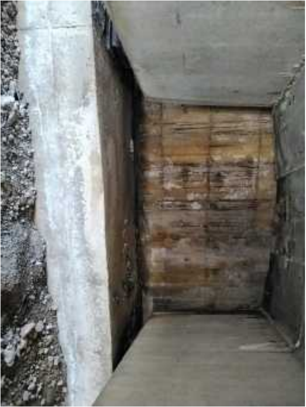
Foto 30 humedad activa en estribo de norte
