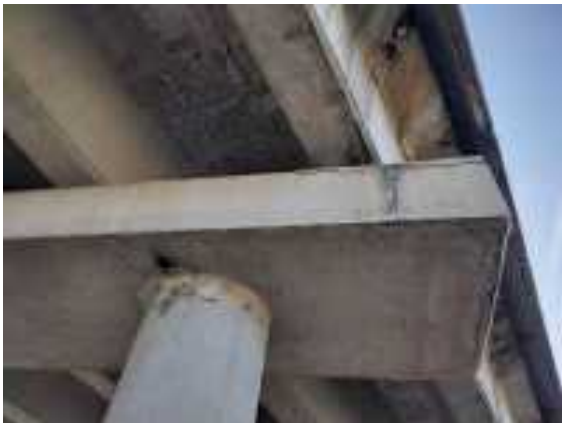
Foto 12 fisura en dintel norte
