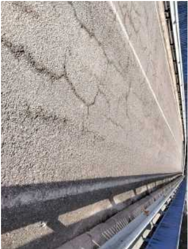
Foto 7 Estado del pavimento
