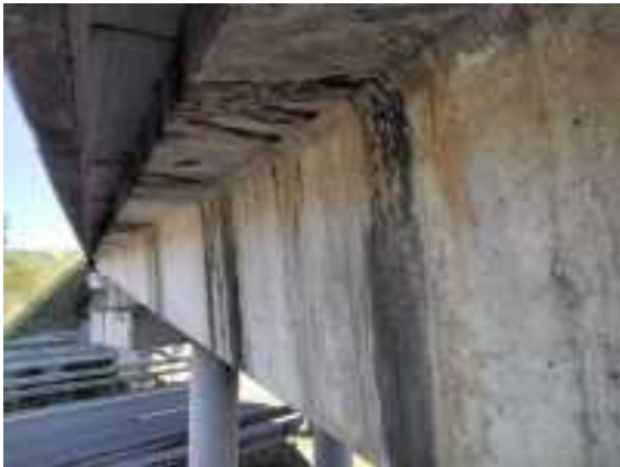
Fotos 7 humedad activa en viga de borde
