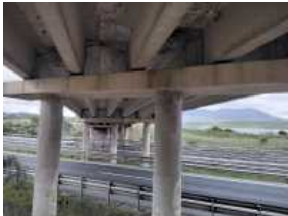
Foto 40 cabezas de vigas sobre dintel 1
