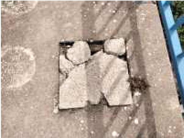
Foto 4 Arquetas en acera en mal estado.
