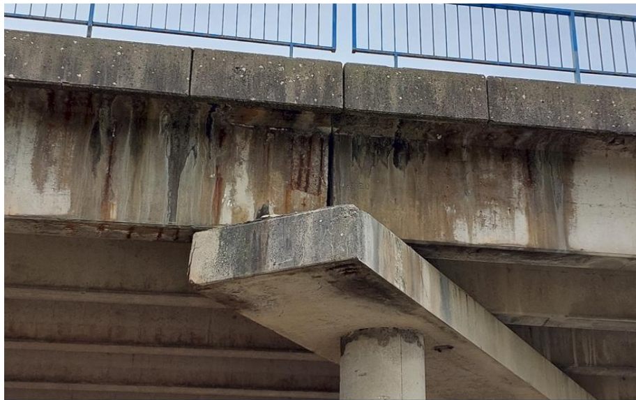
Daños en viga de borde y extremos cargaderos del paso superior pk 74+400
