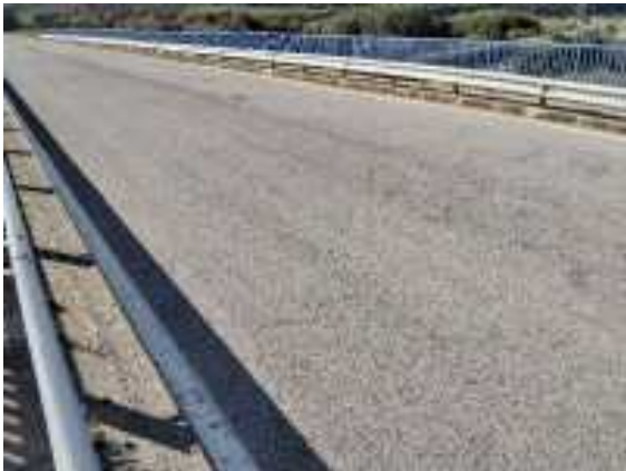
Foto 4 fisuras en pavimento
