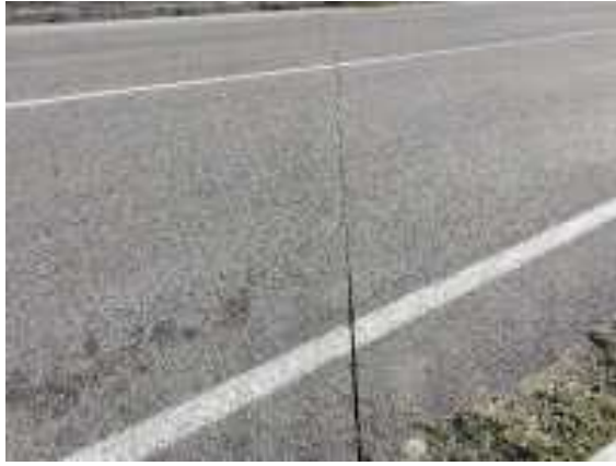
Foto 11 grietas cerca de junta 1.
