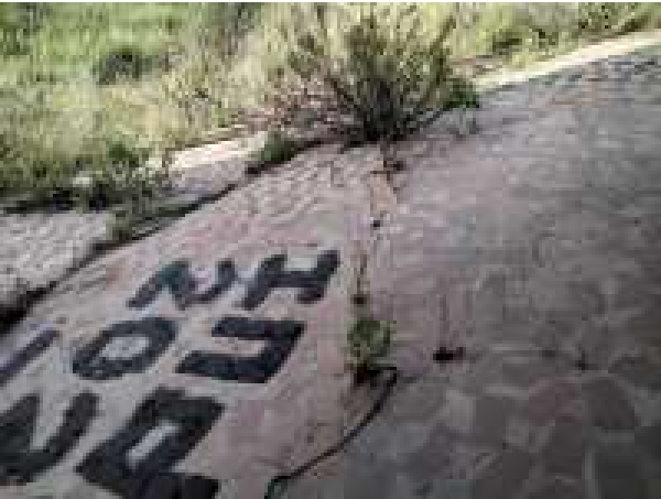
Foto 14 encachado estribo 2 con fisuras
