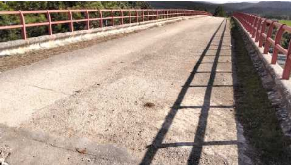
Foto 4 Estado del pavimento.
