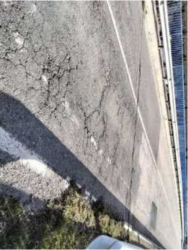
Foto 6 Estado del pavimento
