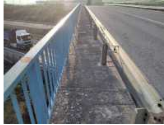
Foto 1 Acera deteriorada con pequeños desconches.
