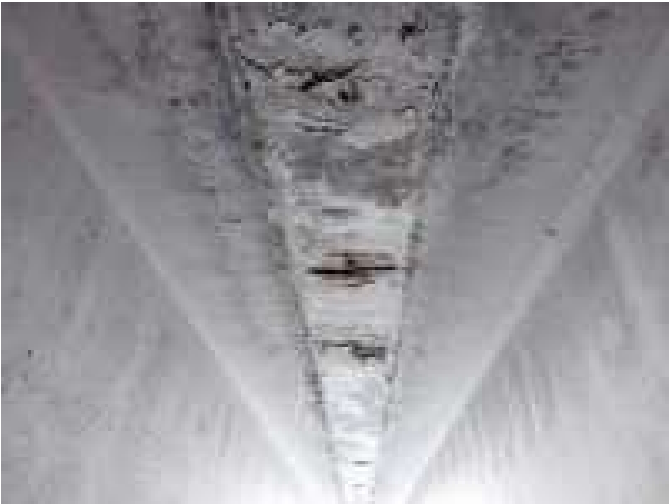
Foto 37 drenes de losa cortos provocando humedades y desconchones
