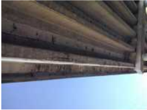
Foto 30 viga de borde de vano sur muy deteriorada
