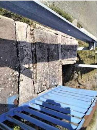
Foto 3 arqueta de conducciones deteriorada
