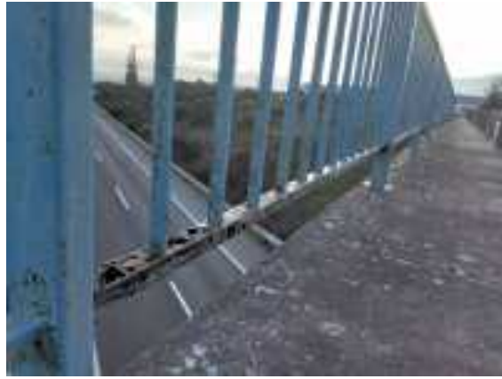
Foto 5 barandilla para reparar y pintar
