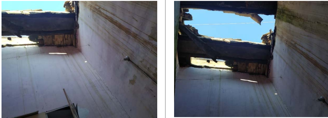
Estado interior del edificio Lechuga 35, donde se observa el colapso parcial de parte de la cubierta.
