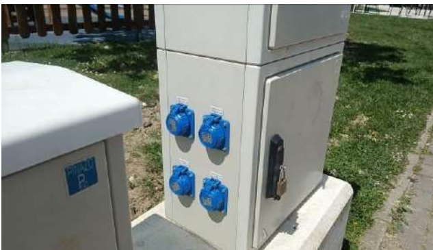
Foto 1: Bornes eléctricos para enchufes de bicis eléctricas
