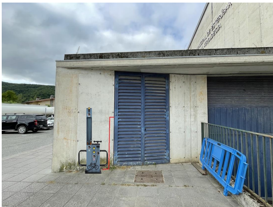
Salida de caja de cuadros eléctricos y conexión a estación de reparación-recarga
