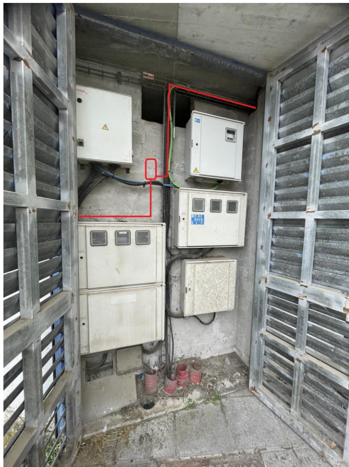
Llegada de acometida a caja exterior y conexión con caja estancia
