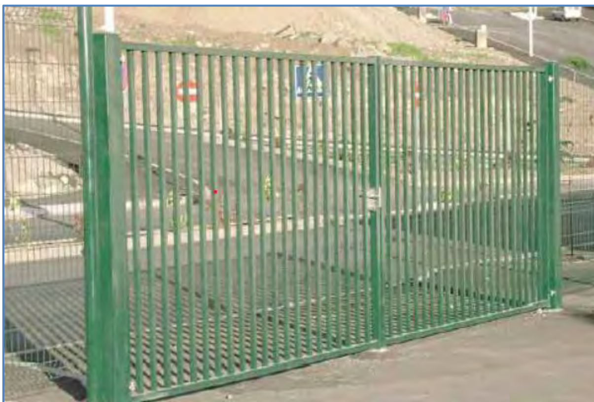
Figura nº 4: Detalle de puerta metálica control de acceso.
