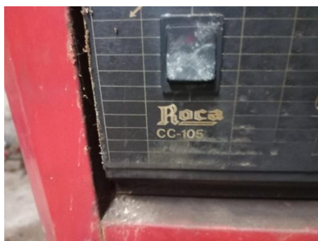
Imagen 2. Modelo caldera de gasoil
